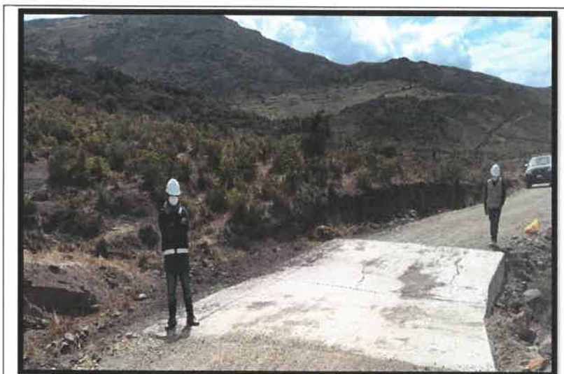
FIG 09. LIMPIEZA DE BADEM (17L 8.333477E 78.224169N) ALT. 3125.23M FECHA: 20/05/2021 ING. INSPECTOR Y RESIDENTE VERIFICANDO LOS TRABAJOS DE LIMPIEZA DE BADEM
