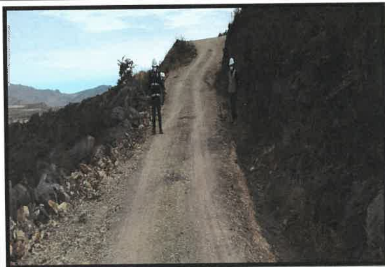
FIG. 01 COLOCACION DE MATERIAL PARA BACHEO (17L 8.383477E 78.224169N) ALT. 3941.00M FECHA: 06/05/2021 ING. INSPECTOR Y RESIDENTE VERIFICANDO LO TRABAJOS
