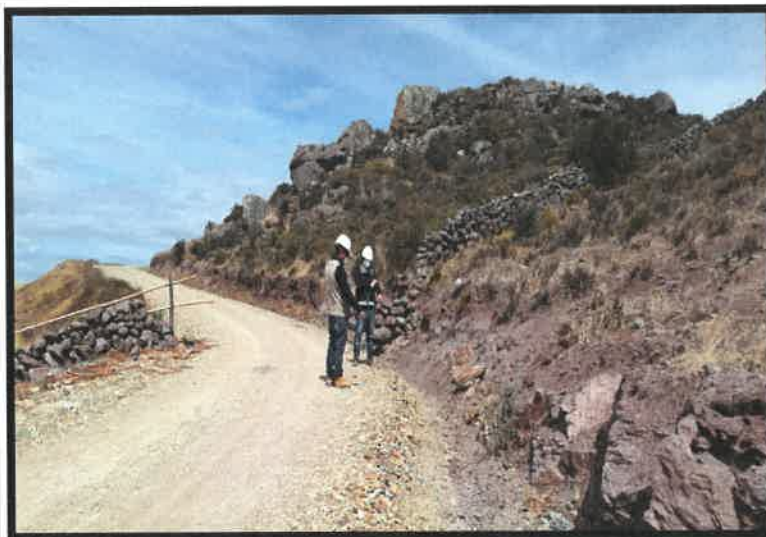
FIG 04. LIMPIEZA DE CUNETAS (17L 8.397215E 78.221753N) ALT. 3452.00M FECHA: 08/05/2021 ING. INSPECTOR Y RESIDENTE VERIFICANDO LOS TRABAJOS
