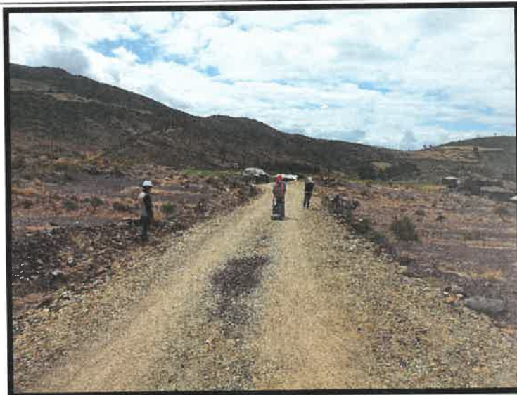
FIG. 02 BACHEO (17L 8.383477E 78.224169N) ALT. 3941.00M FECHA: 08/05/2021 ING. INSPECTOR Y RESIDENTE VERIFICANDO LOS TRABAJOS
