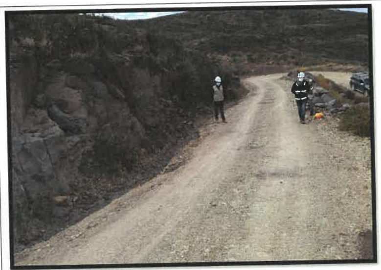
FIG 05. LIMPIEZA DE CUNETAS (17L 8.392991E 78.222998N) ALT. 3368.00M FECHA: 15/05/2021 ING. INSPECTOR Y RESIDENTE VERIFICANDO LOS TRABAJOS
