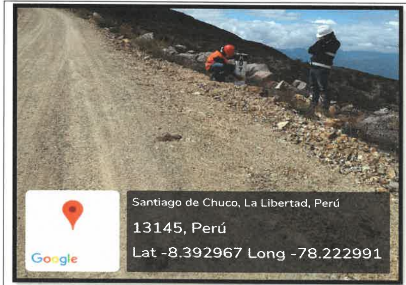
FIG 11. MANTENIMIENTO DE HITOS (17L 8.392967E 78.222991N) ALT. 3453.32M FECHA: 20/05/2021 ING. INSPECTOR VERIFICANDO LOS TRABAJOS DE LIMPIEZA DE PONTONES
