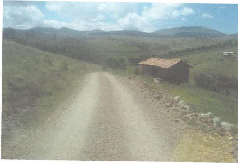
FOTOGRAFIA N° 04. SITUACION DEL CAMINO VECINAL, CON PRESENCIA DE MATERIAL DISGREGADO, PRODUCTO DEL DESGASTE(COORDENADAS N9072530 E 795019 )Fecha 22/04/2021
