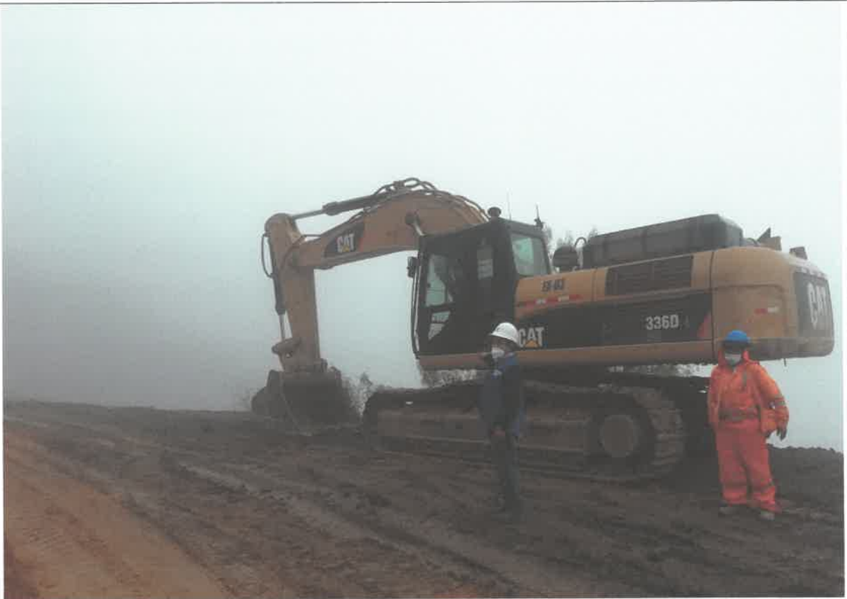
Inicio de trabajos en Cantera KM 21+150 para el transporte de material granular. 90888115N 812618E
