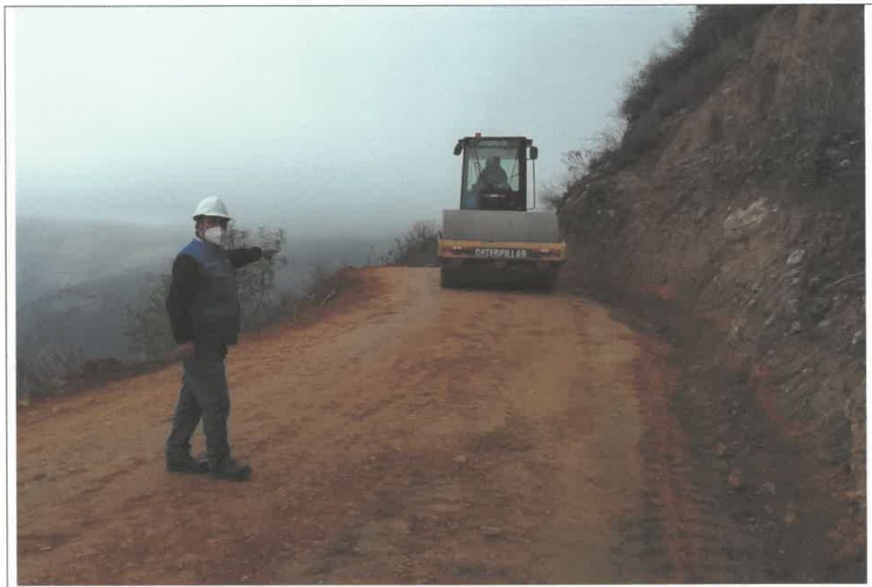
Proceso constructivo, Compactación de la plataforma en el, km 15+150 junto al Ing. Residente. 9091191N 814936E
