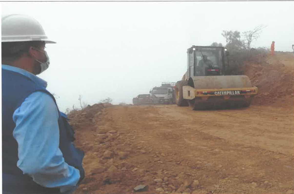
Verificación de los trabajos, Riego de plataforma y compactación en el km 11+500 junto al Ing. Residente. 9092993N 814548E
