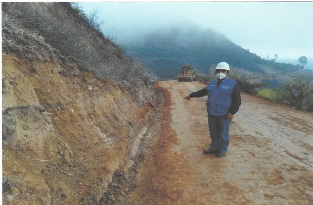
Verificación de los trabajos realizados, referente a la partida reconformación de cunetas km 12+500 9092462N 815068E
