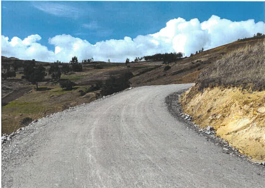
Se observa la conformación de la capa de material granular de cantera.
