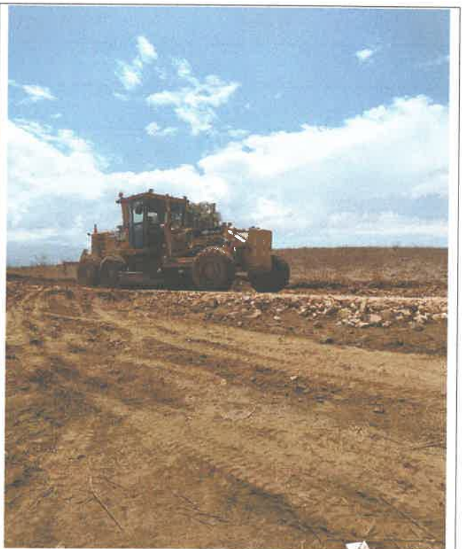
Verificación del proceso constructivo, colocación de capa nivelante e=0.05m, Km 18+200, 9089606N 813683E
