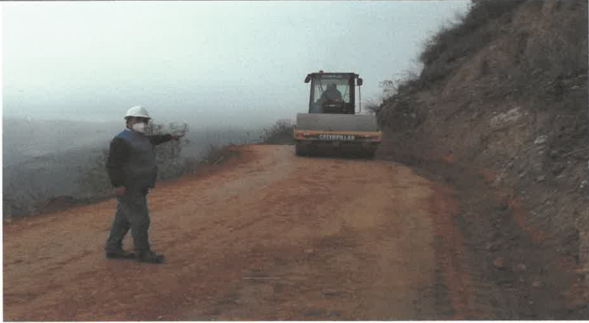
Proceso constructivo, Compactación de la plataforma en presencia del Ing. Residente. 9091191N 814936E
