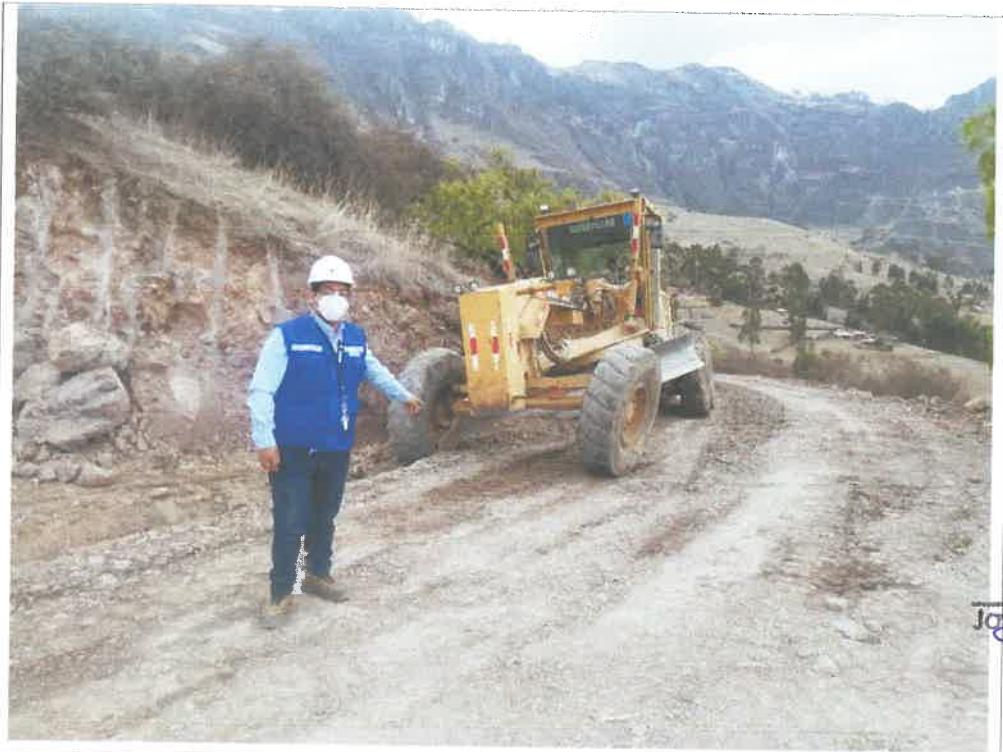
Verificación de los trabajos, referente al tramo 11, Km 17+000, a cargo del Ing.asistente 9090303N 814428E
