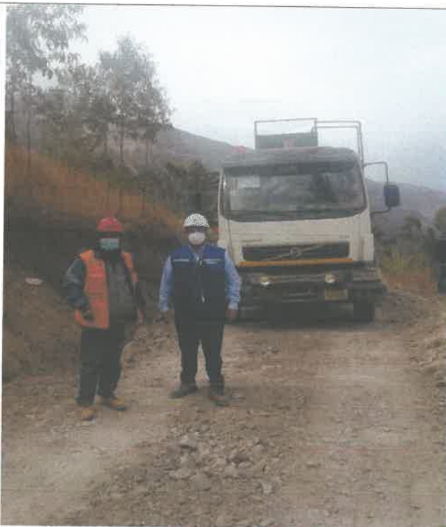
Verificación de los trabajos, referente al tramo 11, Km 21+500, al maestro de obra. 9087369N 812566E
