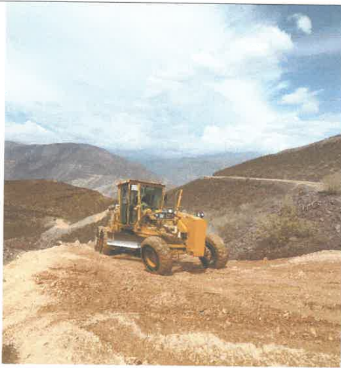
Proceso constructivo colocación de material granular de cantera e=0.15m, km 18+100 9089672N 813735E
