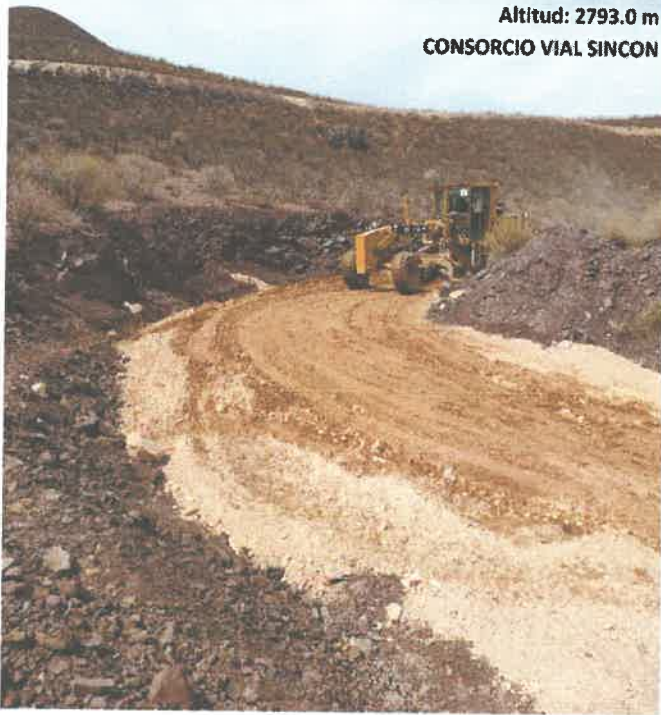
Inicio del proceso constructivo colocación de material granular de cantera e=0.15m, km 16+000 9090500N 814920E
