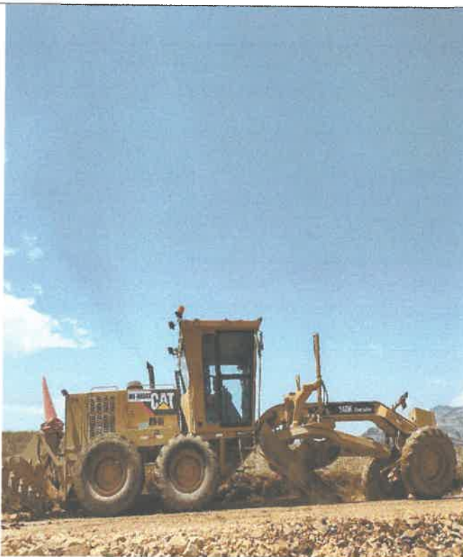
Verificación del proceso constructivo, colocación de capa nivelante e=0.05m, Km 17+500, 9090100N .8139901E
