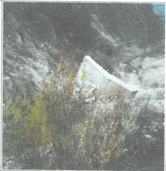
Se observó el desplome de aletas de alcantarilla por falla de erosión con alto deterioro. En el km 36+540
