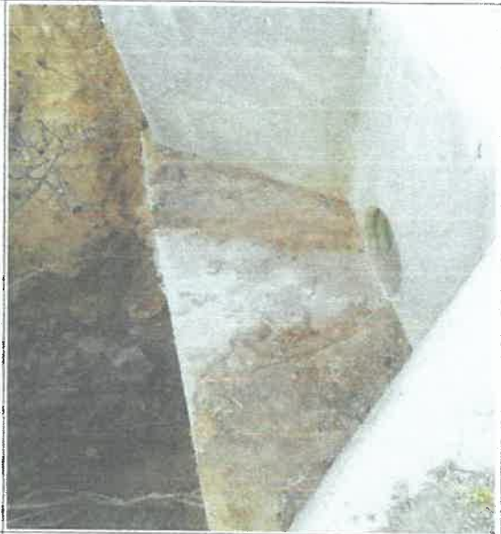
una parte de aleta de una alcantarilla a punto de desplomarse en el km 11+525
