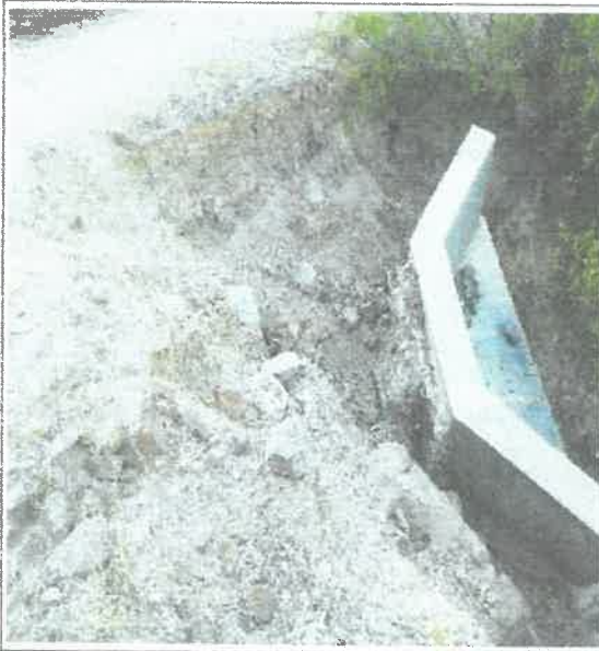
Alcantarilla por falla de erosión con alto deterioro. En el km km 10+200
