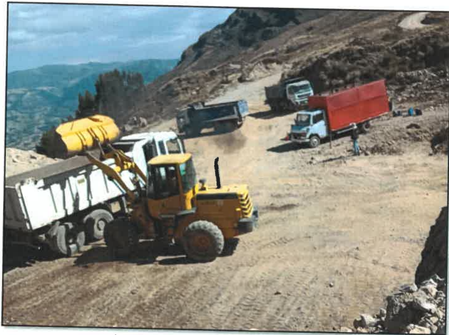
MOVILIZACIÓN DE MAQUINARIA PESADA Y EQUIPO LIVIANO TRAMO: DV. CHAGAVARA - LA CHIRA - TUTUARCO
