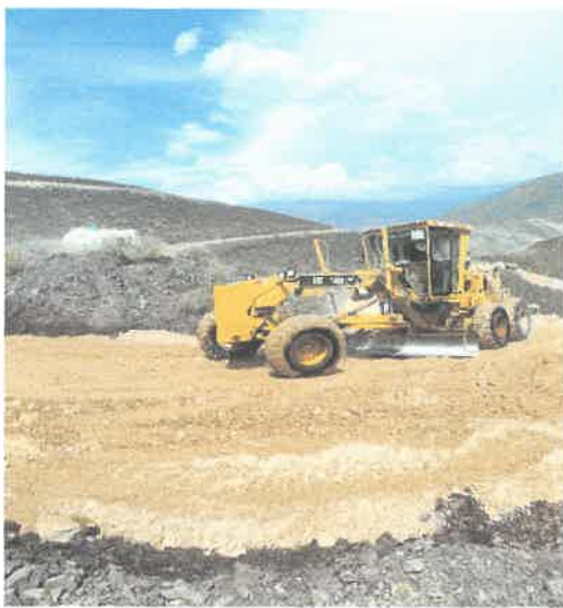
Trabajos de extendido de material granular de cantera tramos de Surovara -Conrra
