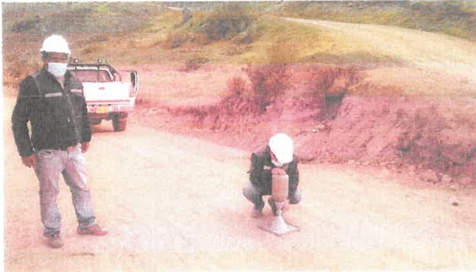
CONTROL DE CALIDAD DE LA CAPA DE AFRIMADO E=0.15 m. COLOCADA PROG. 0+000
