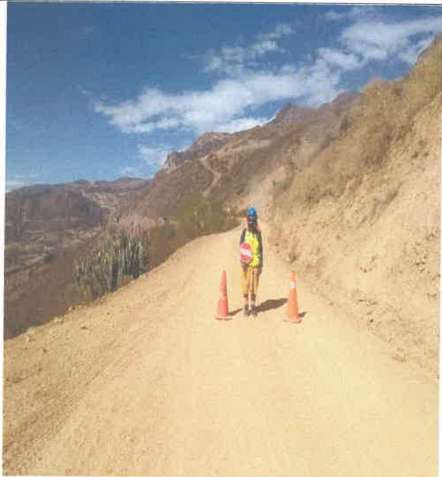
Ubicación de Vigia para inicio de las labores usando conos de seguridad para detener el flujo vehicular
