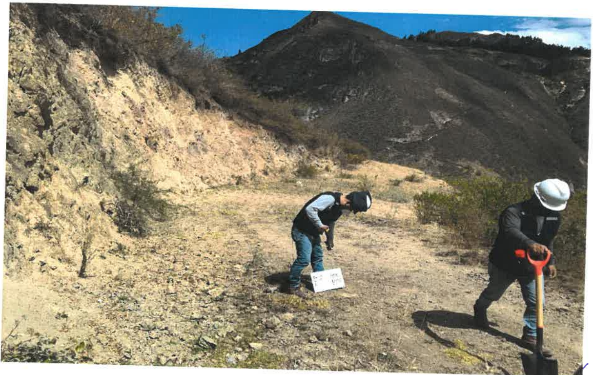
Se observa el trabajo de trazo y replanteo en el inicio del tramo prog 1+750. En SANTA ROSA - SANTA CRUZ DE CHUCA - LLATURPAMBA
