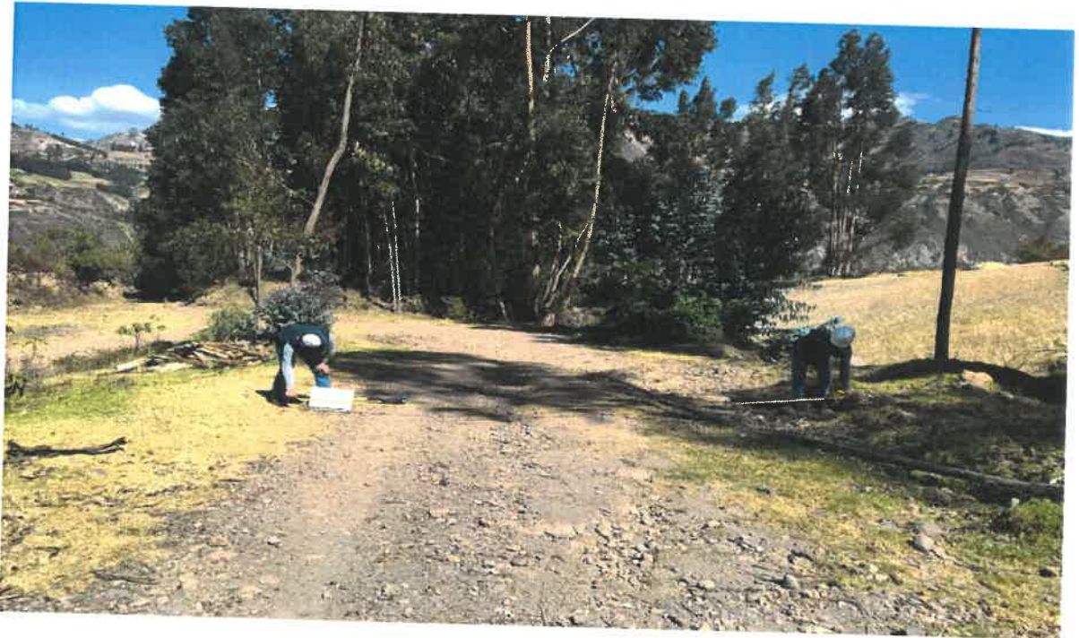
Se observa el trabajo de trazo y replanteo en el inicio del tramo prog 1+250. En SANTA ROSA - SANTA CRUZ DE CHUCA - LLATURPAMBA
