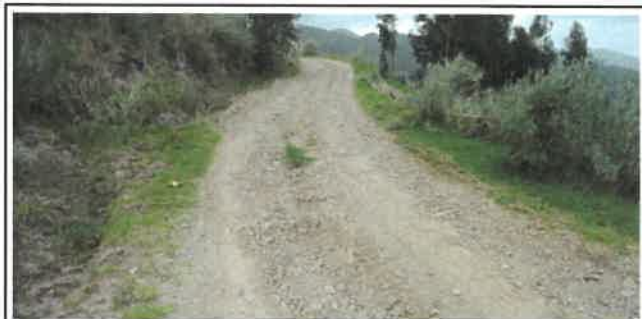
Foto N° DSR106: Se aprecia falla por erosión dañando al pavimento (Km 26+500 hasta Km 26+750.)
