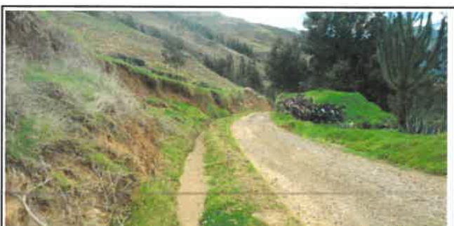
Foto N° DSR103: Se aprecia desgaste por erosión dañando al pavimento (Km 25+500 hasta Km 25+750.)
