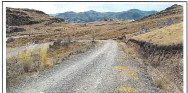
Foto N° DSR92: Se aprecia falla por erosión dañando al pavimento (Km 22+750 hasta Km 23+000.)
