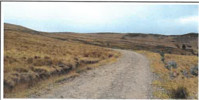
Foto N° DSR77: Se aprecia falla por erosión dañando al pavimento (Km 19+000 hasta Km 19+250.)
