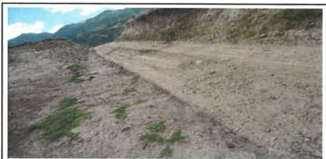
Foto N° DSR105: Se aprecia falla por erosión dañando al pavimento (Km 26+250 hasta Km 26+500.)
