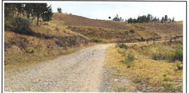
Foto N° DSR74: Se aprecia falla por erosión dañando al pavimento (Km 18+250 hasta Km 18+500.)
