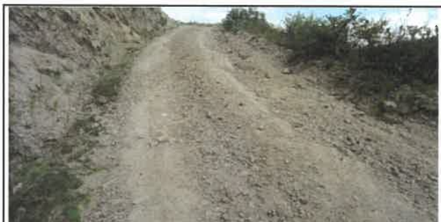
Foto N° DSR108: Se aprecia falla por erosión dañando al pavimento (Km 27+000 hasta Km 27+250.)
