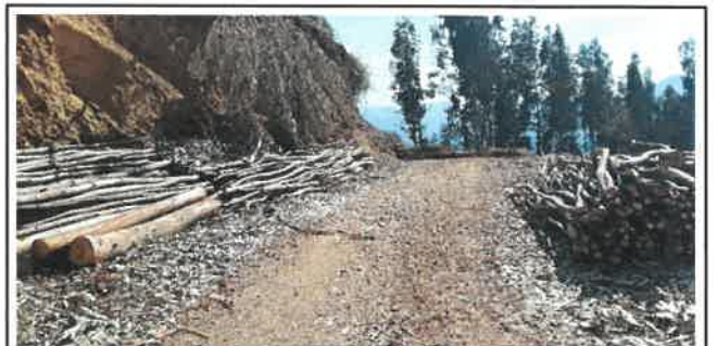
Foto N° DSR18: Se aprecia falla por erosión dañando al pavimento (Km 04+250 hasta Km 04+500.)
