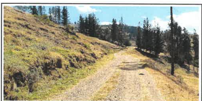
Foto N° DSR51: Se aprecia falla por erosión dañando al pavimento (Km 12+500 hasta Km 12+750.)
