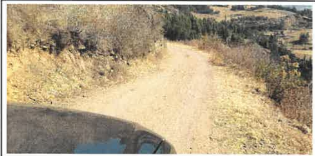
Foto N° DSR25: Se aprecia falla por erosión dañando al pavimento (Km 06+000 hasta Km 06+250.)
