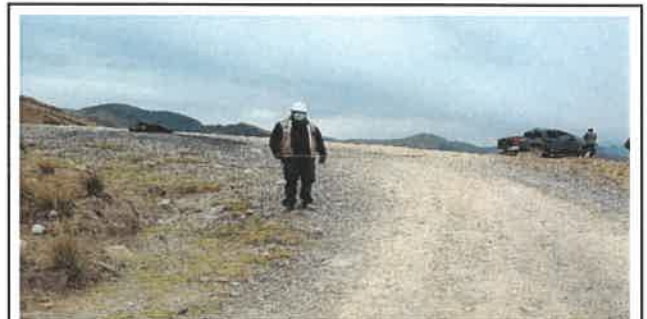
Foto N° DSR84: Se aprecia falla por erosión dañando al pavimento (Km 20+750 hasta Km 21+000.)
