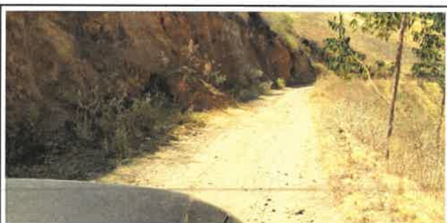
Foto N° DSR39: Se aprecia falla por erosión dañando al pavimento (Km 09+500 hasta Km 09+750.)
