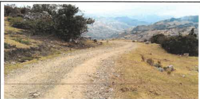
Foto N° DSR95: Se aprecia falla por erosión dañando al pavimento (Km 23+500 hasta Km 23+750.)
