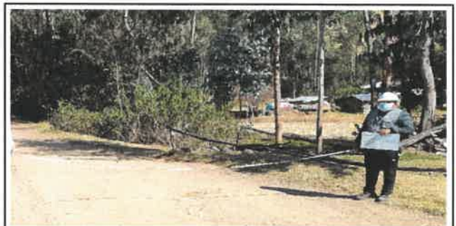
Foto N° DSR28: Se aprecia falla por erosión dañando al pavimento (Km 06+750 hasta Km 07+000.)
