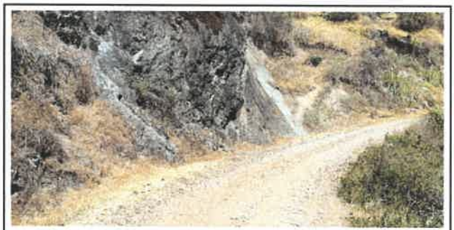
Foto N° DSR50: Se aprecia falla por erosión dañando al pavimento (Km 12+250 hasta Km 12+500.)
