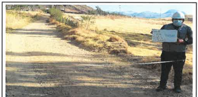
Foto N° DSR6: Se aprecia falla por erosión dañando al pavimento (Km 01+250 hasta Km 01+500.)
