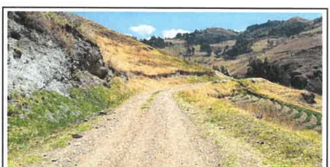
Foto N° DSR52: Se aprecia falla por erosión dañando al pavimento (Km 12+750 hasta Km 13+000.)
