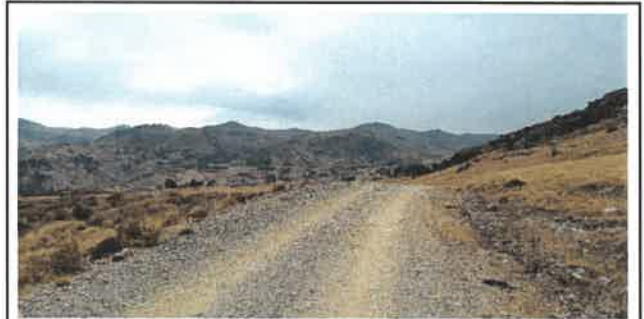
Foto N° DSR90: Se aprecia falla por erosión dañando al pavimento (Km 22+250 hasta Km 22+500.)
