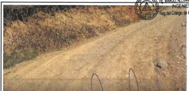
Foto N° DSR112: Se aprecia falla por erosión dañando al pavimento (Km 28+000 hasta Km 28+250.)
