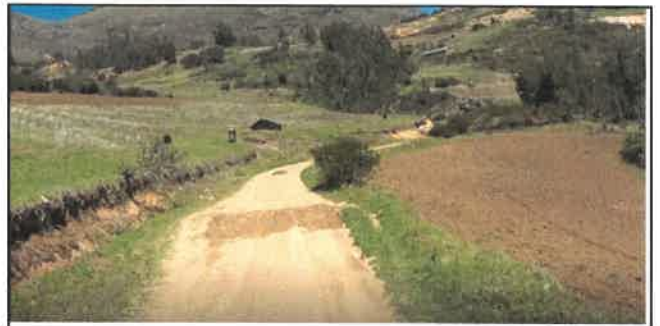
Foto N° DSR112: Se aprecia encausamiento de agua que afecta la capa de rodadura (Km 28+250 hasta Km 28+500.)
