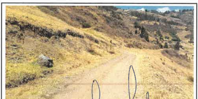
Foto N° DSR40: Se aprecia falla por erosión dañando al pavimento (Km 09+750 hasta Km 10+000)
