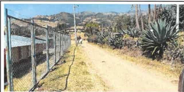
Foto N° DSR33: Se aprecia falla por erosión dañando al pavimento (Km 08+000 hasta Km 08+250.)
