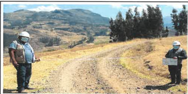
Foto N° DSR37: Se aprecia falla por erosión dañando al pavimento (Km 09+000 hasta Km 09+250.)
