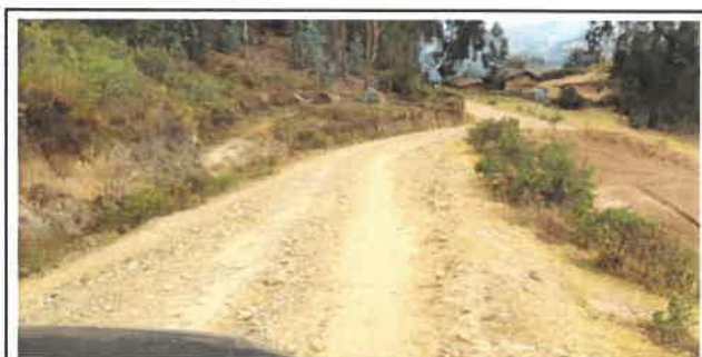
Foto N° DSR100: Se aprecia falla por erosión dañando al pavimento (Km 24+750 hasta Km 25+000.)
