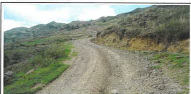
Foto N° DSR109: Se aprecia falla por erosión dañando al pavimento (Km 27+250 hasta Km 27+500.)
