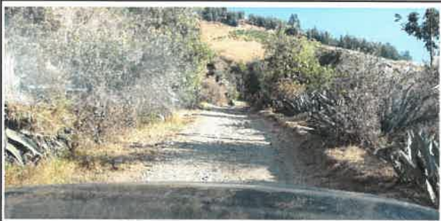
Foto N° DSR1: Se aprecia falla por erosión dañando al pavimento (Km 00+000 hasta Km 00+250.)
