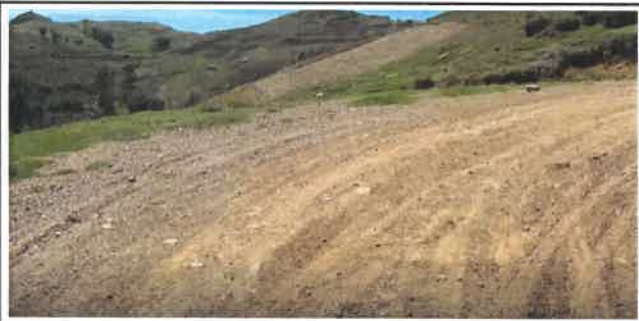
Foto N° DSR112: Se aprecia falla por erosión dañando al pavimento (Km 28+500 hasta Km 28+600.)
