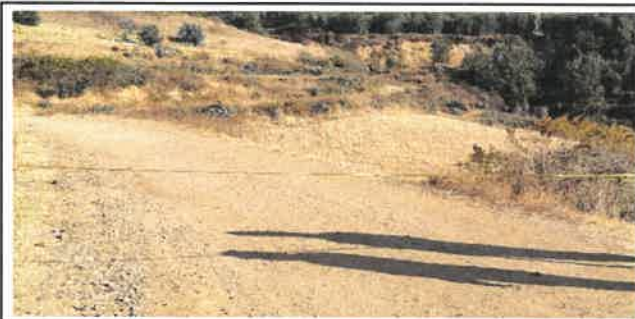
Foto N° DSR3: Se aprecia falla por erosión dañando al pavimento (Km 00+500 hasta Km 00+750.)
