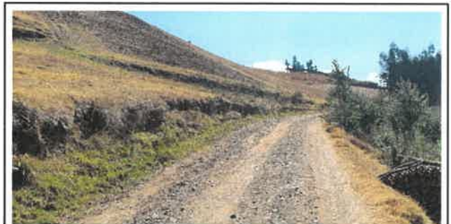
Foto N° DSR30: Se aprecia falla por erosión dañando al pavimento (Km 07+250 hasta Km 07+500.)
