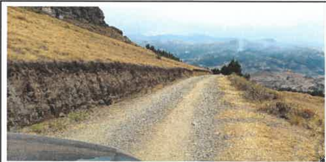
Foto N° DSR93: Se aprecia falla por erosión dañando al pavimento (Km 23+000 hasta Km 23+250.)
