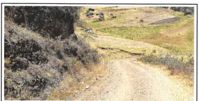
Foto N° DSR54: Se aprecia falla por erosión dañando al pavimento (Km 13+250 hasta Km 13+500.)
