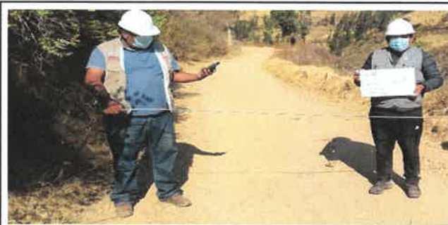
Foto N° DSR13: Se aprecia falla por erosión dañando al pavimento (Km 03+000 hasta Km 03+250.)
