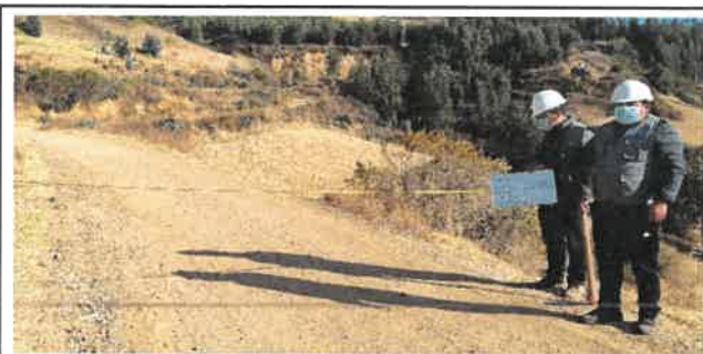
Foto N° DSR7: Se aprecia falla por erosión dañando al pavimento (Km 01+500 hasta Km 01+750.)
