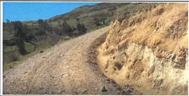
Foto N° DSR113: Se aprecia falla por erosión dañando al pavimento (Km 28+000 hasta Km 28+250.)
