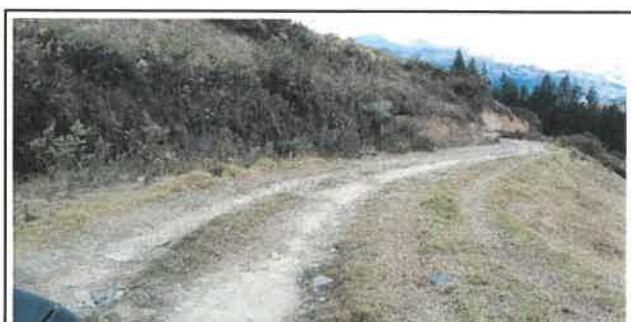
Foto N° DSR102: Se aprecia falla por erosión dañando al pavimento (Km 25+250 hasta Km 25+500.)
