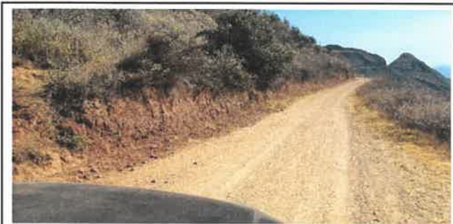
Foto N° DSR19: Se aprecia falla por erosión dañando al pavimento (Km 04+500 hasta Km 04+750.)
