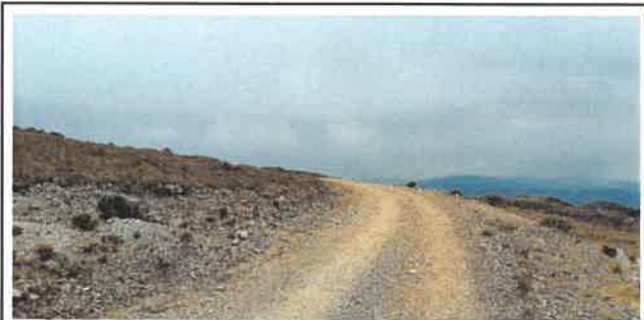
Foto N° DSR85: Se aprecia falla por erosión dañando al pavimento (Km 21+000 hasta Km 21+250.)
