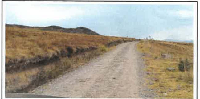
Foto N° DSR76: Se aprecia falla por erosión dañando al pavimento (Km 18+750 hasta Km 19+000.)
