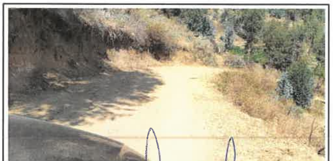
Foto N° DSR24: Se aprecia falla por erosión dañando al pavimento (Km 05+750 hasta Km 06+000.)
