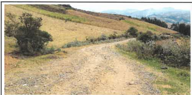
Foto N° DSR99: Se aprecia falla por erosión dañando al pavimento (Km 24+500 hasta Km 24+750.)
