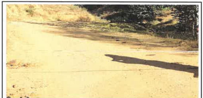
Foto N° DSR4: Se aprecia falla por erosión dañando al pavimento (Km 00+750 hasta Km 01+000.)
