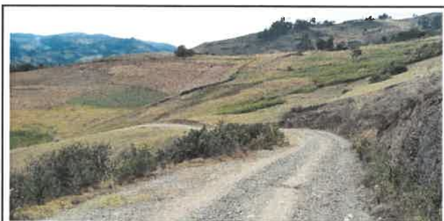
Foto N° DSR101: Se aprecia falla por erosión dañando al pavimento (Km 25+000 hasta Km 25+250.)
