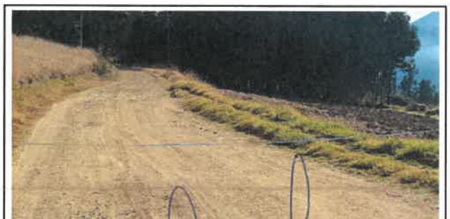
Foto N° DSR8: Se aprecia falla por erosión dañando al pavimento (Km 01+750 hasta Km 02+000.)
