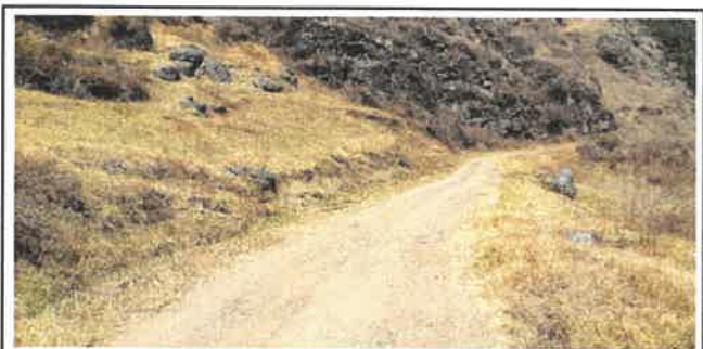
Foto N° DSR45: Se aprecia falla por erosión dañando al pavimento (Km 11+000 hasta Km 11+250.)
