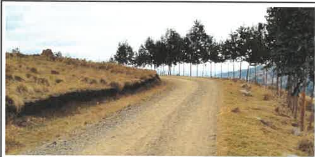
Foto N° DSR75: Se aprecia falla por erosión dañando al pavimento (Km 18+500 hasta Km 18+750.)
