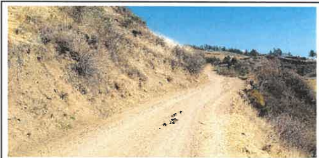
Foto N° DSR27: Se aprecia falla por erosión dañando al pavimento (Km 06+500 hasta Km 06+750.)
