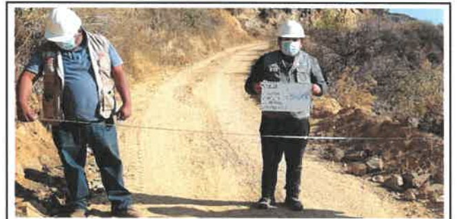
Foto N° DSR12: Se aprecia falla por erosión dañando al pavimento (Km 02+750 hasta Km 03+000.)
