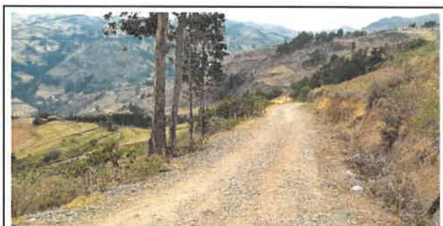
Foto N° DSR98: Se aprecia falla por erosión dañando al pavimento (Km 24+250 hasta Km 24+500.)
