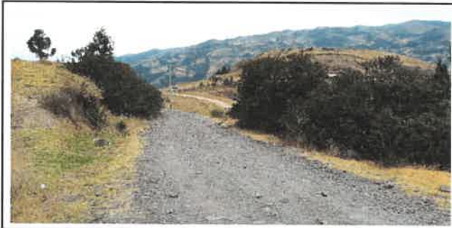
Foto N° DSR73: Se aprecia falla por erosión dañando al pavimento (Km 18+000 hasta Km 18+250.)
