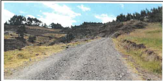
Foto N° DSR65: Se aprecia falla por erosión dañando al pavimento (Km 16+000 hasta Km 16+250.)
