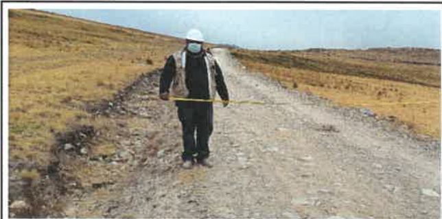
Foto N° DSR83: Se aprecia falla por erosión dañando al pavimento (Km 20+500 hasta Km 20+750.)
