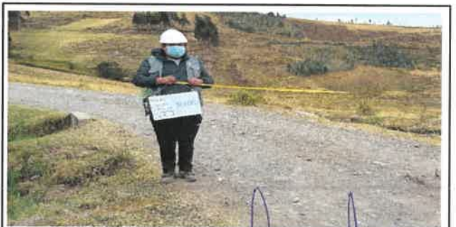
Foto N° DSR72: Se aprecia falla por erosión dañando al pavimento (Km 17+750 hasta Km 18+000.)
