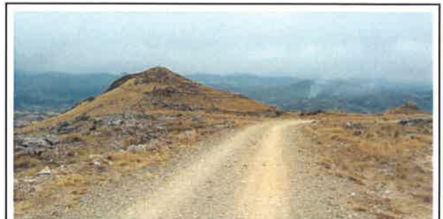
Foto N° DSR86: Se aprecia falla por erosión dañando al pavimento (Km 21+250 hasta Km 21+500.)
