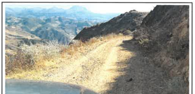
Foto N° DSR22: Se aprecia falla por erosión dañando al pavimento (Km 05+250 hasta Km 05+500.)
