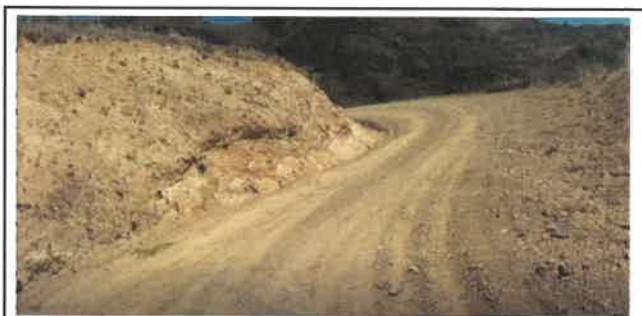
Foto N° DSR110: Se aprecia falla por erosión dañando al pavimento (Km 26+500 hasta Km 27+750.)
