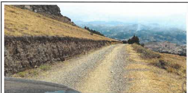
Foto N° DSR97: Se aprecia falla por erosión dañando al pavimento (Km 24+000 hasta Km 24+250.)
