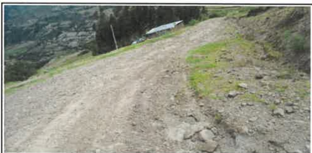
Foto N° DSR107: Se aprecia falla por erosión dañando al pavimento (Km 26+750 hasta Km 27+000.)
