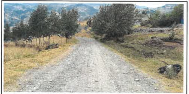
Foto N° DSR70: Se aprecia falla por erosión dañando al pavimento (Km 17+250 hasta Km 17+500.)
