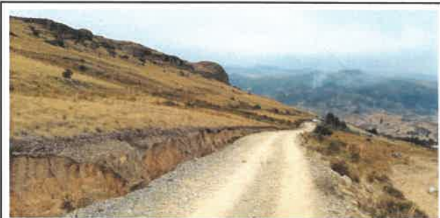
Foto N° DSR91: Se aprecia falla por erosión dañando al pavimento (Km 22+500 hasta Km 22+750.)
