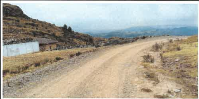
Foto N° DSR89: Se aprecia falla por erosión dañando al pavimento (Km 22+000 hasta Km 22+250.)
