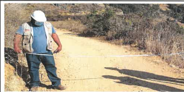
Foto N° DSR11: Se aprecia falla por erosión dañando al pavimento (Km 02+500 hasta Km 02+750.)
