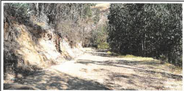
Foto N° DSR29: Se aprecia falla por erosión dañando al pavimento (Km 07+000 hasta Km 07+250.)
