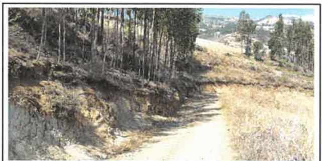
Foto N° DSR38: Se aprecia falla por erosión dañando al pavimento (Km 09+250 hasta Km 09+500.)
