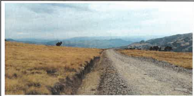
Foto N° DSR81: Se aprecia falla por erosión dañando al pavimento (Km 20+000 hasta Km 20+250.)
