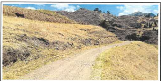
Foto N° DSR53: Se aprecia falla por erosión dañando al pavimento (Km 13+000 hasta Km 13+250.)
