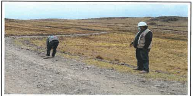
Foto N° DSR78: Se aprecia falla por erosión dañando al pavimento (Km 19+250 hasta Km 19+500.)
