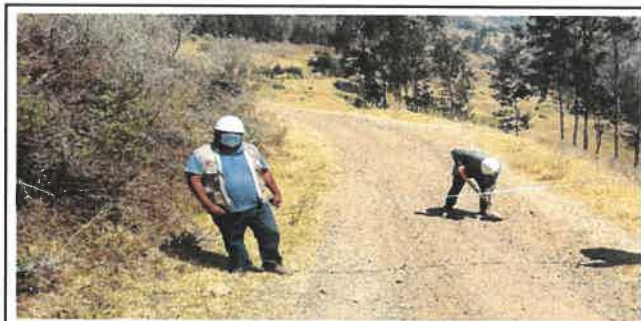
Foto N° DSR42: Se aprecia falla por erosión dañando al pavimento (Km 10+250 hasta Km 10+500.)
