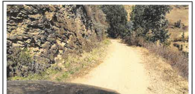
Foto N° DSR14: Se aprecia falla por erosión dañando al pavimento (Km 03+250 hasta Km 03+500.)
