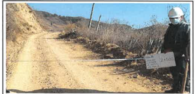
Foto N° DSR10: Se aprecia falla por erosión dañando al pavimento (Km 02+250 hasta Km 02+500.)
