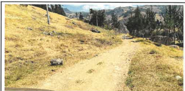
Foto N° DSR43: Se aprecia falla por erosión dañando al pavimento (Km 10+500 hasta Km 10+750.)
