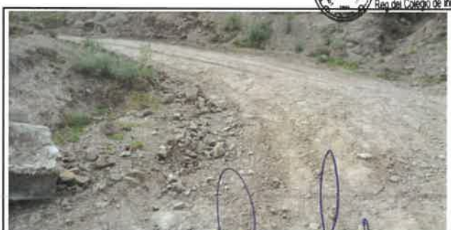
Foto N° DSR104: Se aprecia falla por erosión dañando al pavimento (Km 25+750 hasta Km 26+000.)
