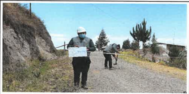
Foto N° DSR69: Se aprecia falla por erosión dañando al pavimento (Km 17+000 hasta Km 17+250.)
