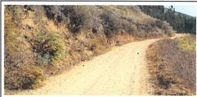
Foto N° DSR17: Se aprecia falla por erosión dañando al pavimento (Km 04+000 hasta Km 04+250.)
