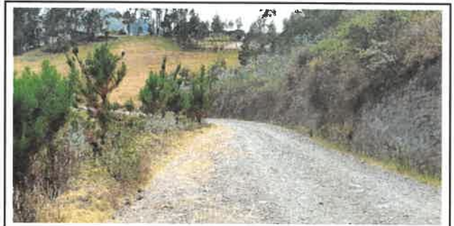
Foto N° DSR68: Se aprecia falla por erosión dañando al pavimento (Km 16+750 hasta Km 17+000.)
