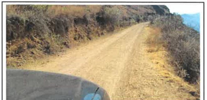
Foto N° DSR20: Se aprecia falla por erosión dañando al pavimento (Km 04+750 hasta Km 05+000.)
