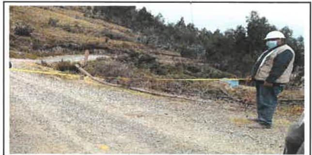
Foto N° DSR94: Se aprecia falla por erosión dañando al pavimento (Km 23+250 hasta Km 23+500.)
