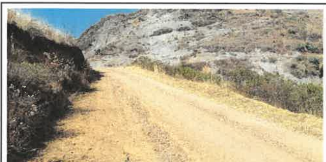
Foto N° DSR21: Se aprecia falla por erosión dañando al pavimento (Km 05+000 hasta Km 05+250.)
