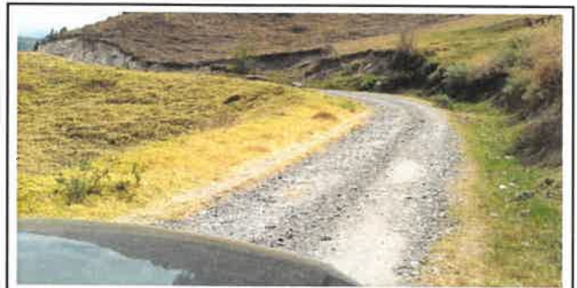
Foto N° DSR66: Se aprecia falla por erosión dañando al pavimento (Km 16+250 hasta Km 16+500.)
