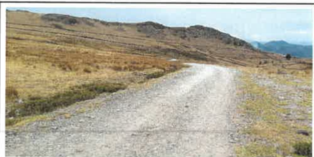
Foto N° DSR79: Se aprecia falla por erosión dañando al pavimento (Km 19+500 hasta Km 19+750.)
