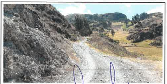
Foto N° DSR56: Se aprecia falla por erosión dañando al pavimento (Km 13+750 hasta Km 14+000.)
