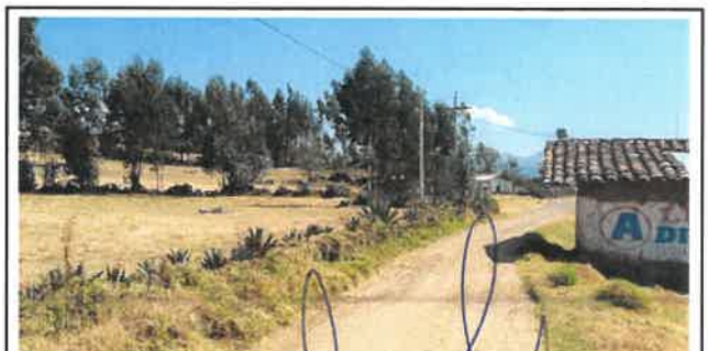
Foto N° DSR32: Se aprecia falla por erosión dañando al pavimento (Km 07+750 hasta Km 08+000.)
