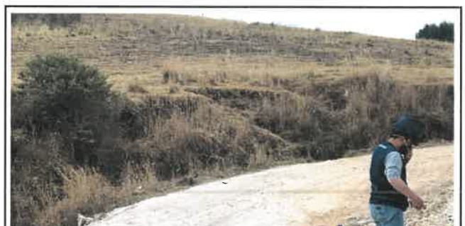
Foto N° DSR48: Se aprecia falla por erosión dañando al pavimento (Km 11+750 hasta Km 11+900.)
