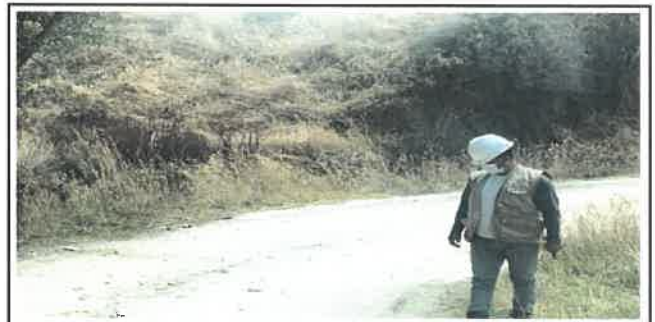
Foto N° DSR42: Se aprecia falla por erosión dañando al pavimento (Km 10+250 hasta Km 10+500.)
