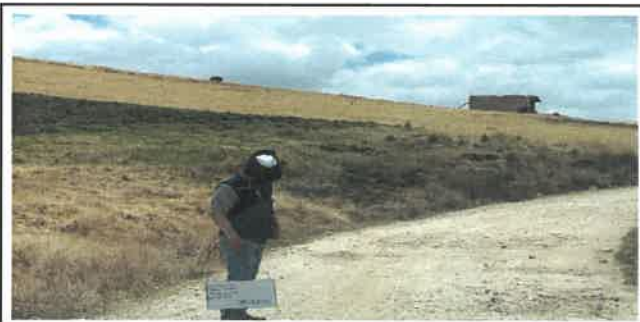
Foto N° DSR21: Se aprecia falla por erosión dañando al pavimento (Km 05+000 hasta Km 05+250.)
