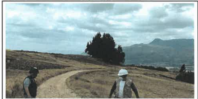
Foto N° DSR30: Se aprecia falla por erosión dañando al pavimento (Km 07+250 hasta Km 07+500.)
