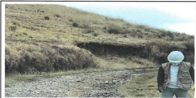
Foto N° DSR9: Se aprecia falla por erosión dañando al pavimento (Km 02+000 hasta Km 02+250.)
