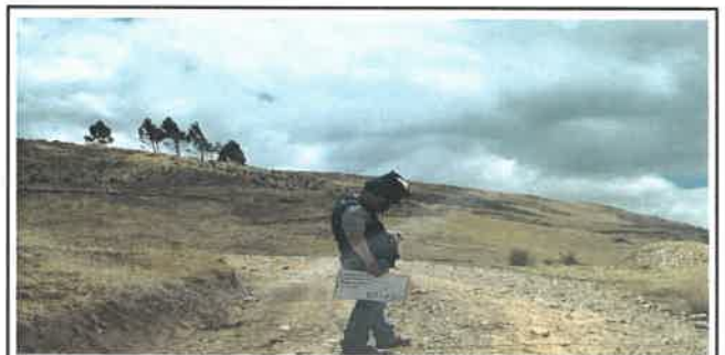
Foto N° DSR12: Se aprecia falla por erosión dañando al pavimento (Km 02+750 hasta Km 03+000.)
