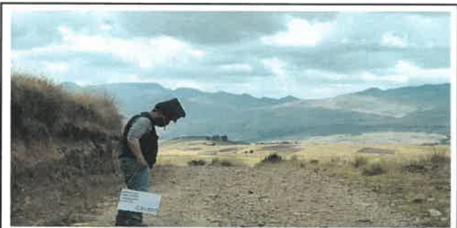
Foto N° DSR13: Se aprecia falla por erosión dañando al pavimento (Km 03+000 hasta Km 03+250.)
