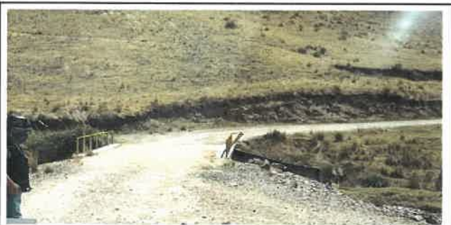
Foto N° DSR5: Se aprecia falla por erosión dañando al pavimento (Km 01+000 hasta Km 01+250.)
