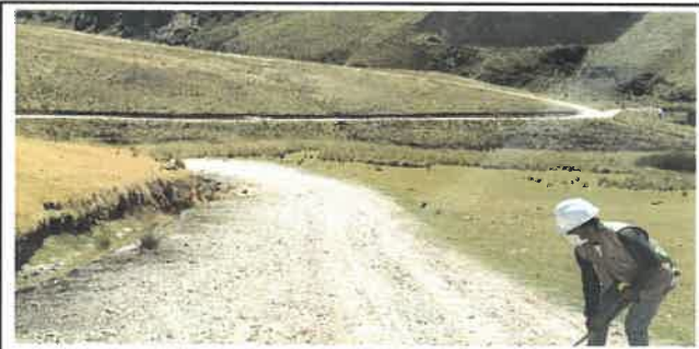
Foto N° DSR3: Se aprecia falla por erosión dañando al pavimento (Km 00+500 hasta Km 00+750.)
