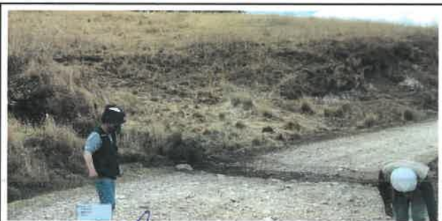
Foto N° DSR23: Se aprecia falla por erosión dañando al pavimento (Km 05+500 hasta Km 05+750.)
