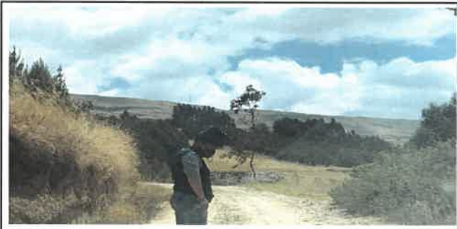
Foto N° DSR41: Se aprecia falla por erosión dañando al pavimento (Km 10+000 hasta Km 10+250.)
