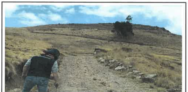
Foto N° DSR14: Se aprecia falla por erosión dañando al pavimento (Km 03+250 hasta Km 03+500.)
