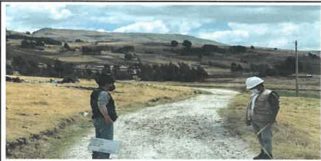
Foto N° DSR33: Se aprecia falla por erosión dañando al pavimento (Km 08+000 hasta Km 08+250.)
