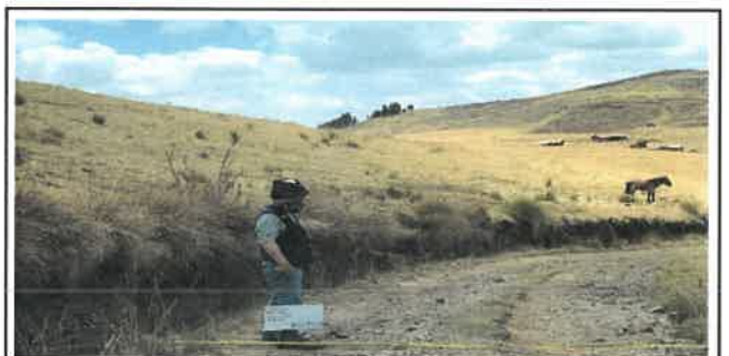
Foto N° DSR16: Se aprecia falla por erosión dañando al pavimento (Km 03+750 hasta Km 04+000.)
