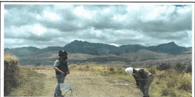
Foto N° DSR15: Se aprecia falla por erosión dañando al pavimento (Km 03+500 hasta Km 03+750.)
