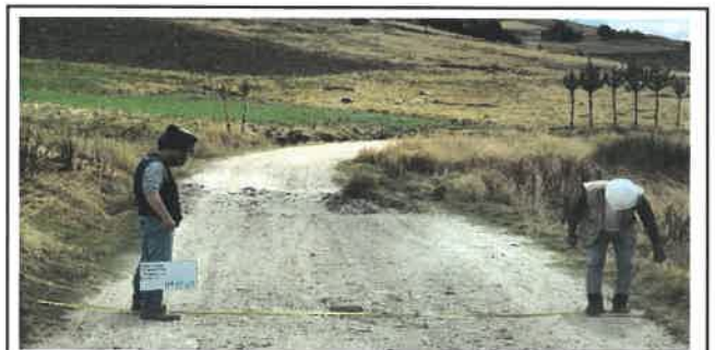
Foto N° Top20: Vista del ancho de la superficie de rodadura en el Km 04+750.
