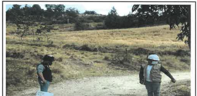
Foto N° DSR44: Se aprecia falla por erosión dañando al pavimento (Km 10+750 hasta Km 11+000.)
