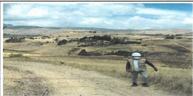
Foto N° DSR31: Se aprecia falla por erosión dañando al pavimento (Km 07+500 hasta Km 07+750.)
