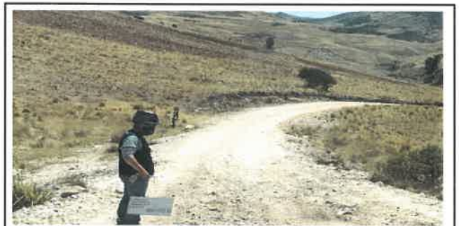
Foto N° DSR2: Se aprecia falla por erosión dañando al pavimento (Km 00+250 hasta Km 00+500.)
