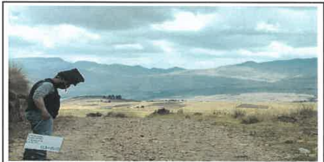
Foto N° DSR34: Se aprecia falla por erosión dañando al pavimento (Km 08+250 hasta Km 08+500.)
