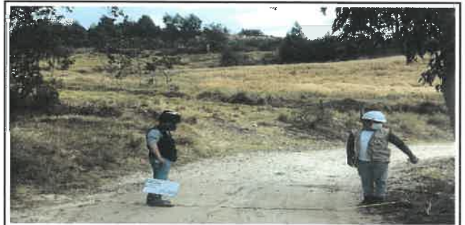
Foto N° Top44: Vista del ancho de la superficie de rodadura en el Km 10+750.
