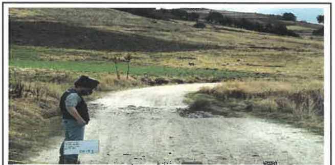
Foto N° DSR20: Se aprecia falla por erosión dañando al pavimento (Km 04+750 hasta Km 05+000.)
