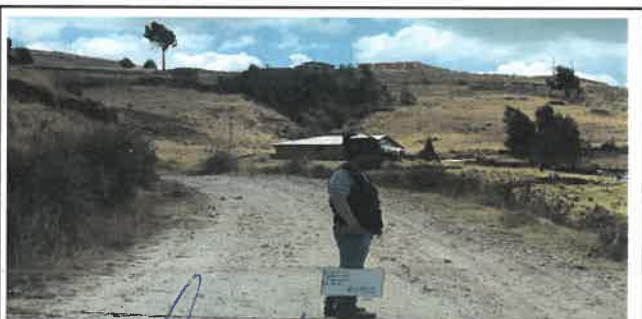
Foto N° DSR47: Se aprecia falla por erosión dañando al pavimento (Km 11+500 hasta Km 11+750.)
