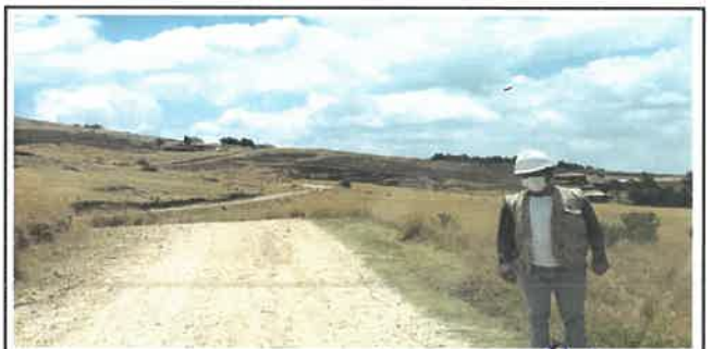
Foto N° DSR24: Se aprecia falla por erosión dañando al pavimento (Km 05+750 hasta Km 06+000.)
