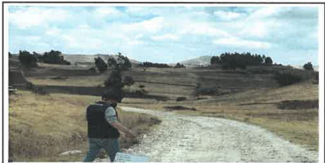
Foto N° DSR36: Se aprecia falla por erosión dañando al pavimento (Km 08+750 hasta Km 09+000.)
