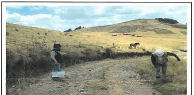
Foto N° Top16: Vista del ancho de la superficie de rodadura en el Km 03+750.
