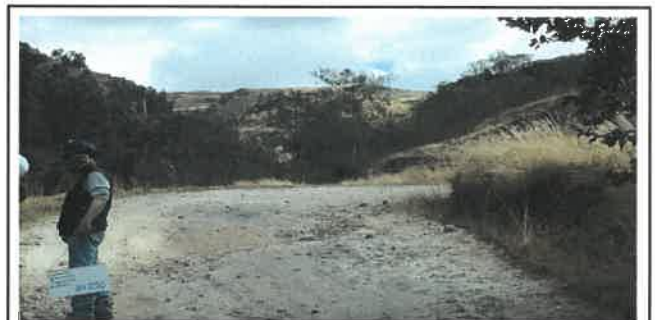
Foto N° DSR46: Se aprecia falla por erosión dañando al pavimento (Km 11+250 hasta Km 11+500.)
