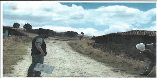
Foto N° DSR35: Se aprecia falla por erosión dañando al pavimento (Km 08+500 hasta Km 08+750.)
