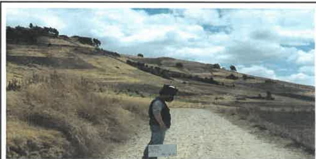
Foto N° DSR19: Se aprecia falla por erosión dañando al pavimento (Km 04+500 hasta Km 04+750.)
