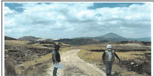
Foto N° DSR32: Se aprecia falla por erosión dañando al pavimento (Km 07+750 hasta Km 08+000.)
