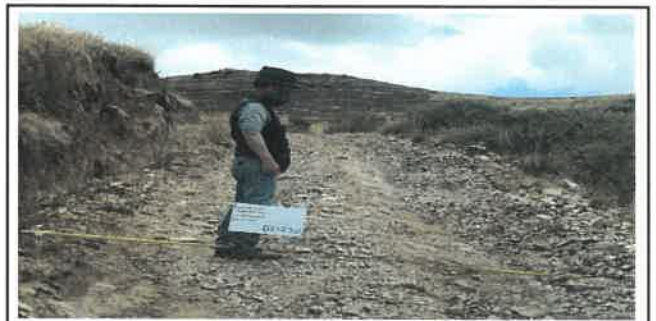
Foto N° DSR10: Se aprecia falla por erosión dañando al pavimento (Km 02+250 hasta Km 02+500.)
