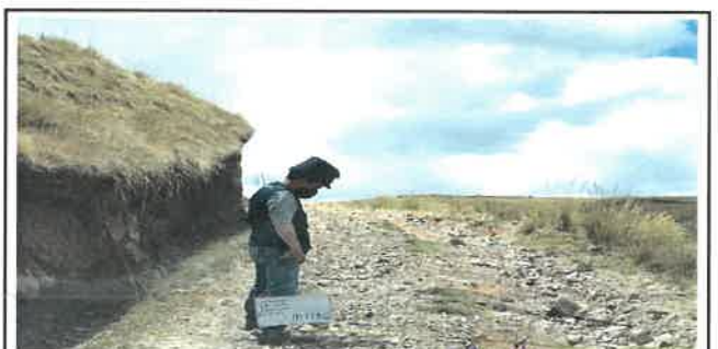
Foto N° DSR8: Se aprecia falla por erosión dañando al pavimento (Km 01+750 hasta Km 02+000.)
