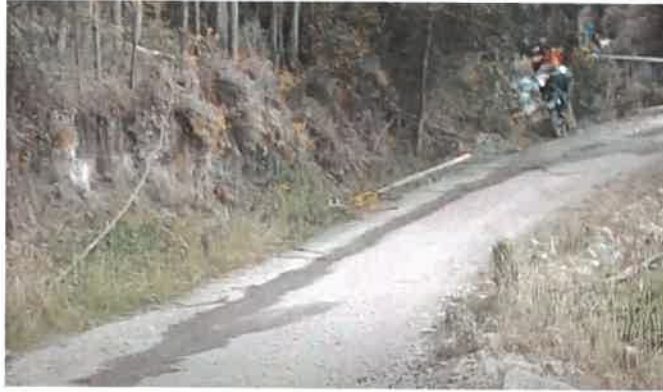
Foto 153: KM 9+550, Erosión al lado izquierdo de la calzada
