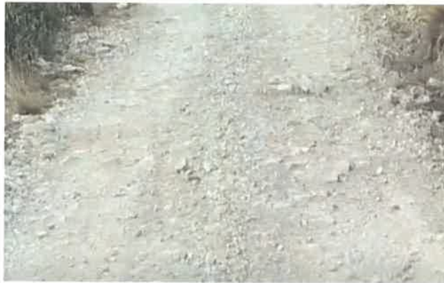
Foto 223 KM 13+850, Bacheo en ambos lados de la calzada
