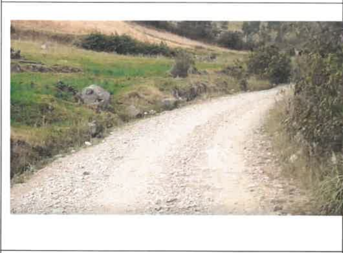
Foto 137: KM 8+550, Ahuellamiento al lado izquierdo de la calzada
