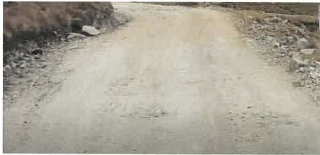
Foto 297: KM 18+550, Bacheo en ambos lados de la calzada
