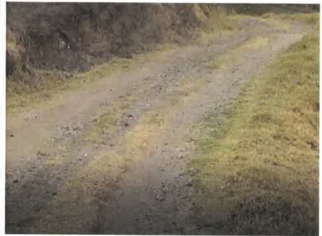
Foto 02: KM 0+100 ahuellamiento a ambos lados de la calzada y erosión longitudinal
