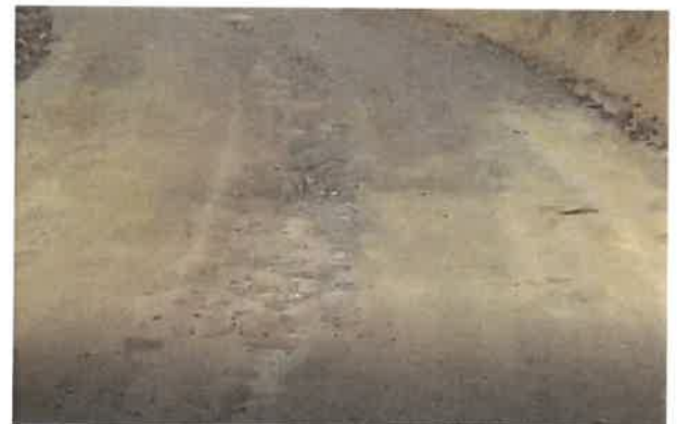
Foto 56: KM 3+450, Erosion en el centro de la calzada
