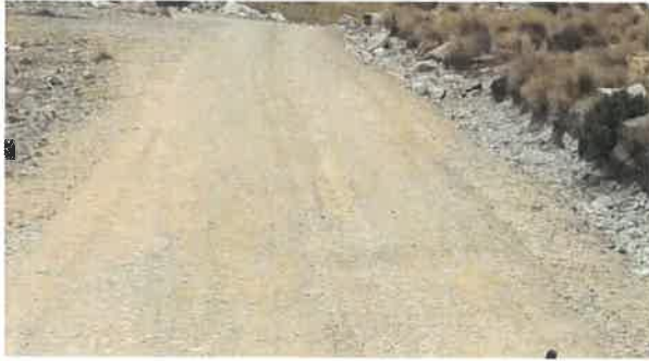
Foto 291: KM 18+150, Bacheo al lado derecho de la calzada
