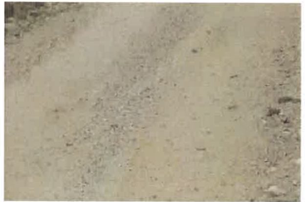
Foto 64: KM 3+950, Ahuellamiento al lado derecho de la calzada
