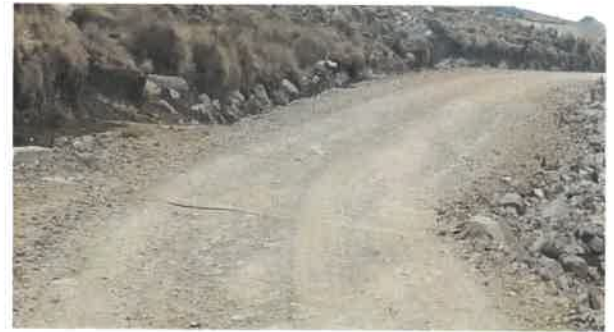
Foto 330: KM 20+600, Bacheo en ambos lados de la calzada
