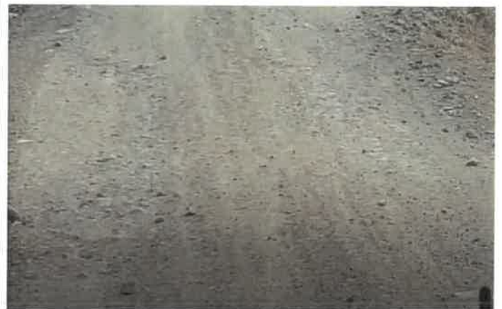
Foto 206: KM 12+800, Bacheo al lado izquierdo de la calzada
