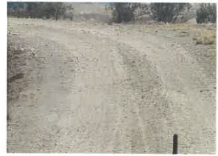
Foto 228: KM 14+200, Bacheo en ambos lados de la calzada
