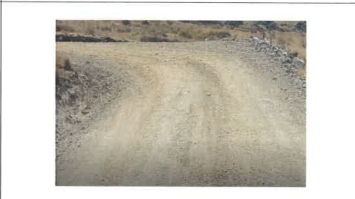
Foto 270: KM 16+850, Ahuellamiento en ambos lados de la calzada
