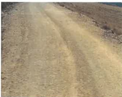
Foto 277: KM 17+300, Bacheo en ambos lados de la calzada
