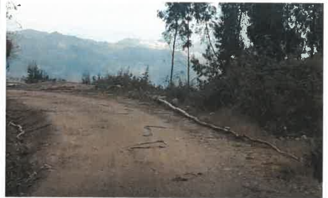
Foto 156: KM 9+700, Erosión al lado izquierdo de la calzada
