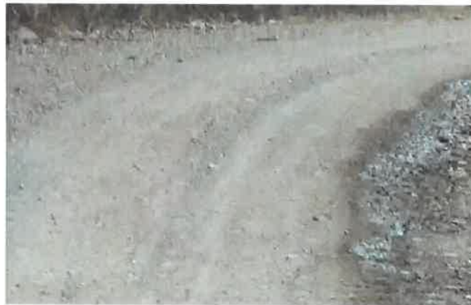
Foto 107: KM 6+650, Erosión en medio de la calzada
