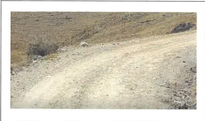
Foto 271: KM 16+900, Ahuellamiento en ambos lados de la calzada
