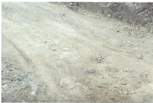
Foto 241: KM 15+050, Bacheo en ambos lados de la calzada
