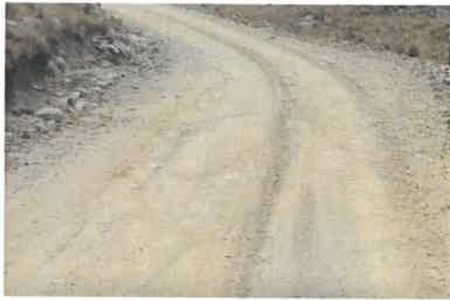
Foto 313: KM 19+550, Erosión al centro de la calzada
