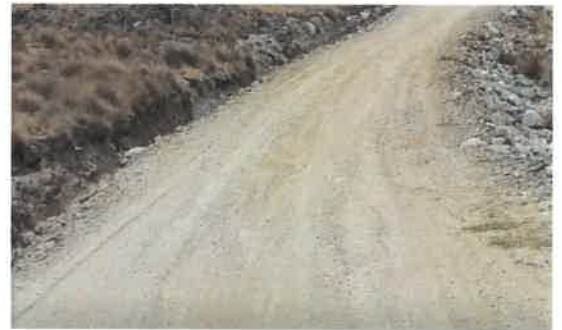
Foto 300: KM 18+700, Ahuellamiento en ambos lados de la calzada
