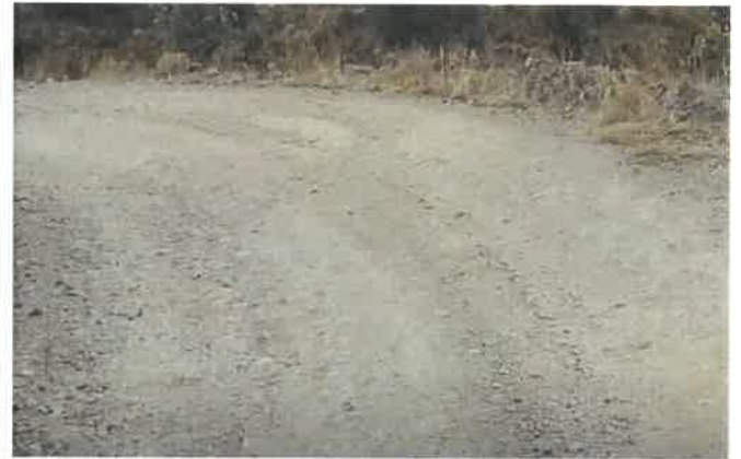
Foto 234: KM 14+550, Ahuellamiento al lado derecho de la calzada y Erosión
