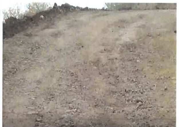
Foto 50: KM 3+100, Encalaminado y Bacheo en toda la calzada
