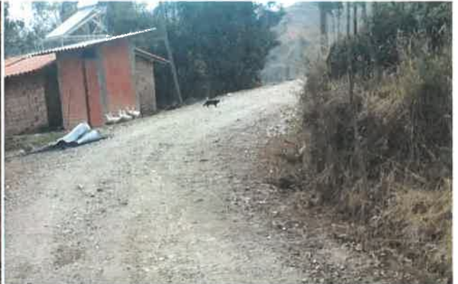
Foto 142: KM 8+850, Encalaminado a la derecha y Erosión a la izquierda
