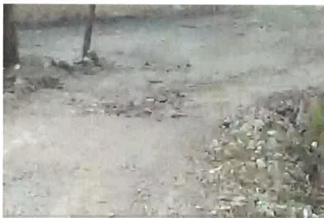
Foto 109: KM 6+800, Erosión en medio de la calzada
