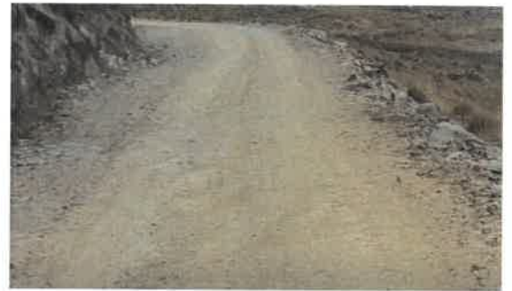
Foto 314: KM 19+600, Bacheo al lado izquierdo de la calzada
