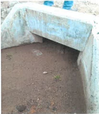
Foto 32: KM 19+900, Vista de Ingreso de alcantarilla obstruida por tierra.
