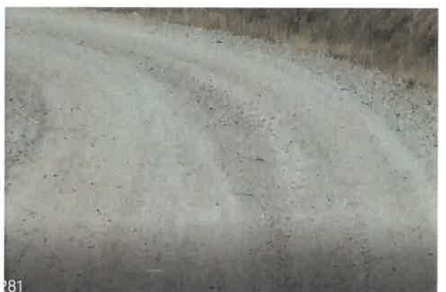
Foto 104: KM 6+450, Erosión en el centro de la calzada
