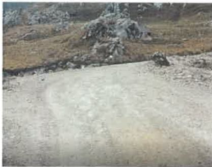
Foto 323: KM 20+150, Bacheo en ambos lados de la calzada
