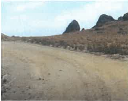
Foto 275: KM 17+150, Ahuellamiento en ambos lados de la calzada
