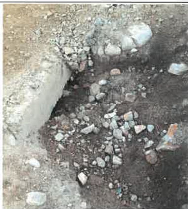
Foto 30: KM 17+950, Vista de Ingreso de alcantarilla obstruida por piedras tierra.
