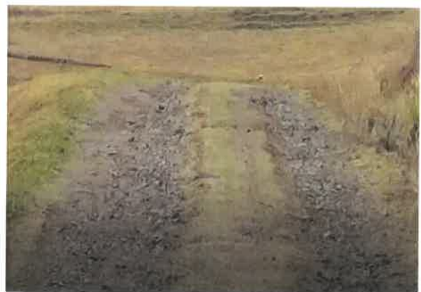
Foto 06: KM 0+350, Ahuellamiento en ambos lados de la calzada
