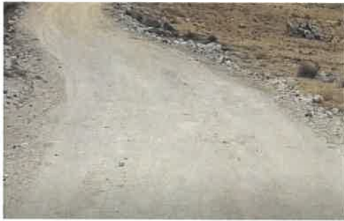
Foto 299: KM 18+650, Erosión en ambos lados de la calzada
