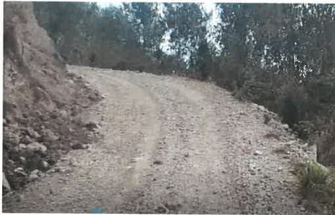
Foto 161: KM 10+050, Erosión en ambos lados de la calzada
