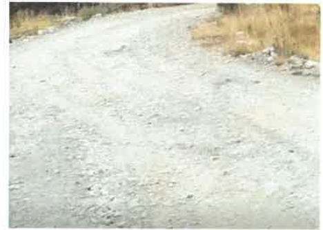
Foto 234: KM 14+600, Ahuellamiento en ambos lados de la calzada
