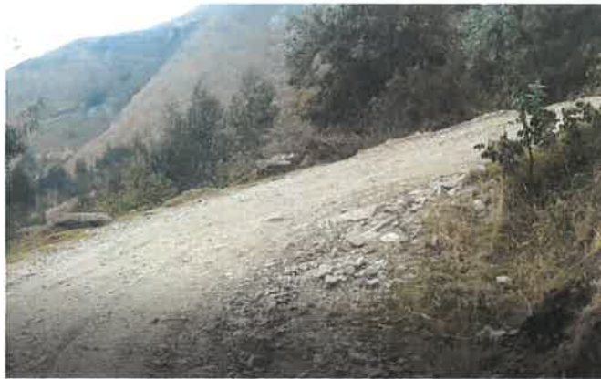
Foto 143: KM 8+900, Erosión en el lado derecho de la calzada
