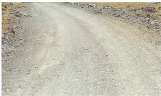
Foto 283: KM 17+650, Bacheo en ambos lados de la calzada
