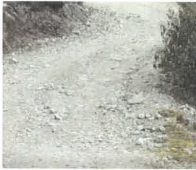
Foto 237: KM 14+800, Bacheo y Erosión en la calzada
