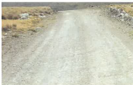
Foto 284: KM 17+700, Bacheo al lado izquierdo de la calzada
