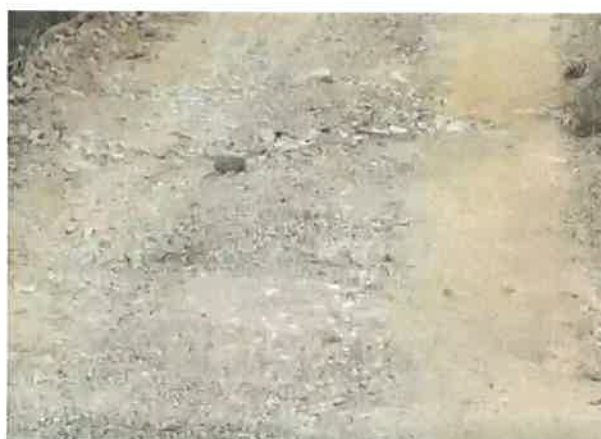
Foto 73: KM 4+550, Bacheo, erosión y encalaminado en todo la calzada
