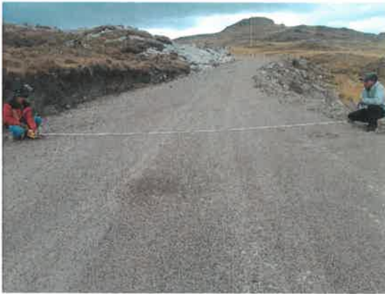
Foto 08: KM 19+750, Vista toma de información en campo, detallando el ancho de plataforma.
