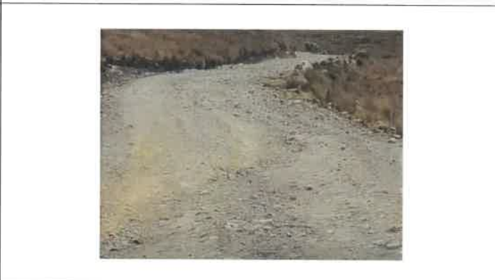
Foto 264: KM 16+450, Erosión en ambos lados de la calzada
