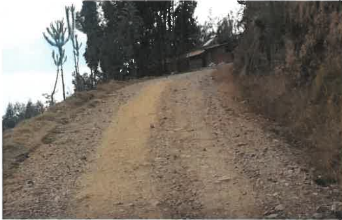
Foto 141: KM 8+800, Ahuellamiento en ambos lados de la calzada
