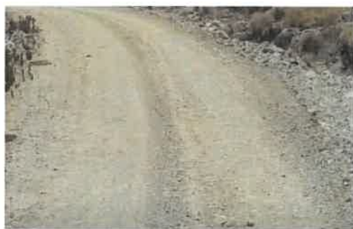
Foto 289: KM 18+050, Encala minado en ambos lados de la calzada
