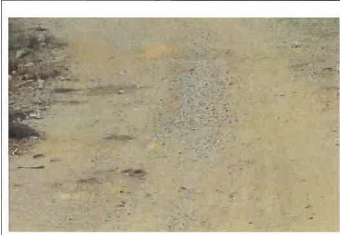
Foto 117: KM 7+300, Bacheo y Ahuellamiento en toda la calzada
