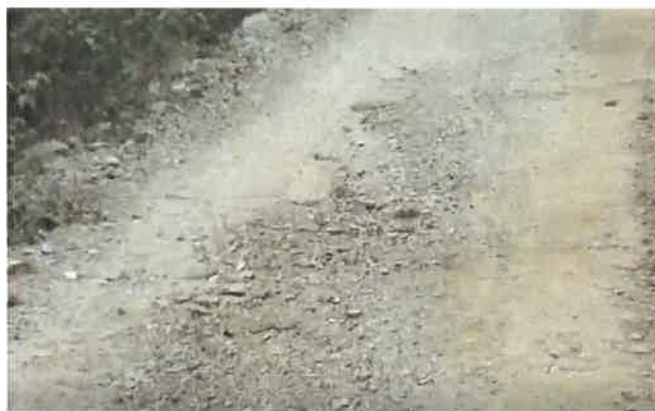
Foto 119: KM 7+400, Erosión en medio de la calzada
