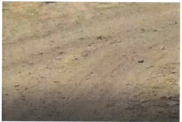
Foto 60: KM 3+700, Ahuellamiento en ambos lados de la calzada
