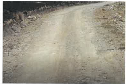
Foto 252: KM 15+700, Bacheo en ambos lados de la calzada
