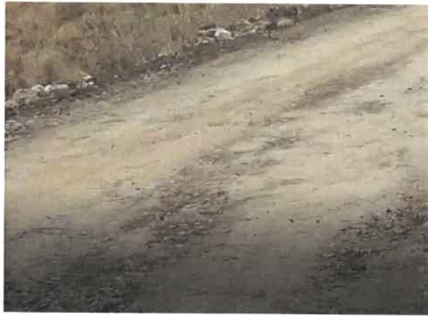
Foto 51: KM 3+150, Erosion en el centro de la calzada
