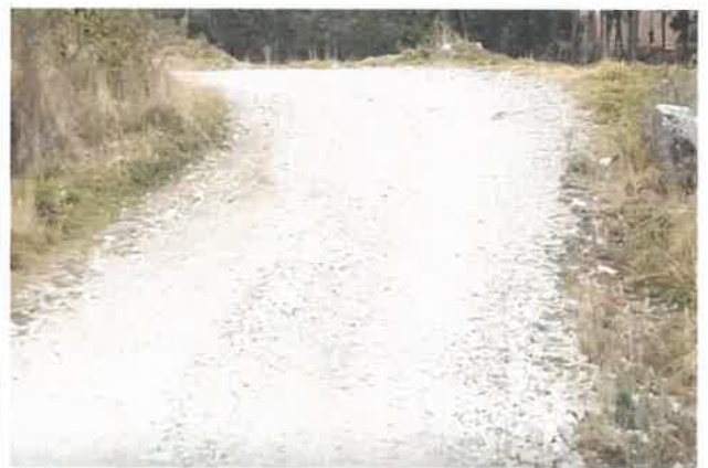
Foto 126: KM 7+850, Ahuellamiento Y Erosión de la calzada
