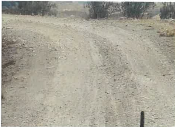
Foto 227: KM 14+100, Ahuellamiento en ambos lados de la calzada
