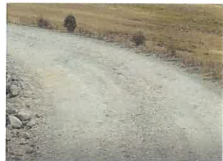
Foto 248: KM 15+450, Ahuellamiento en el lado derecho de la calzada y Erosión
