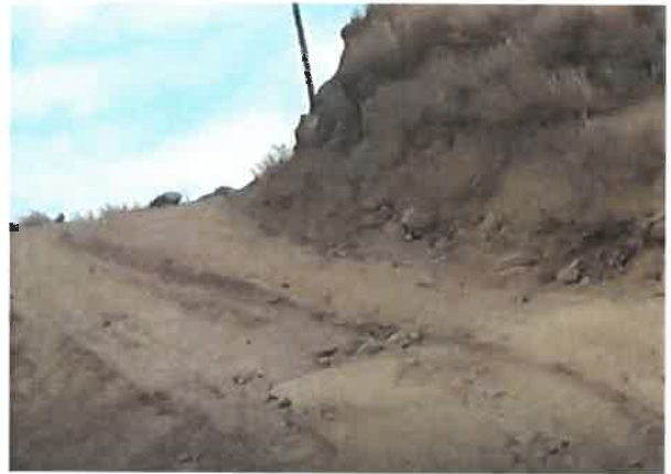
Foto 14: KM 0+850, Bacheo en lado izquierdo de la calzada e
