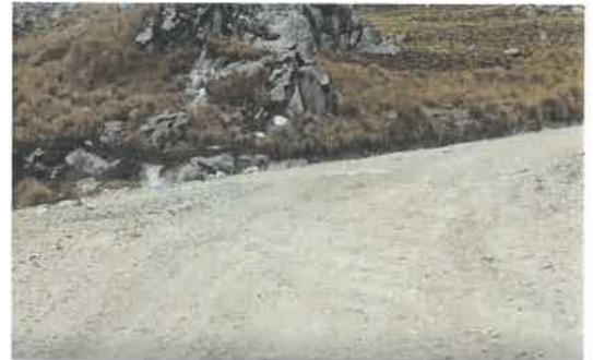
Foto 324: KM 20+200, Bacheo en ambos lados de la calzada
