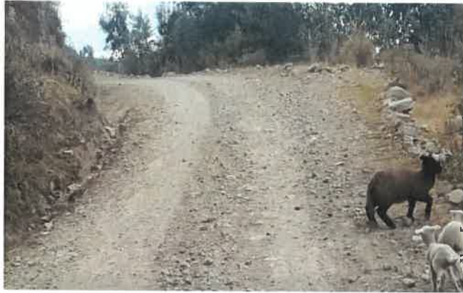
Foto 157: KM 9+800, Ahuellamiento en el lado derecho de la calzada
