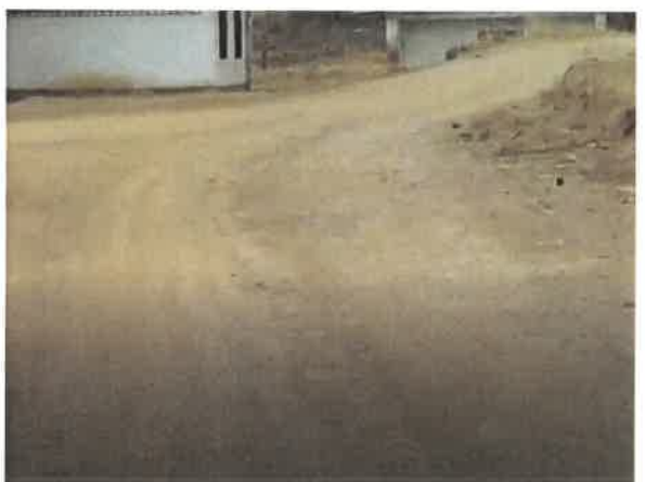
Foto 80: KM 4+950, Erosión al medio de la calzada
