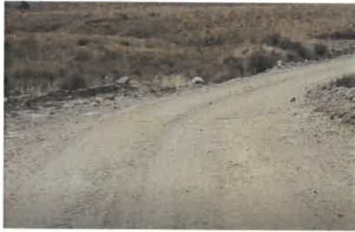
Foto 311: KM 19+400, Ahuellamiento en ambos lados de la calzada
