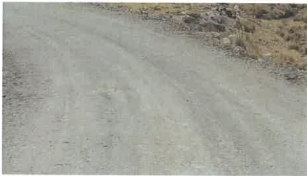
Foto 319: KM 19+900, Ahuellamiento al lado derecho de la calzada
