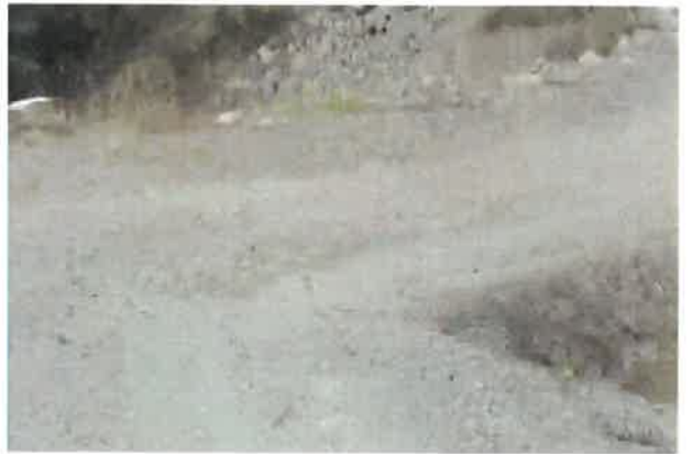
Foto 96: KM 5+950, Ahuellamiento al lado derecho de la calzada
