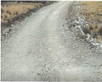
Foto 255: KM 15+900, Bacheo en ambos lados de la calzada
