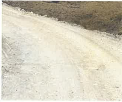
Foto 309: KM 19+300, Ahuellamiento en ambos lados de la calzada
