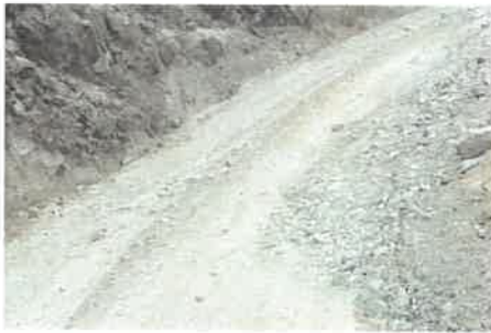
Foto 227: KM 14+150, Bacheo en ambos lados de la calzada
