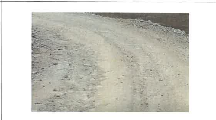
Foto 306: KM 19+100, Erosión al lado izquierdo de la calzada
