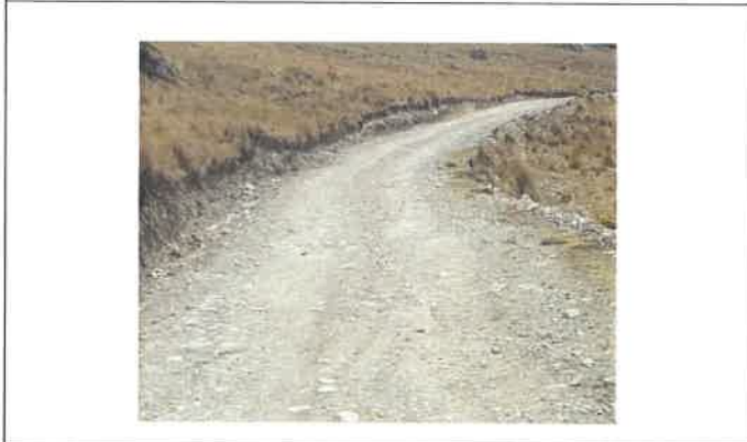
Foto 263: KM 16+400, Bacheo en ambos lados de la calzada
