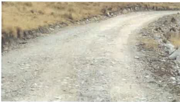
Foto 257: KM 16+050, Bacheo en ambos lados de la calzada
