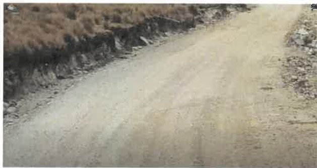
Foto 295: KM 18+400, Bacheo en ambos lados de la calzada
