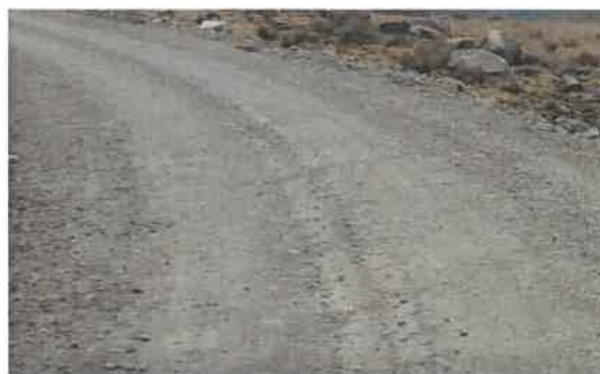
Foto 282: KM 17+600, Encala minado en ambos lados de la calzada
