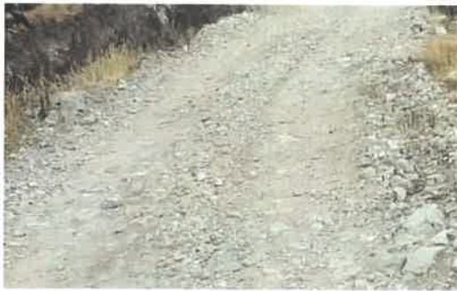
Foto 247: KM 15+400, Bacheo al lado izquierdo de la calzada
