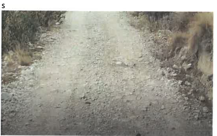
Foto 188: KM 11+700, Bacheo en ambos lados de la calzada
