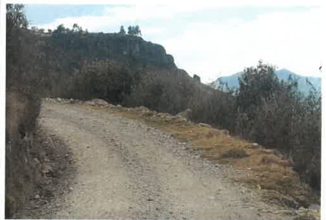
Foto 158: KM 9+850, Ahuellamiento en el lado derecho de la calzada
