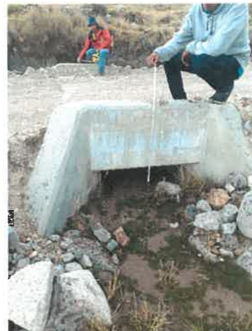
Foto 33: KM 19+900 Vista de salida de alcantarilla obstruida.
