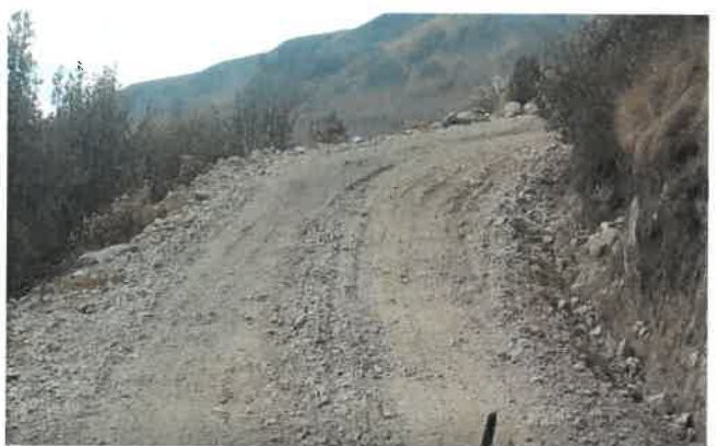
Foto 162: KM 10+100, Erosión en ambos lados de la calzada
