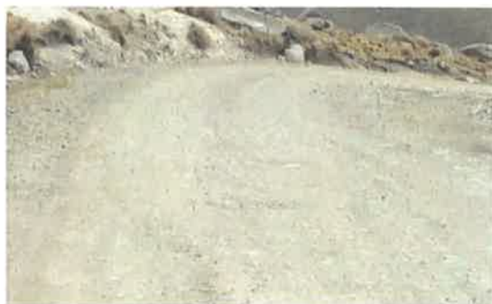
Foto 285: KM 17+800, Bacheo en ambos lados de la calzada
