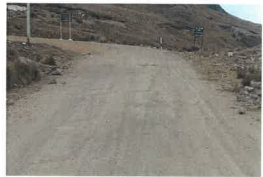
Foto 332: KM 20+700, Bacheo en ambos lados de la calzada
