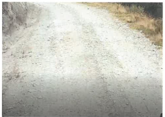
Foto 184: KM 11+450, Bacheo en ambos lados de la calzada
