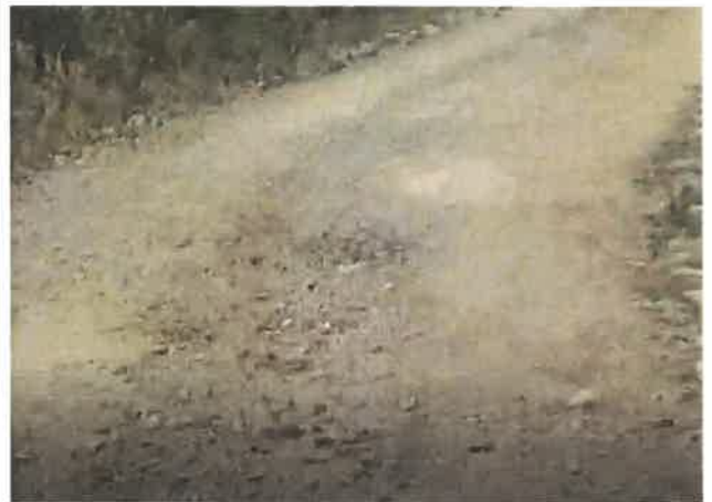
Foto 118: KM 7+350, Bacheo en medio de la calzada
