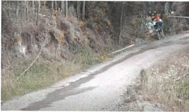
Foto 153: KM 9+550, Erosión al lado izquierdo de la calzada
