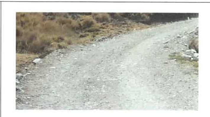
Foto 268: KM 16+700, Ahuellamiento en ambos lados de la calzada
