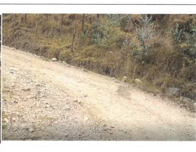
Foto 140: KM 8+700, Ahuellamiento al lado derecho de la calzada y Erosión al izquierdo
