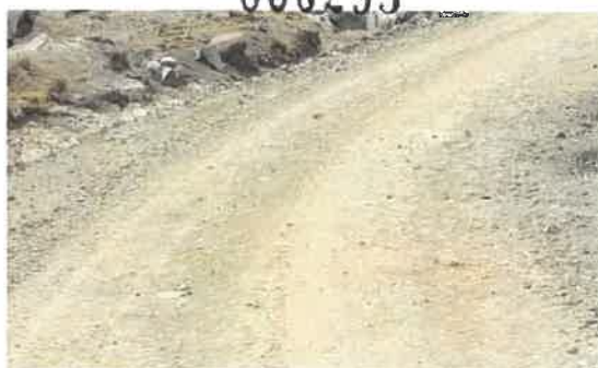
Foto 286: KM 17+850, Bacheo al lado derecho de la calzada
