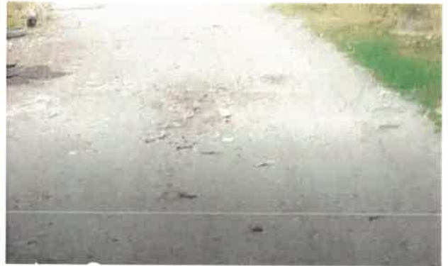
Foto 152: KM 9+450, Bacheo en medio de la calzada
