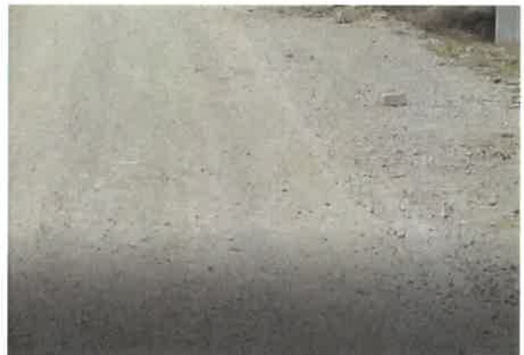
Foto 86: KM 5+350, Ahuellamiento en ambos lados de la calzada
