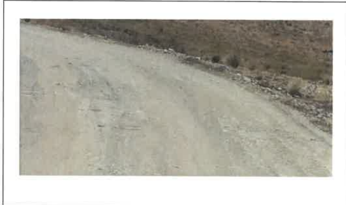
Foto 261: KM 16+300, Ahuellamiento en ambos lados de la calzada
