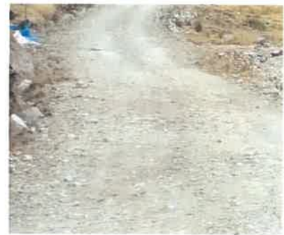
Foto 254: KM 15+850, Ahuellamiento en el lado derecho de la calzada
