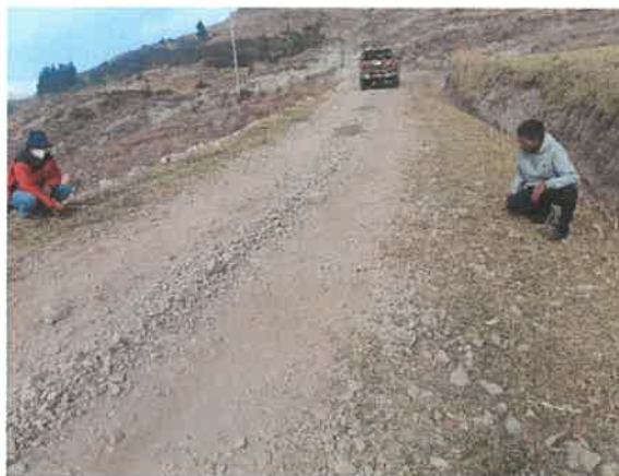
Foto 008: KM 1+500, La vía se encuentra en mal estado.
