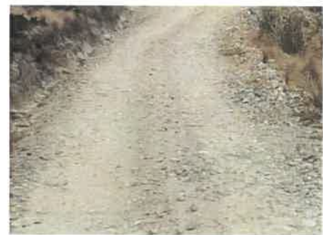
Foto 240: KM 14+950, Ahuellamiento en ambos lados de la calzada
