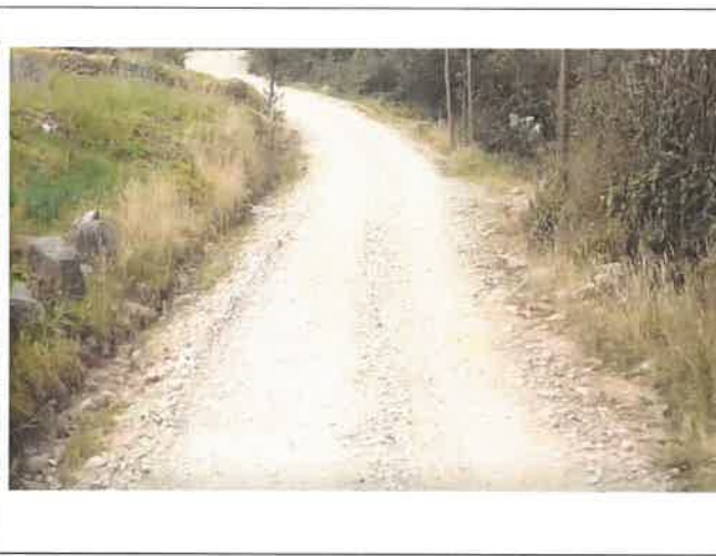
Foto 138: KM 8+600, Ahuellamiento al lado izquierdo de la calzada
