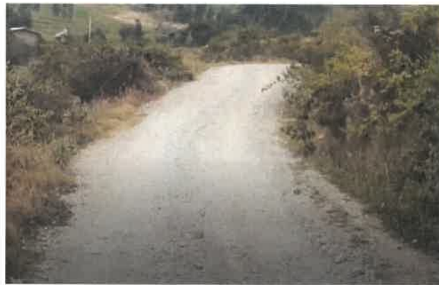
Foto 125: KM 7+800, Ahuellamiento en ambos lados de la calzada
