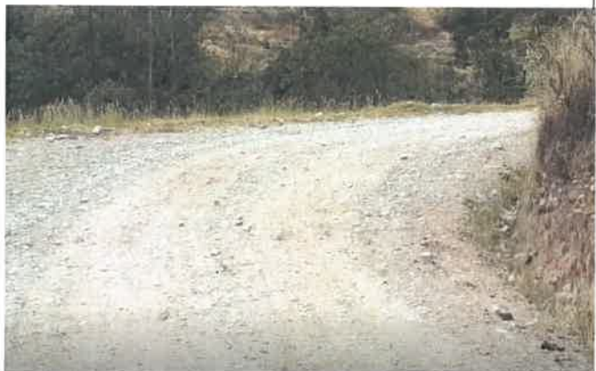
Foto 149: KM 9+300, Encalaminado en toda la calzada
