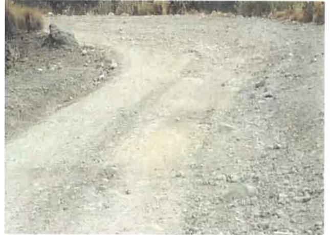
Foto 232: KM 14+400, Erosión en ambos lados de la calzada
