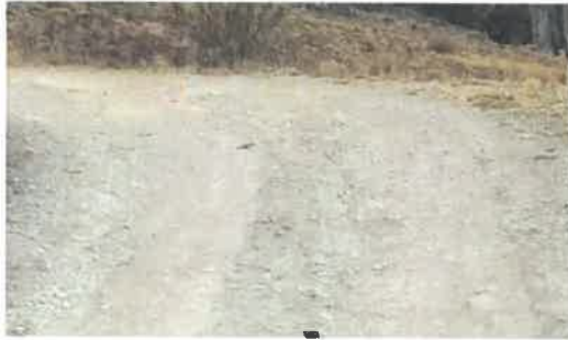
Foto 231: KM 14+400, Erosión en ambos lados de la calzada
