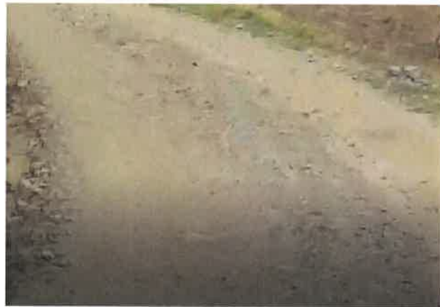
Foto 65: KM 4+050, Ahuellamiento al lado izquierdo de la calzada
