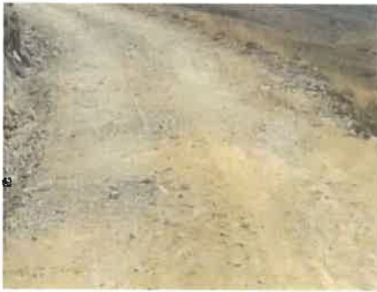
Foto 245: KM 15+300, Bacheo en ambos lados de la calzada
