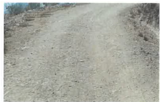
Foto 242: KM 15+100, Ahuellamiento en ambos lados de la calzada
