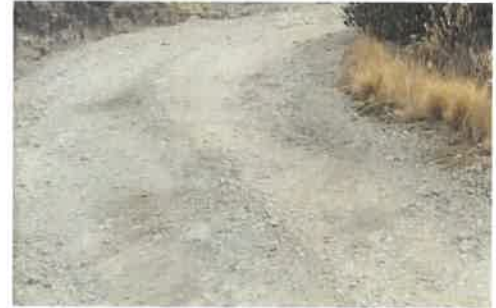
Foto 232: KM 14+450, Erosión en ambos lados de la calzada
