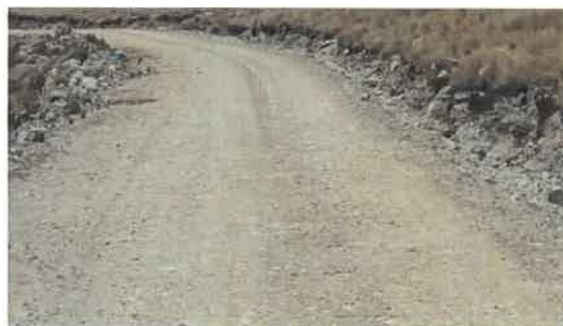
Foto 288: KM 17+950, Bacheo al lado derecho de la calzada
