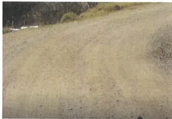
Foto 89: KM 5+550, Ahuellamiento al lado izquierdo de la calzada
