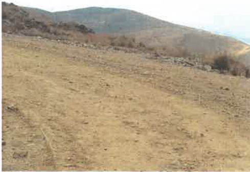
Foto 273: KM 17+050, Ahuellamiento en lado izquierdo de la calzada
