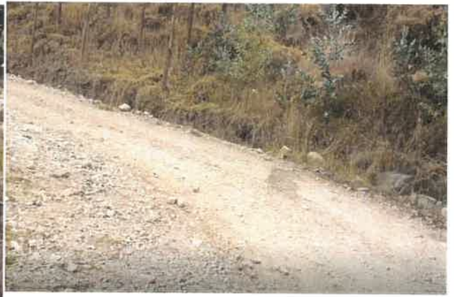
Foto 140: KM 8+700, Ahuellamiento al lado derecho de la calzada y Erosión al izquierdo
