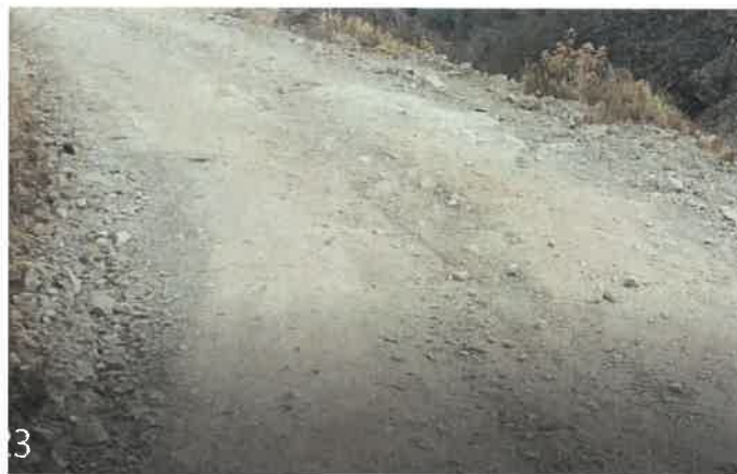
Foto 194: KM 12+100, Erosión en ambos lados de la calzada
