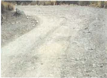
Foto 233: KM 14+550, Ahuellamiento al lado derecho de la calzada y Erosión
