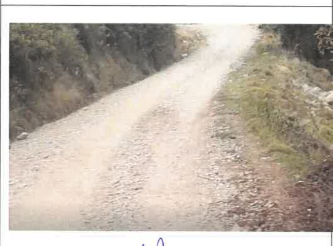
Foto 139: KM 8+650, Erosión en el lado derecho de la calzada
