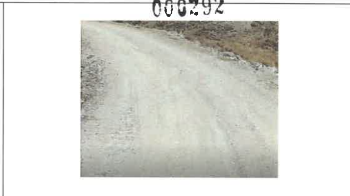
Foto 304: KM 18+950, Erosión en ambos lados de la calzada
