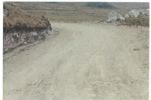
Foto 326: KM 20+350, Erosión en ambos lados de la calzada
