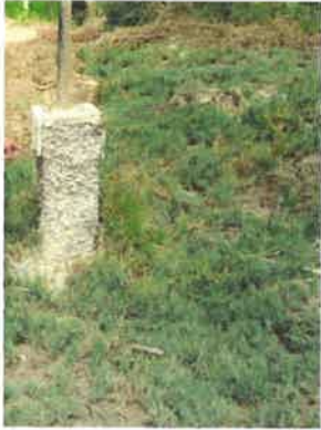
Foto 01: KM 0+800, señal en mal estado, requiere reparación.
