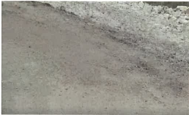
Foto 105: KM 6+550, Bacheo al lado derecho de la calzada
