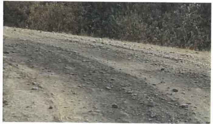
Foto 208: KM 12+900, Ahuellamiento en ambos lados de la calzada
