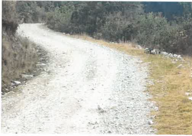
Foto 159: KM 9+900, Ahuellamiento en el lado derecho de la calzada y Erosión a la izquierda
