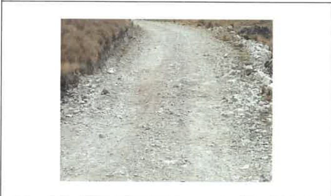
Foto 265: KM 16+550, Erosión en ambos lados de la calzada
