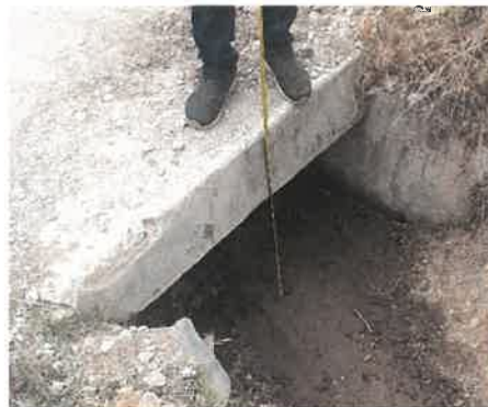
Foto 7: KM 5+570, Vista de salida de alcantarilla con forestación nativa y deteriorada.
