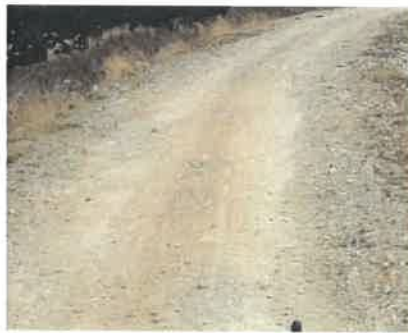
Foto 251: KM 15+650, Bacheo al lado izquierdo de la calzada
