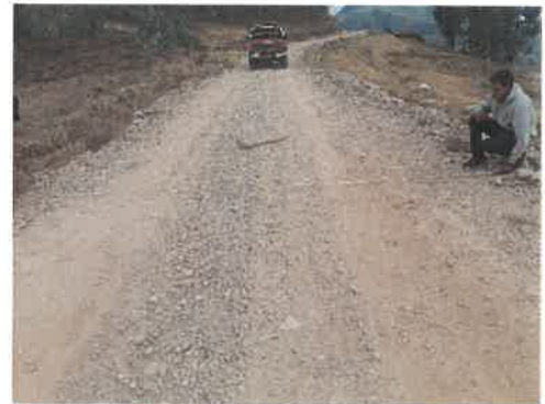
Foto 018: KM 4+000 Ahuellamiento, grueso se encuentra al borde de la vía.
