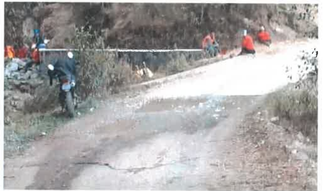
Foto 154: KM 9+600, Bacheo en ambos lados de la calzada
