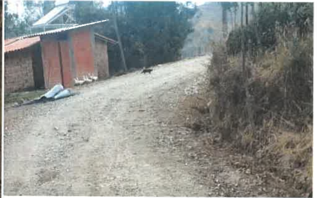
Foto 142: KM 8+850, Encalaminado a la derecha y Erosión a la izquierda
