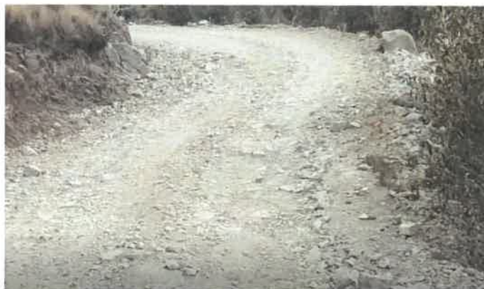
Foto 196: KM 12+200, Erosión en ambos lados de la calzada
