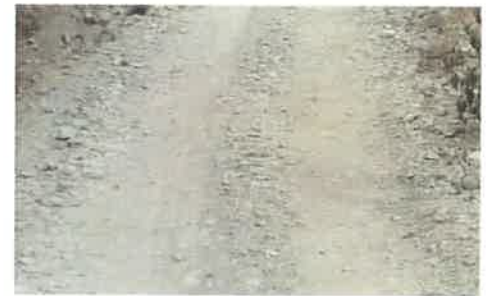
Foto 230: KM 14+350, Bacheo en ambos lados de la calzada
