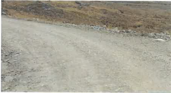
Foto 327: KM 20+400, Encala minado al lado izquierdo de la calzada
