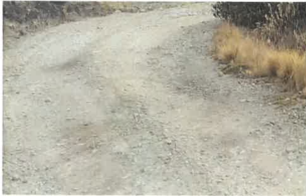
Foto 231: KM 14+350, Bacheo en ambos lados de la calzada
