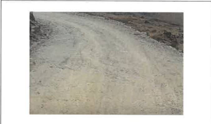
Foto 305: KM 19+050, Erosión al centro de la calzada
