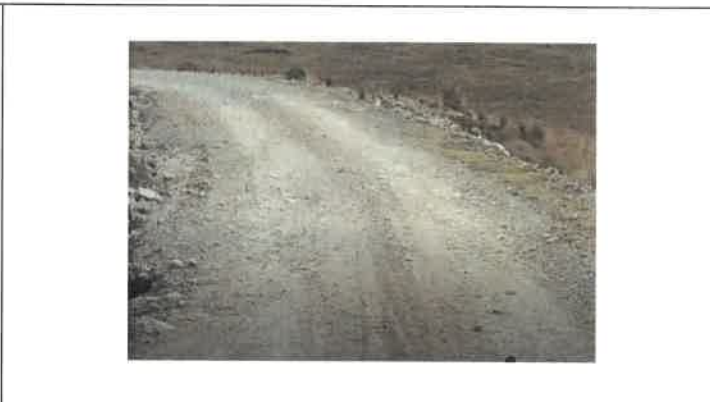
Foto 262: KM 16+350, Erosión en ambos lados de la calzada
