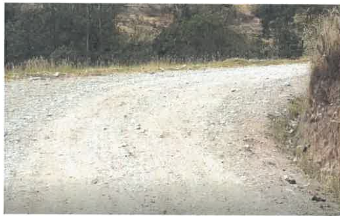
Foto 149: KM 9+300, Encalaminado en toda la calzada
