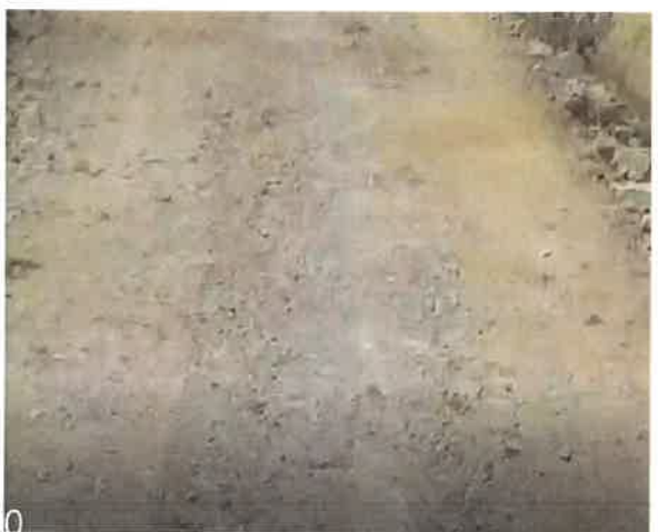
Foto 68: KM 4+200, Ahuellamiento al centro de la calzada
