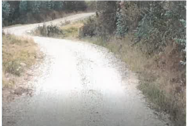
Foto 146: KM 9+100, Ahuellamiento en el lado derecho de la calzada
