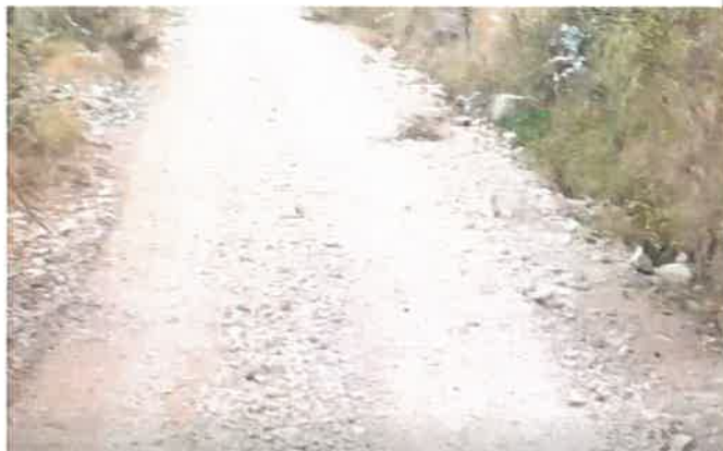
Foto 145: KM 9+050 Ahuellamiento al lado izquierdo de la calzada
