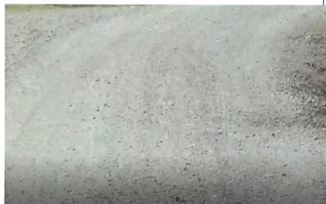
Foto 113: KM 7+050, Ahuellamiento en ambos lados de la calzada
