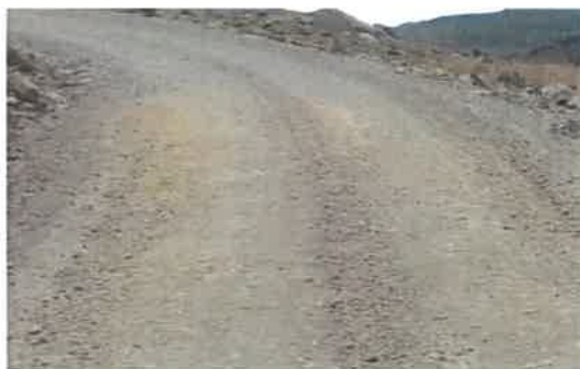
Foto 281: KM 17+550, Erosión al lado izquierdo de la calzada
