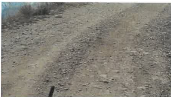
Foto 215: KM 13+400, Bacheo en el lado derecho de la calzada
