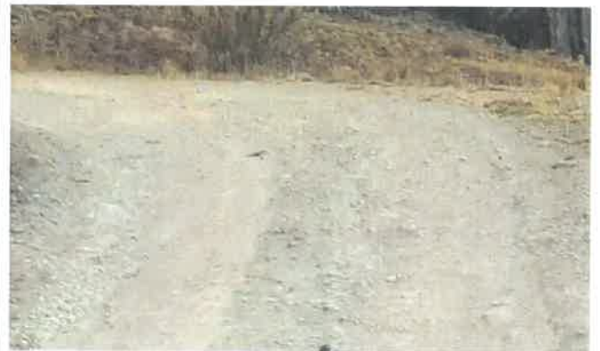
Foto 230: KM 14+300, Erosión en ambos lados de la calzada
