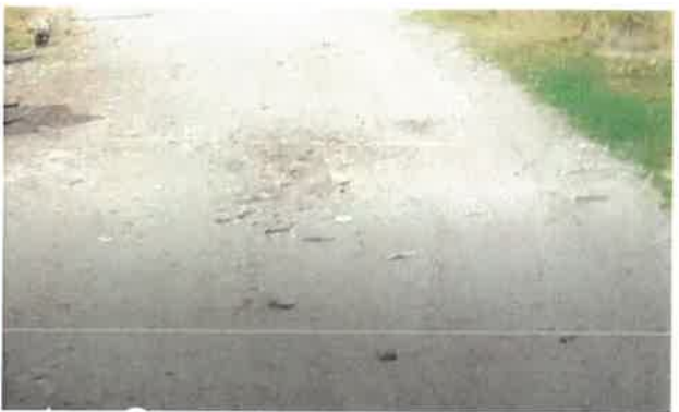
Foto 152: KM 9+450, Bacheo en medio de la calzada
