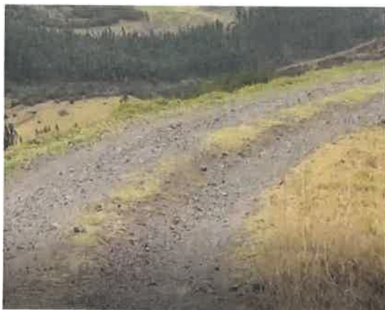
Foto 05: KM 0+300, Ahuellamiento en lado derecho de calzada
