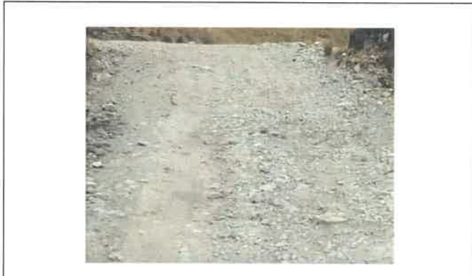
Foto 267: KM 16+650, Ahuellamiento en ambos lados de la calzada
