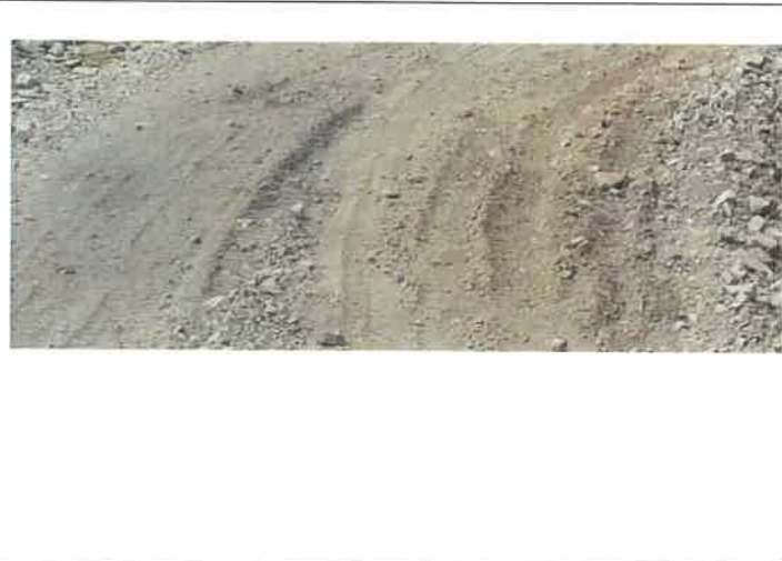
Foto 166: KM 10+350, Erosión en medio de la calzada
