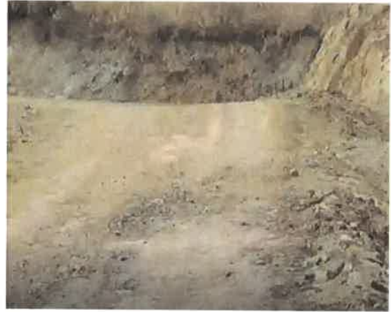
Foto 52: KM 3+200, Bacheo al lado derecho de la calzada
