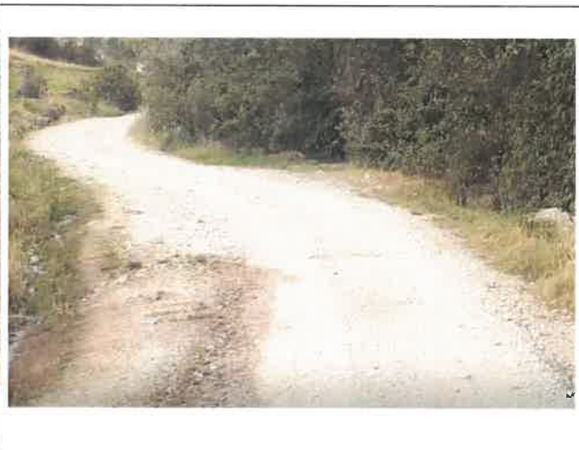
Foto 136: KM 8+450, Erosión en el lado izquierdo de la calzada
