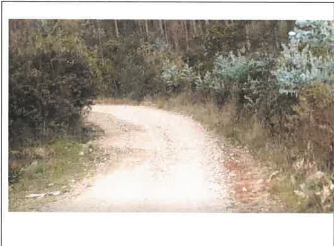
Foto 135: KM 8+400, Erosión en ambos lados de la calzada
