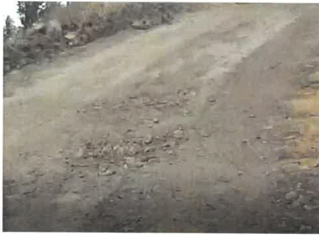
Foto 57: KM 3+550, Bacheo en centro de la calzada
