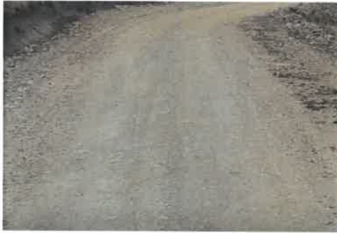
Foto 317: KM 19+800, Bacheo al lado izquierdo de la calzada
