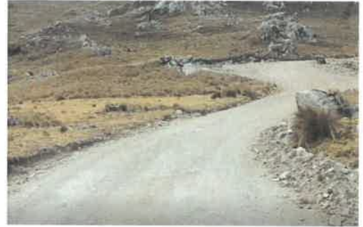
Foto 322: KM 20+100, Encala minado en ambos lados de la calzada
