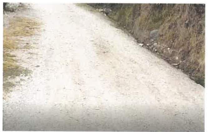
Foto 160: KM 9+950, Bacheo en ambos lados de la calzada
