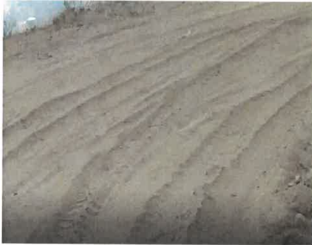
Foto 29: KM 1+800, Arenamiento en toda la calzada
