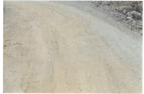
Foto 318: KM 19+850, Ahuellamiento al lado izquierdo de la calzada
