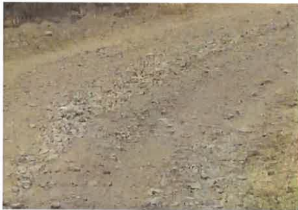
Foto 47: KM 2+900, Ahuellamiento en ambos lados de la calzada
