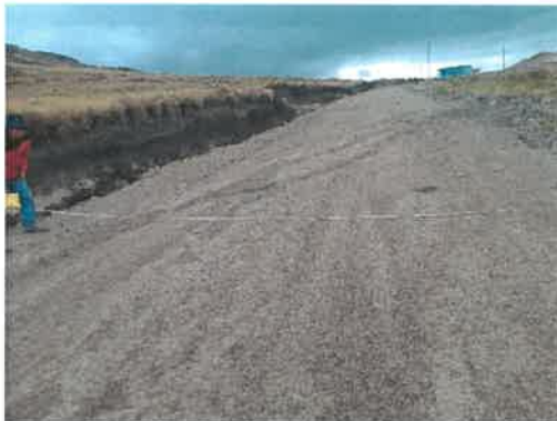
Foto 083: KM 20+250, Vista toma de información en campo, detallando el ancho de plataforma.
