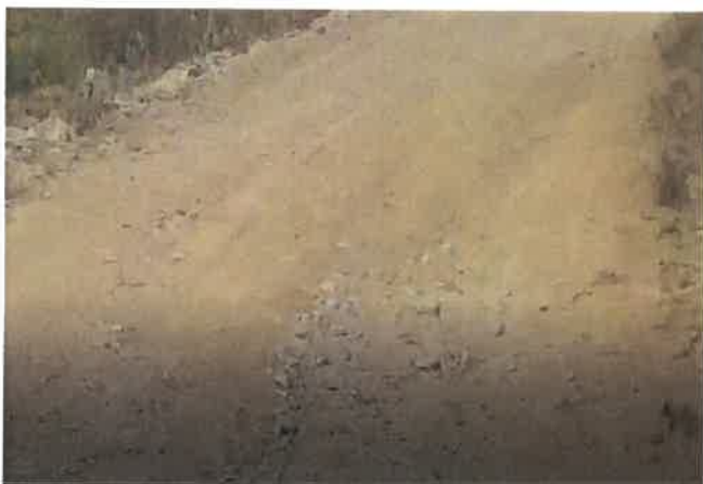
Foto 61: KM 3+800, Bacheo y Ahuellamiento en todo la calzada
