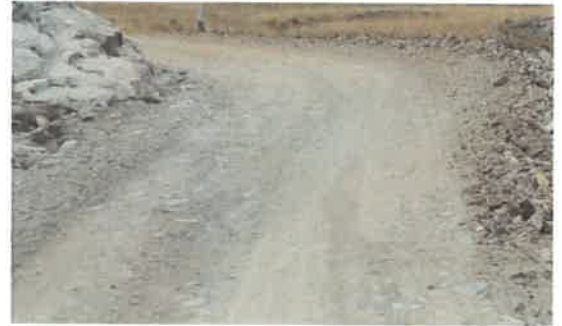
Foto 328: KM 20+450, Bacheo en ambos lados de la calzada
