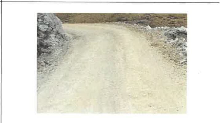
Foto 308: KM 19+200, Bacheo en ambos lados de la calzada
