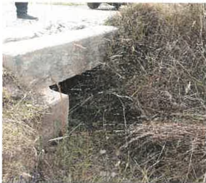
Foto 11: KM 6+395 Vista de Ingreso de alcantarilla obstruida por forestación nativa y deteriorada.
