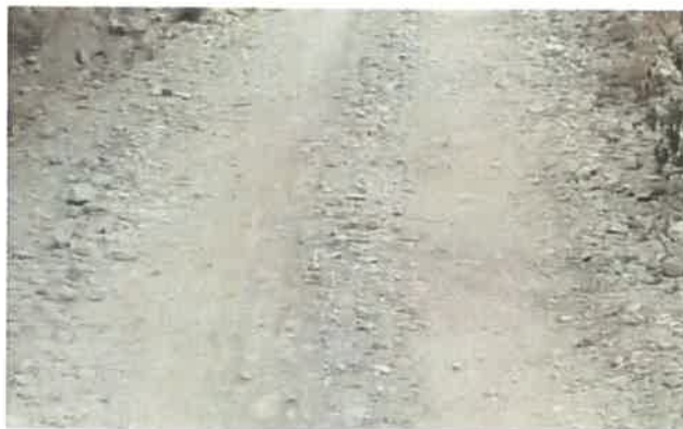
Foto 229: KM 14+200, Bacheo en ambos lados de la calzada
