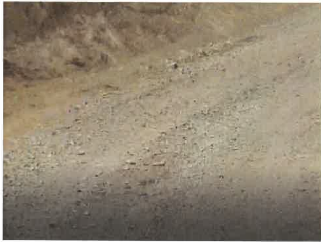
Foto 45: KM 2+800, Ahuellamiento en ambos lados de la calzada
