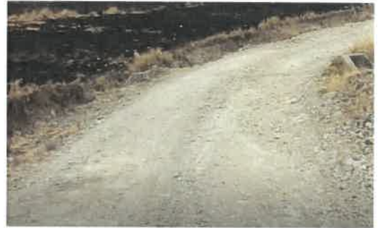
Foto 250: KM 15+600, Encala minado en ambos lados de la calzada
