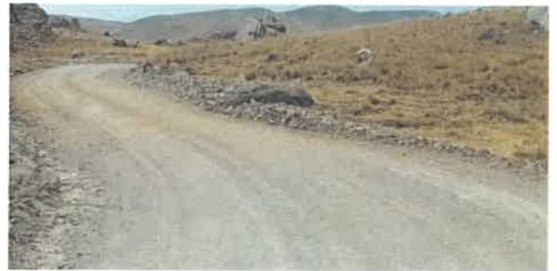
Foto 320: KM 19+950, Bacheo en ambos lados de la calzada
