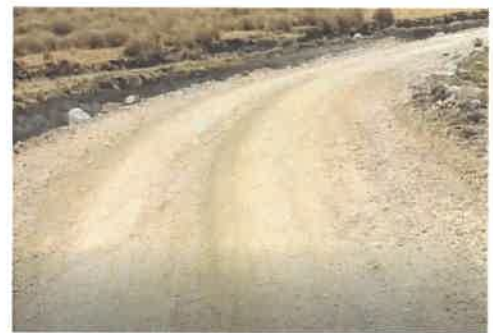
Foto 302: KM 18+850, Ahuellamiento en ambos lados de la calzada
