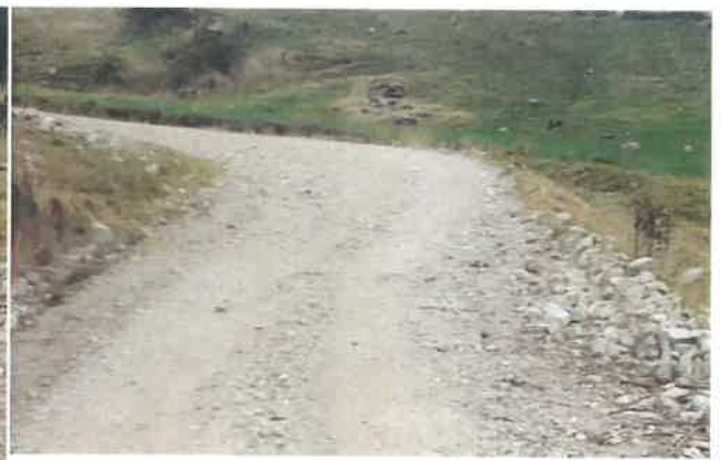
Foto 148: KM 9+200, Ahuellamiento y Erosión en toda la calzada
