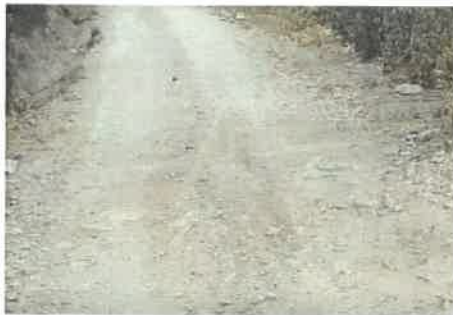
Foto 229: KM 14+300, Erosión en ambos lados de la calzada
