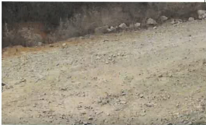
Foto 123: KM 7+650, Erosión en ambos lados de la calzada
