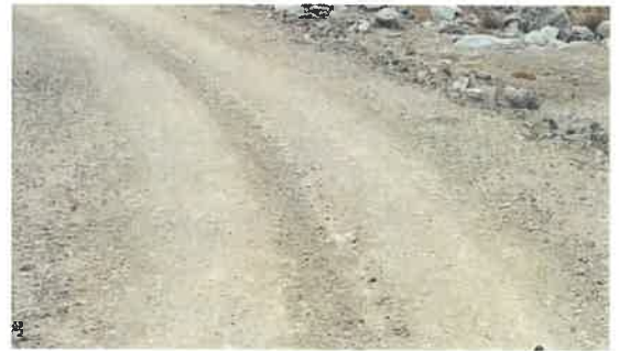
Foto 292: KM 18+200, Bacheo en ambos lados de la calzada
