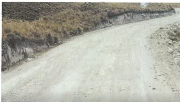
Foto 325: KM 20+300, Ahuellamiento en ambos lados de la calzada
