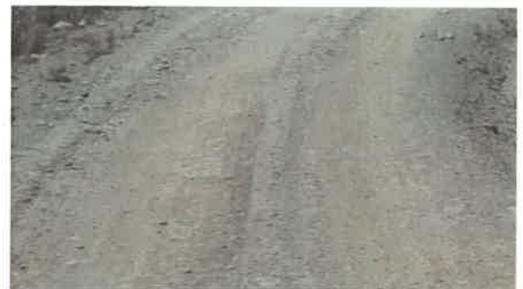
Foto 216: KM 13+450, Ahuellamiento en ambos lados de la calzada
