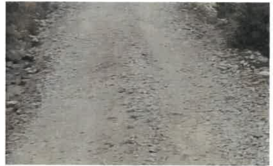
Foto 238: KM 14+850, Bacheo en ambos lados de la calzada
