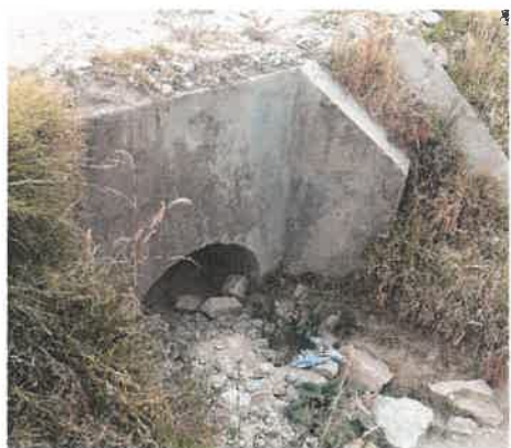
Foto 8: KM 5+580 Vista de Ingreso de alcantarilla obstruida por forestación nativa
