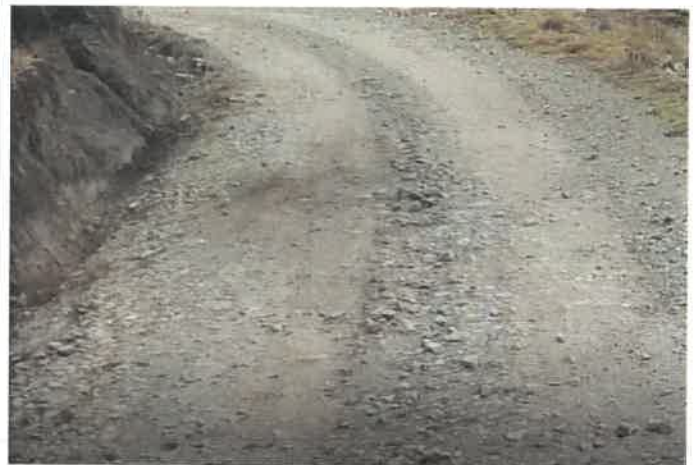
Foto 182: KM 11+350, Bacheo en ambos lados de la calzada
