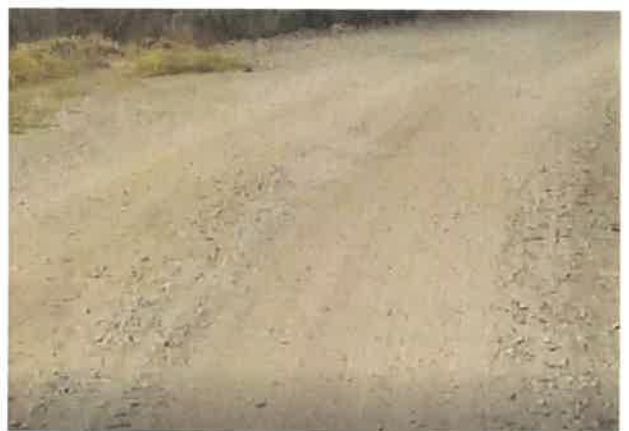
Foto 90: KM 5+600, Ahuellamiento en ambos lados de la calzada
