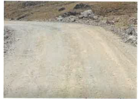
Foto 312: KM 19+450, Erosión al lado izquierdo de la calzada
