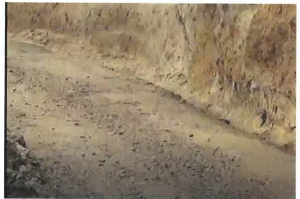
Foto 58: KM 3+600, Ahuellamiento al lado izquierdo de la calzada
