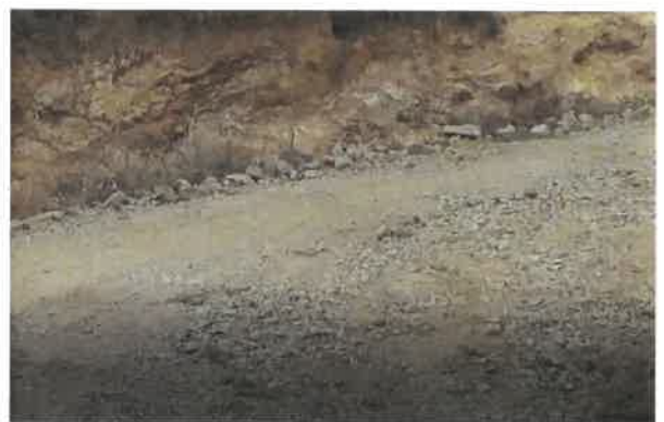
Foto 72: KM 4+450, Bacheo y Encalaminado en la calzada
