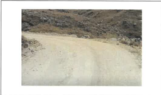
Foto 303: KM 18+900, Erosión en ambos lados de la calzada
