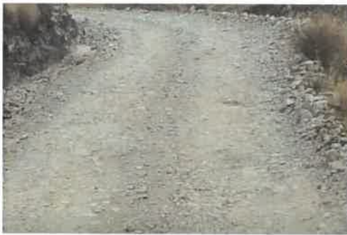
Foto 239: KM 14+900, Erosión en ambos lados de la calzada
