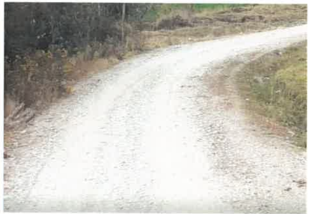
Foto 150: KM 9+350, Ahuellamiento en ambos lados de la calzada
