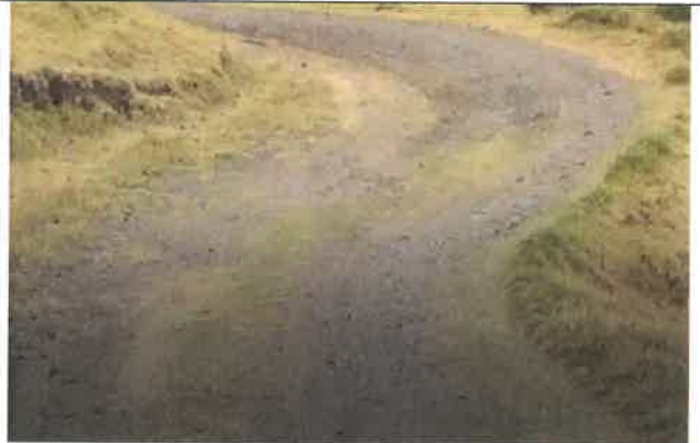
Foto 04: KM 0+200, Ahuellamiento y Erosión al lado izquierdo de la calzada
