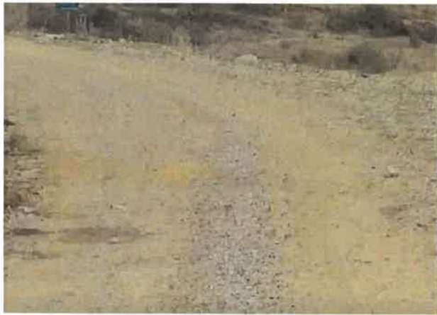
Foto 75: KM 4+650, Ahuellamiento en ambos lados de la calzada
