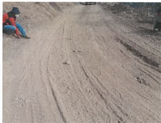
Foto 006: KM 1+000, Ahuellamiento, pérdida de material grueso.
