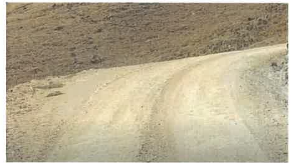
Foto 274: KM 17+100, Encala minado en ambos lados de la calzada
