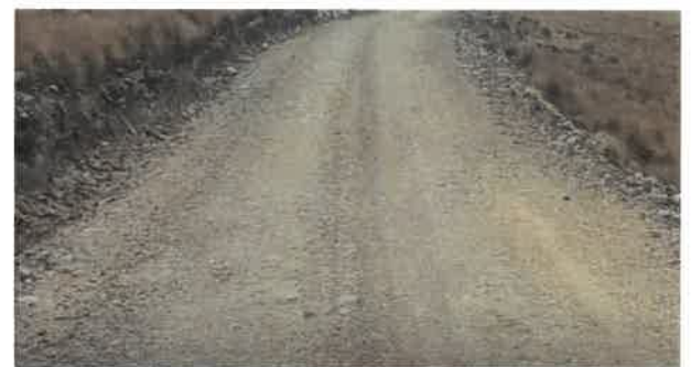
Foto 278: KM 17+350, Ahuellamiento en ambos lados de la calzada
