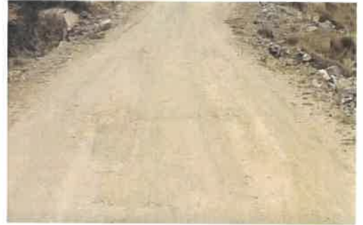
Foto 310: KM 19+350, Ahuellamiento en ambos lados de la calzada
