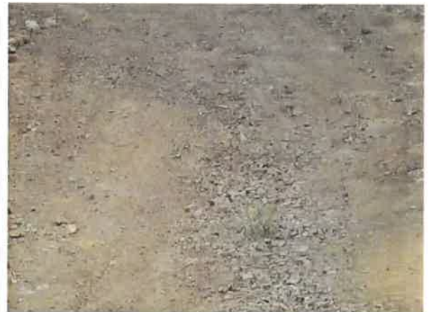
Foto 48: KM 2+950, Erosión y Encala minado en toda la calzada
