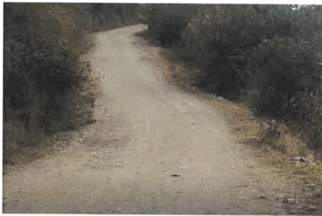
Foto 155: KM 9+650, Bacheo al lado izquierdo de la calzada
