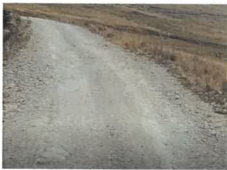
Foto 253: KM 15+800, Bacheo al lado derecho de la calzada
