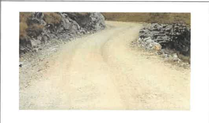
Foto 307: KM 19+150, Ahuellamiento en ambos lados de la calzada
