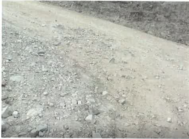
Foto 187: KM 11+650, Bacheo al lado izquierdo de la calzada
