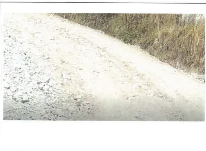
Foto 0164: KM 10+200, Ahuellamiento y Erosión en toda la calzada
