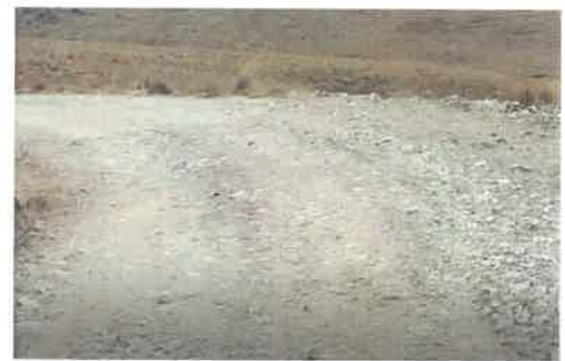
Foto 260: KM 16+200, Ahuellamiento en ambos lados de la calzada
