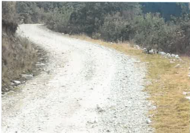
Foto 159: KM 9+900, Ahuellamiento en el lado derecho de la calzada y Erosión a la izquierda
