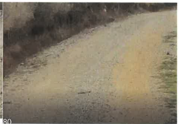
Foto 124: KM 7+700, Ahuellamiento al lado izquierdo de la calzada
