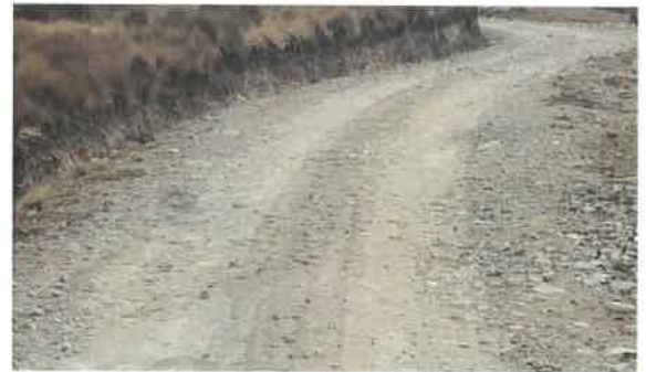
Foto 258: KM 16+100, Bacheo en ambos lados de la calzada
