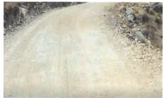
Foto 294: KM 18+350, Erosión al lado izquierdo de la calzada
