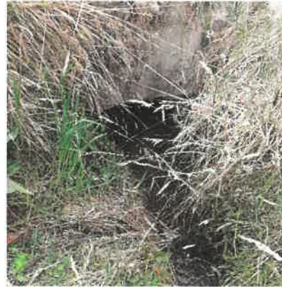
Foto 16: KM 9+780, Vista de salida de alcantarilla obstruida por forestación nativa y deteriorada.
