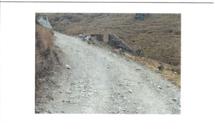
Foto 266: KM 16+600, Erosión en ambos lados de la calzada
