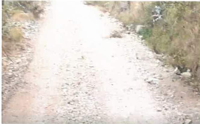
Foto 145: KM 9+050 Ahuellamiento al lado izquierdo de la calzada
