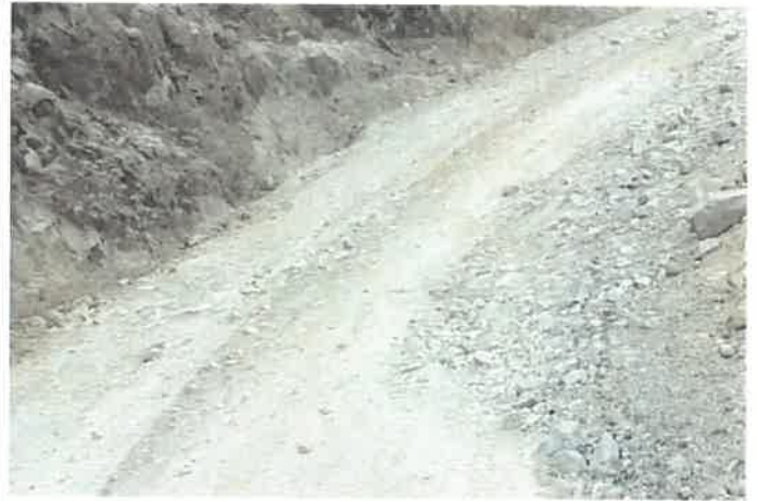
Foto 226: KM 14+050, huellamiento al lado derecho de la calzada y Erosión
