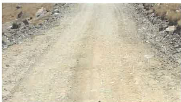
Foto 287: KM 17+900, Ahuellamiento en ambos lados de la calzada
