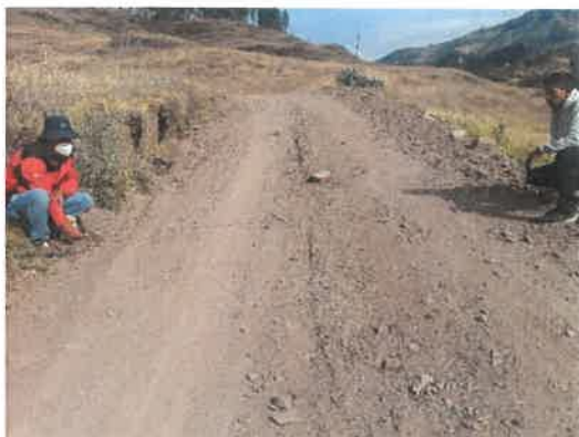
Foto 005: KM 0+750, Ahuellamiento, pérdida de material fino y el material grueso se encuentra al borde de la vía.
