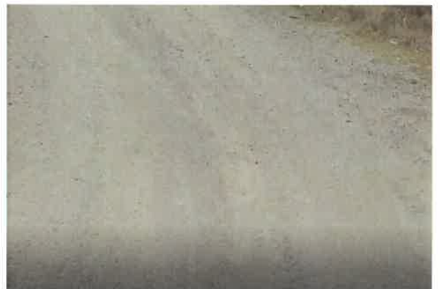
Foto 84: KM 5+200, Erosion al centro de calzada.
