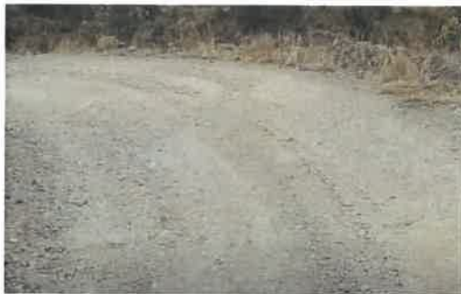
Foto 235: KM 14+650, Erosión en ambos lados de la calzada
