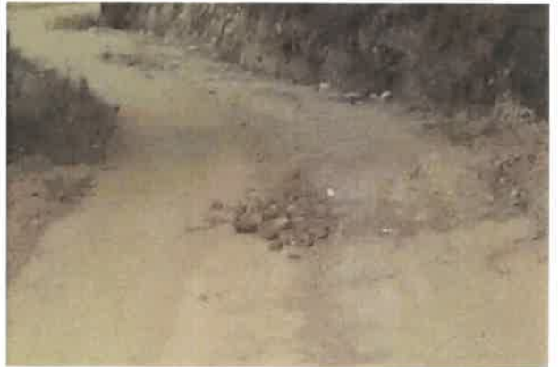
Foto 78: KM 4+850, Bacheo al lado derecho de la calzada
