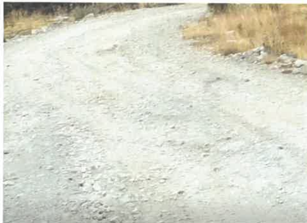
Foto 233: KM 14+450, Erosión en ambos lados de la calzada
