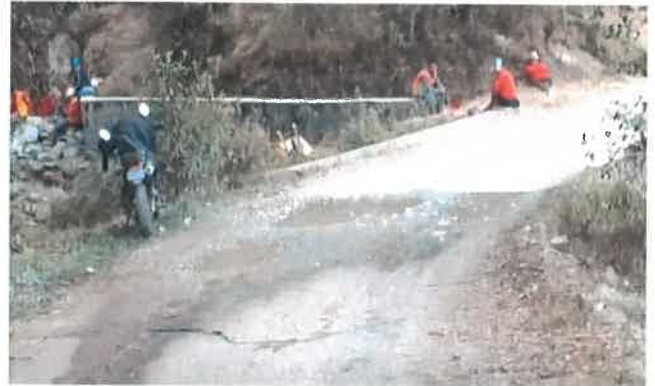
Foto 154: KM 9+600, Bacheo en ambos lados de la calzada
