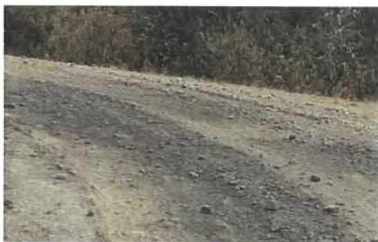
Foto 207: KM 12+900, Ahuellamiento en ambos lados de la calzada
