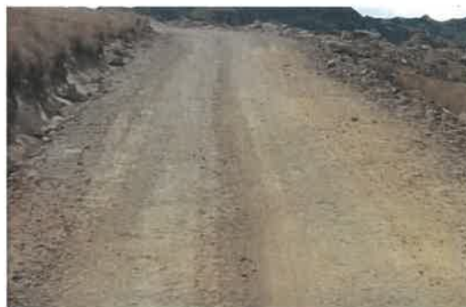
Foto 280: KM 17+450, Encala minado en ambos lados de la calzada
