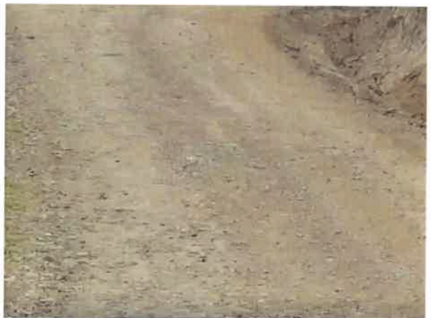
Foto 54: KM 3+350, Erosion y Encalaminado en la calzada
