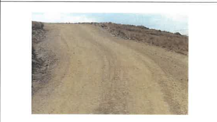
Foto 272: KM 16+950, Encala minado en ambos lados de la calzada
