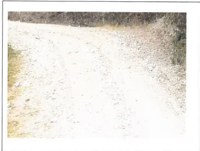
Foto 163: KM 10+150, Ahuellamiento en ambos lados de la calzada
