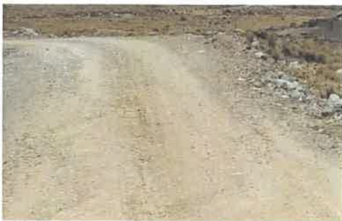
Foto 301: KM 18+800, Ahuellamiento en ambos lados de la calzada
