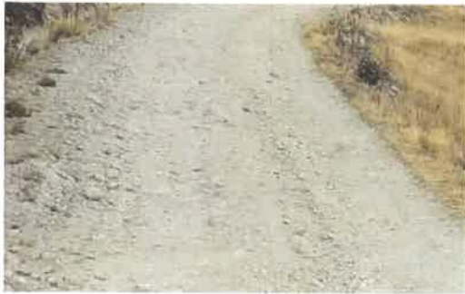
Foto 249: KM 15+550, Ahuellamiento en el lado derecho de la calzada
