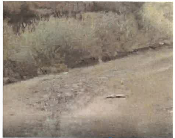
Foto 46: KM 2+850, Bacheo al lado izquierdo de la calzada
