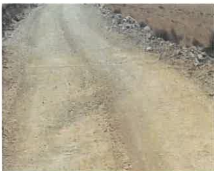
Foto 279: KM 17+400, Ahuellamiento en ambos lados de la calzada
