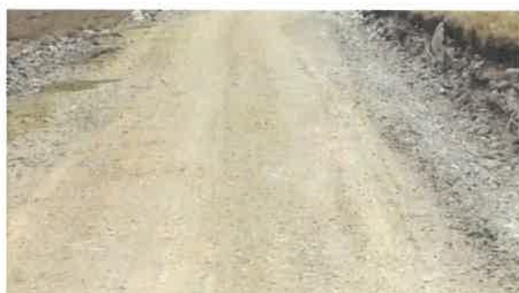
Foto 290: KM 18+100, Erosión al centro de la calzada
