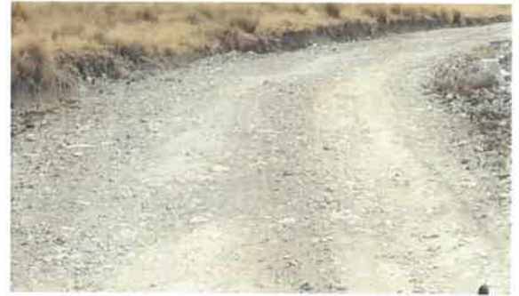
Foto 256: KM 15+950, Bacheo en ambos lados de la calzada
