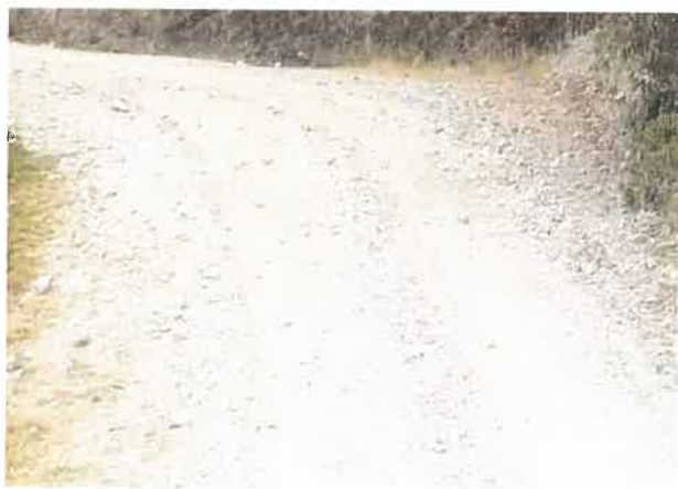
Foto 163: KM 10+150, Ahuellamiento en ambos lados de la calzada
