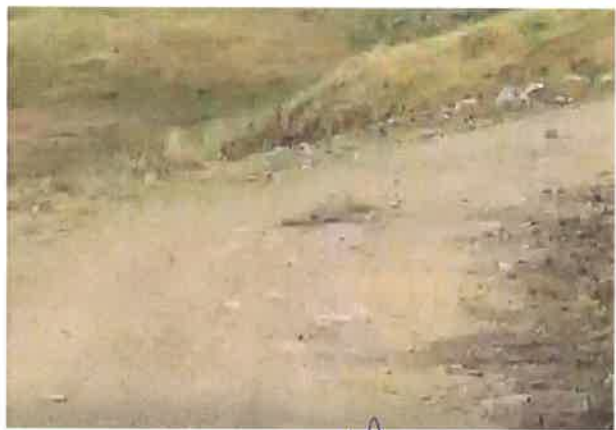
Foto 79: KM 4+900, Ahuellamiento al lado derecho de la calzada
