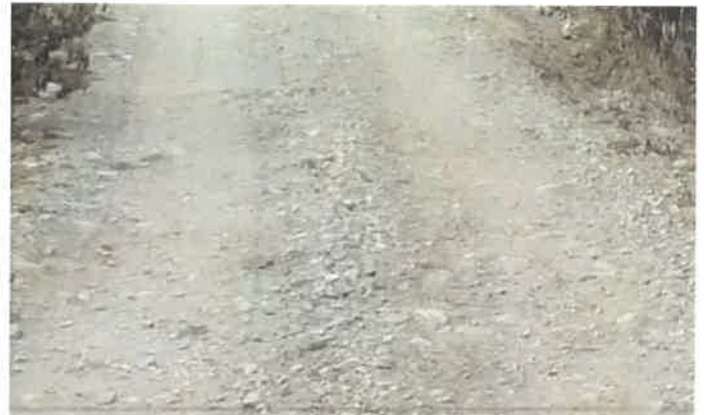
Foto 224: KM 13+900, Bacheo en ambos lados de la calzada
