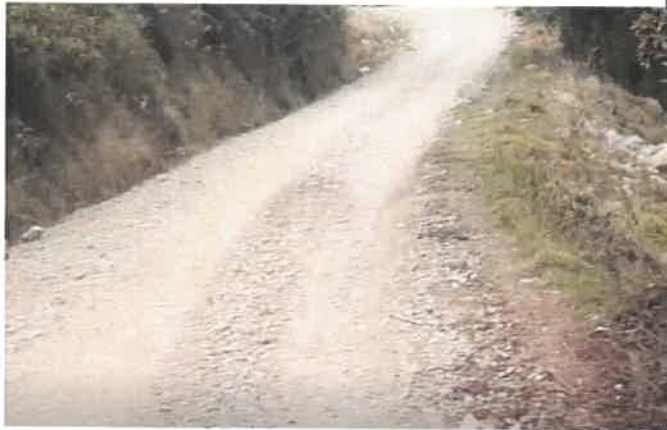
Foto 139: KM 8+650, Erosión en el lado derecho de la calzada
