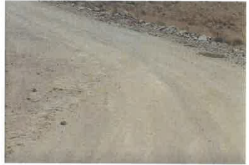
Foto 316: KM 19+700, Bacheo en ambos lados de la calzada
