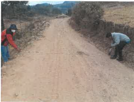
Foto 017: KM 3+750 Pérdida de material fino y ahuellamiento.
