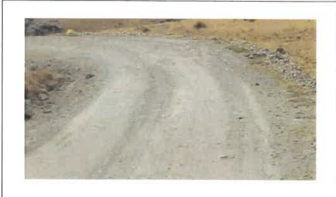
Foto 269: KM 16+800, Encala minado en ambos lados de la calzada
