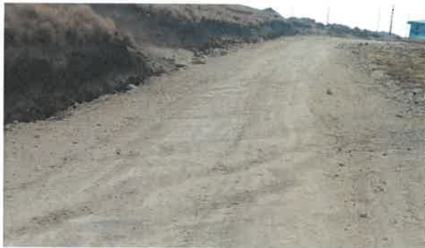
Foto 331: KM 20+650, Encala minado en ambos lados de la calzada
