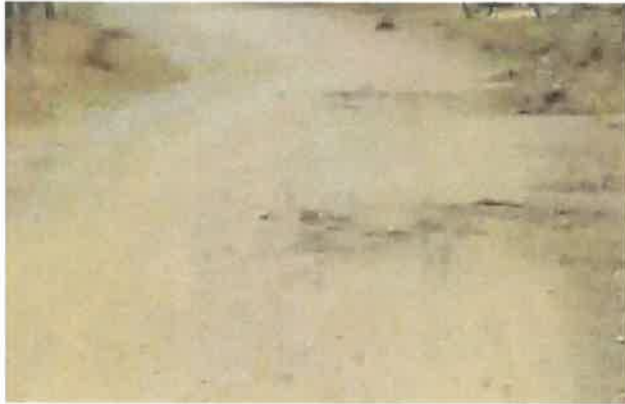
Foto 81: KM 5+050, Bacheo al lado derecho de la calzada
