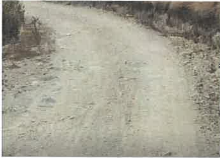
Foto 243: KM 15+150, Bacheo en ambos lados de la calzada
