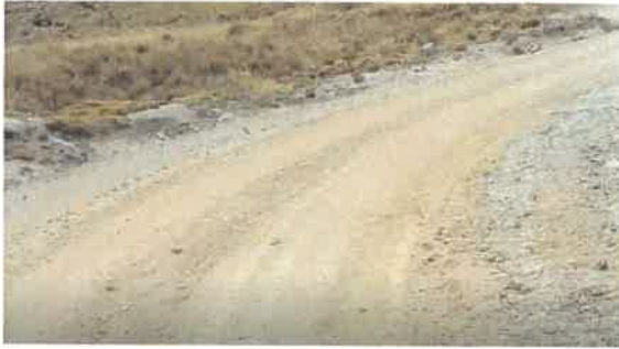
Foto 315: KM 19+650, Encala minado en ambos lados de la calzada
