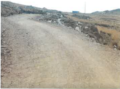
Foto 329: KM 20+550, Erosión al centro de la calzada
