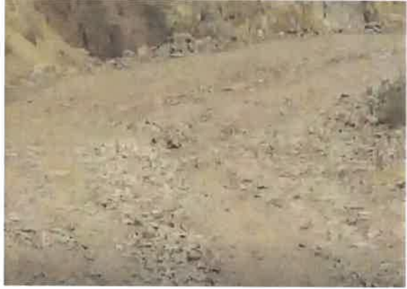
Foto 40: KM 2+450, Encalaminado en ambos lados de la calzada
