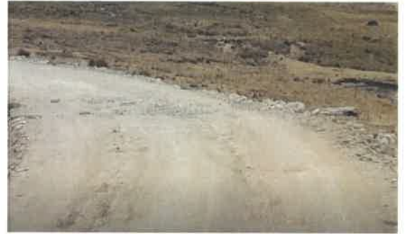
Foto 298: KM 18+600, Erosión en ambos lados de la calzada
