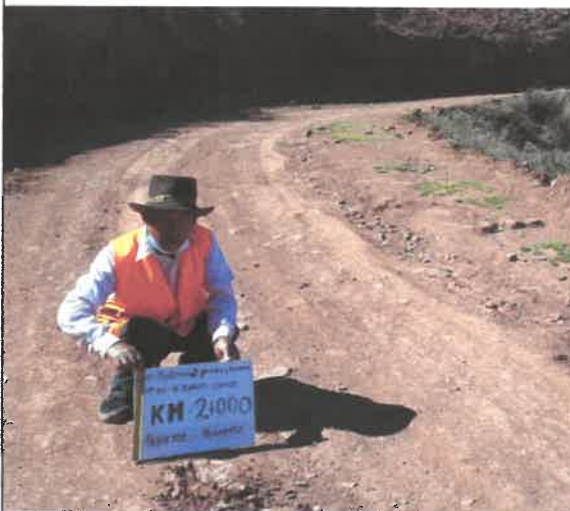
FOTO N° 03: Perdida o Ausencia de Material de afirmado.
