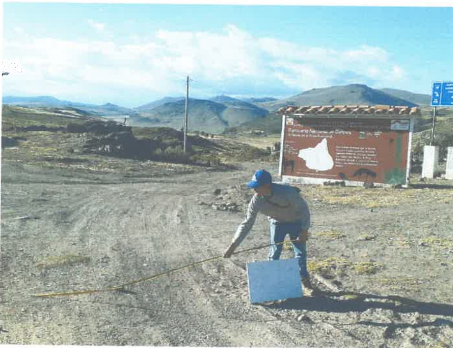
FOTO N° 01: señal informativa 00 + 000, se encuentra en buen estado.
