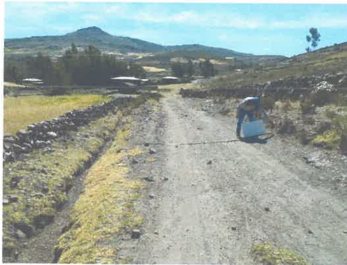
FOTO N° 05 Se puede apreciar el estado de la superficie de rodadura entre el Km 9+ 001- Km 10 + 000
