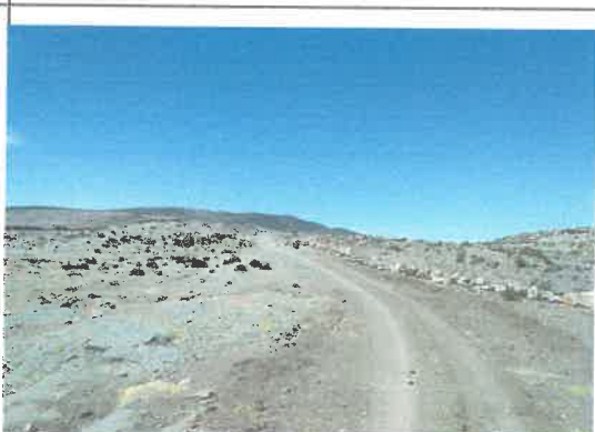
Foto 18: KM 10+300 al 11+000, Erosion - Baches
