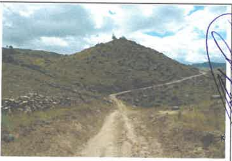
Foto 06: KM 01 + 550 al 01 + 650 erosion.
