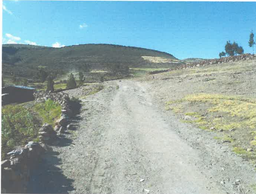
FOTO N° 01 Se puede apreciar el estado de la superficie de rodadura entre el Km 00+000 - Km 02 +000
