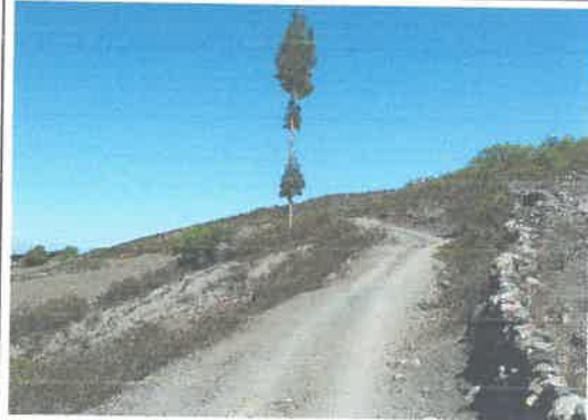
Foto 32: KM 13+850 al 14+300, erosion Baches
