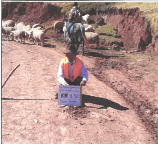
FOTO N° 01: No existe Afirmado.
