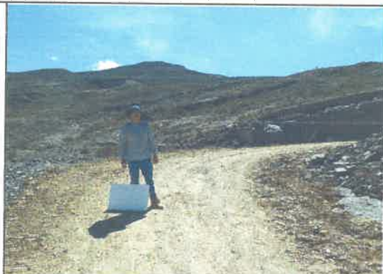
Foto 14: KM 7+750 al 9+400, Erosion Baches
