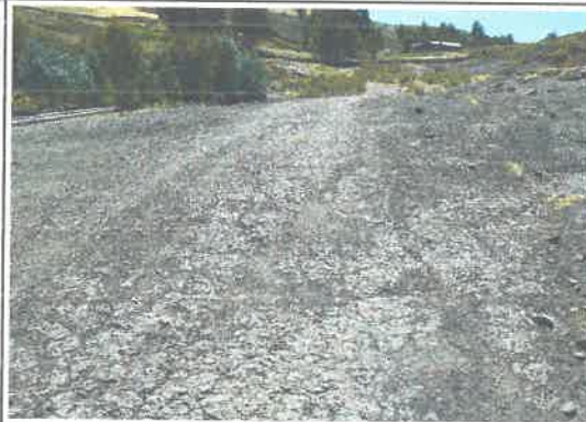
Foto 04: KM 01 + 500 al 02 + 650, Deformacion - Erosion - Baches
