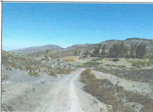
Foto 28: KM 12+600 al 12+700, Erosion - baches
