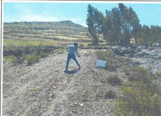
Foto 06: KM 2 + 700 al 4 + 400, Deformacion - Erosion - Baches
