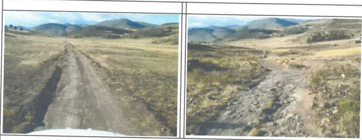
foto 02: cuneta KM 00 + 000 al 01 + 950 requiere limpieza.
