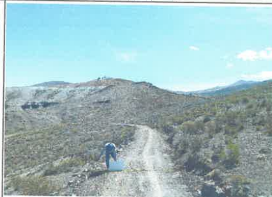
Foto 20: KM 11+050 al 11+400, Erosion - Baches
