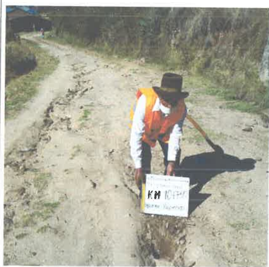
FOTO N° 2: Ausencia de Material de afirmado.
