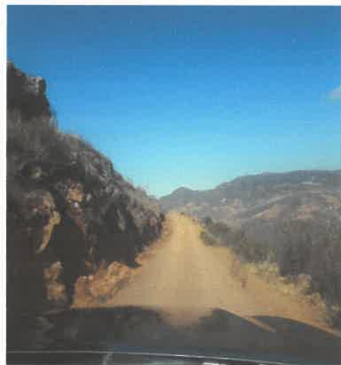
FOTO N° 02 : Ausencia de Material de Afirmado.
