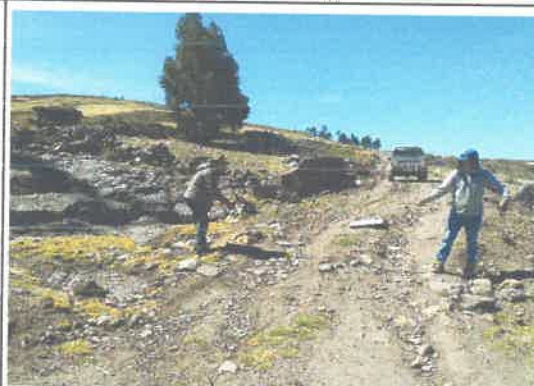
Foto 08: KM 4 +450 al 5+300, Deformacion - Erosion - Baches
