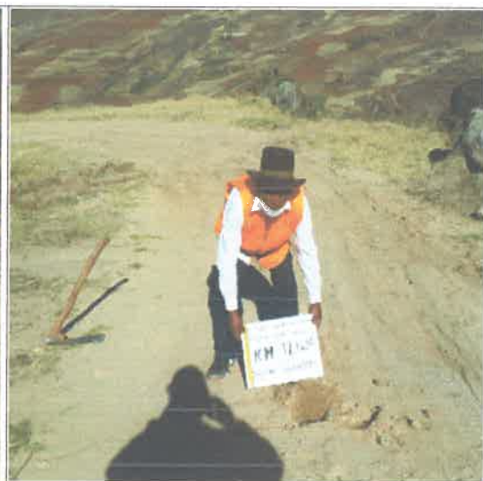
FOTO N° 10: Ausencia de Material de afirmado.
