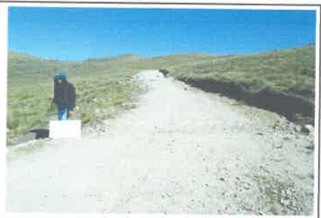
Foto 15: KM 04 + 000 al 04 + 500 deformacion y erosion.
