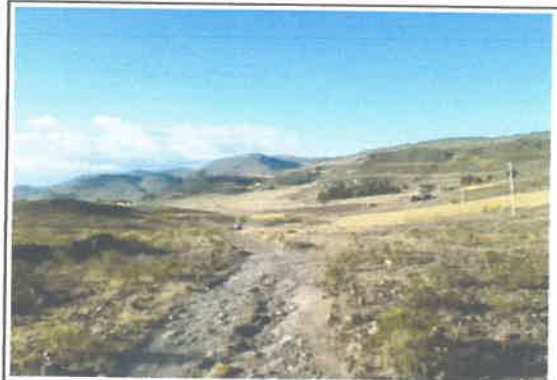
foto 02: KM 0+500 AL 1+000, erosion y baches.
