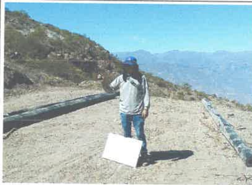
Foto 36: KM 14+950 al 15+469, Erosion Baches
