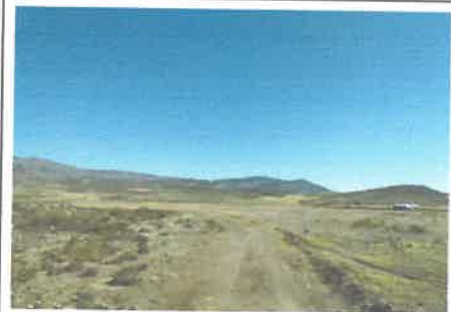
Foto 18: KM 05 + 600 al 05 + 650 deformación y erosión.
