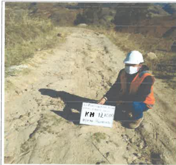
FOTO N° 9: Ausencia de Material de afirmado.
