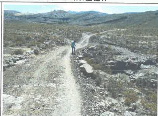
Foto 26: KM 12+300 al 12+550, Erosion - Baches
