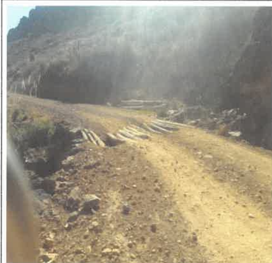
FOTO N° 03: No existe Afirmado.
