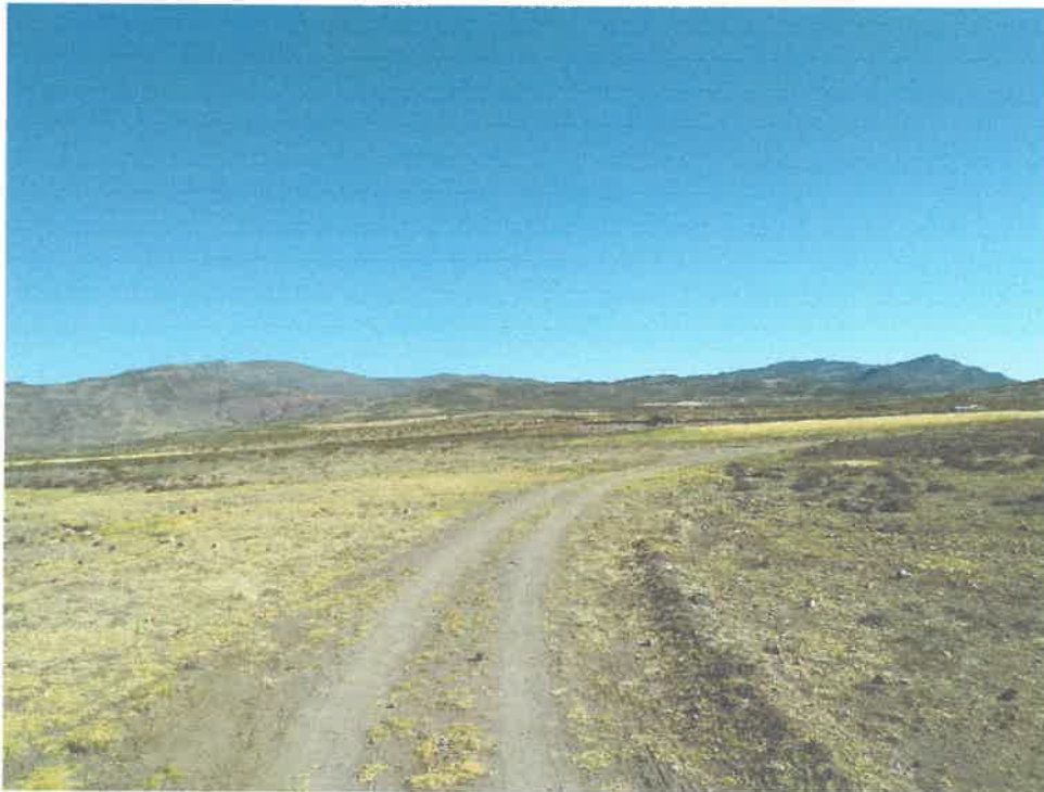
FOTO N° 03 Se puede apreciar el estado de la superficie de rodadura entre el Km 4 + 000- Km 5 + 000
