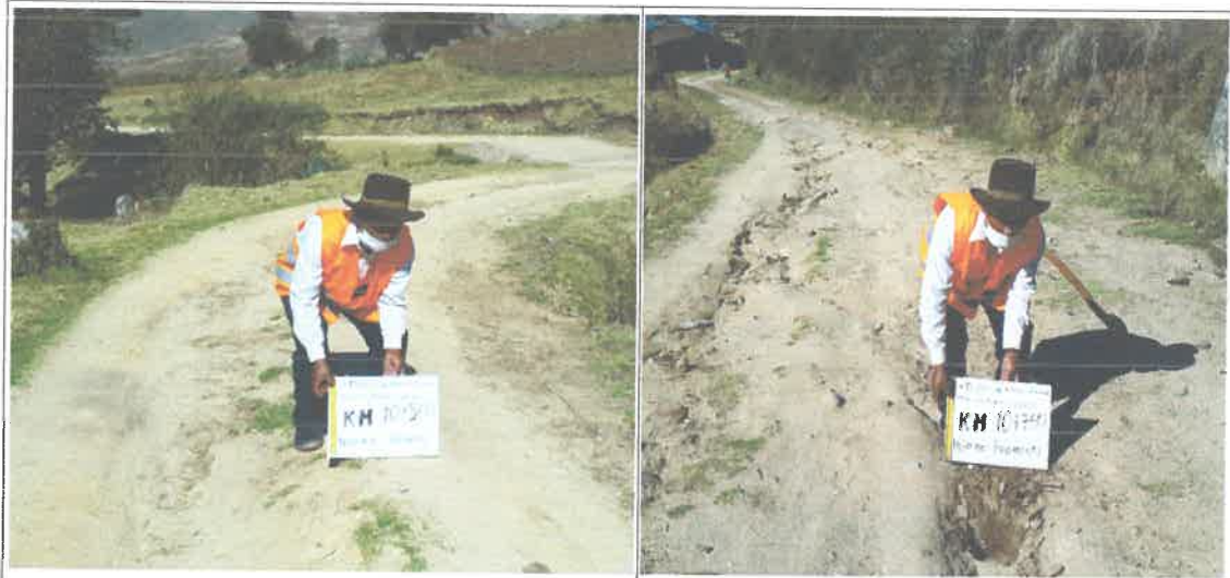
FOTO N° 5: Perdida o Ausencia de Material de afirmado.
