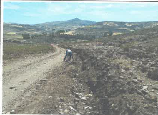
foto 03: KM 00 + 250 al 01 + 500, Deformacion - Erosion - Baches
