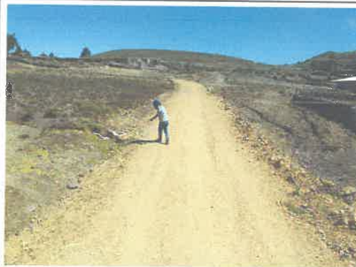
Foto 10: KM 5 +950 al 6+000 , erosion y baches
