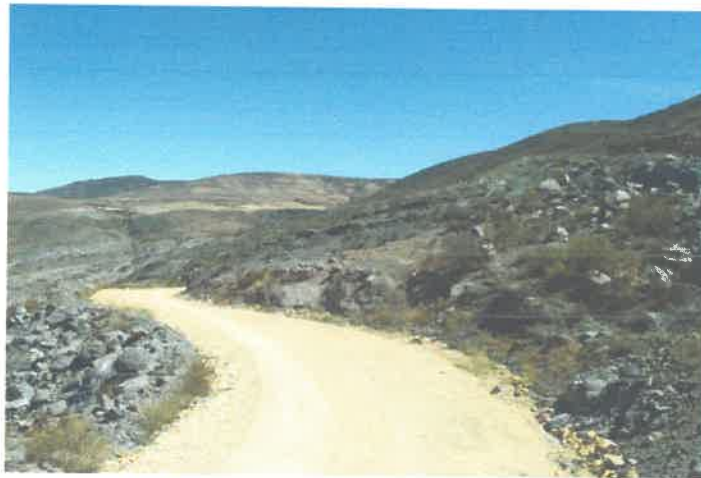
FOTO N° 03: la foto muestra que en la vía no existen hitos kilométricos.
