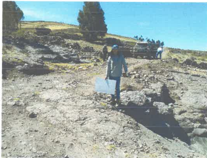
FOTO N° 06 Se puede apreciar el estado de la superficie de rodadura entre el Km 10 + 001- Km 12 + 000
