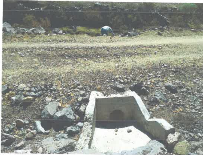
FOTO N° 02. Se requiere intervención o manteniendo.
