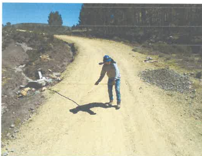
FOTO N° 05 Se puede apreciar el estado de la superficie de rodadura entre el Km 6 + 000- Km 9+ 000
