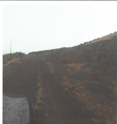
FOTO N° 04: No existe Afirmado.
