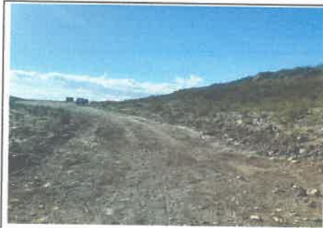
foto 01: KM 00 +500 al 02+ 000,baches.
