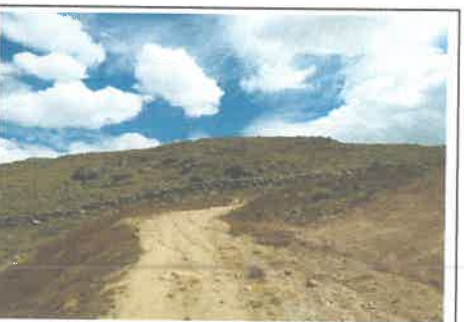
Foto 10: KM 01 + 7000 al 02 + 000 erosion - baches
