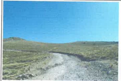
Foto 12: KM 02 + 500 al 03 + 000 erosion-baches
