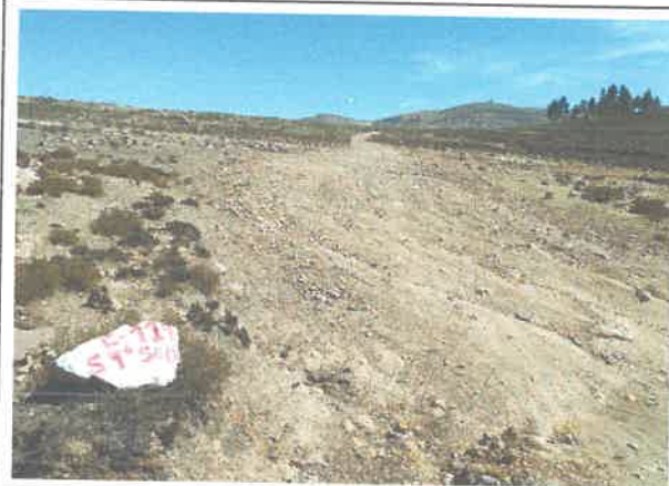
foto 01: KM 1+000 al 3+000, no se cuenta con señalización
