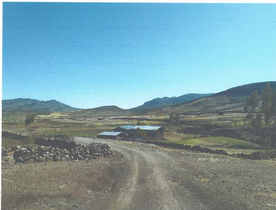
FOTO N° 02 Se puede apreciar el estado de la superficie de rodadura entre el Km 2 + 001- Km 4 + 000
