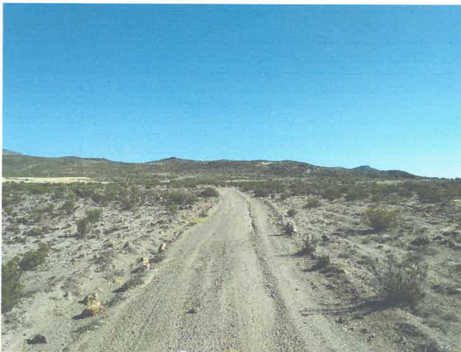
FOTO N° 05 Se puede apreciar el estado de la superficie de rodadura entre el Km 5 + 000- Km 6+ 000
