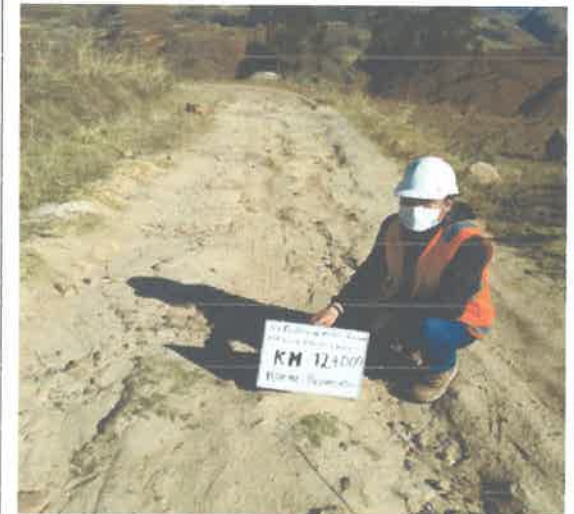
FOTO N° 11: Ausencia de Material de afirmado.
