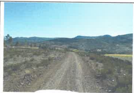
Foto 13: KM 03 + 000 al 03 + 500 erosion-baches
