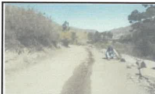
Foto 42: km 11+700 al 12+000, Presencia de erosion y bache (2-3)
