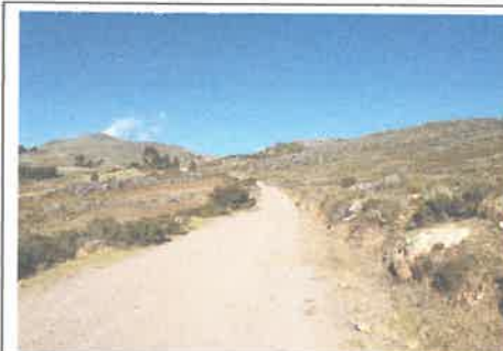
foto 11: KM 1+650 al 1+800 Presencia de encaliminado y bache (4-3).
