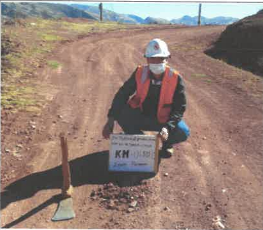
FOTO N° 03: Capa Nivelante degradado por erosión
