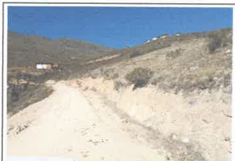
foto 26: KM 6+ 400 al 6+950, Presencia de erosión y bache (2-3).
