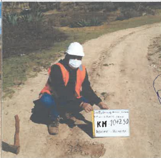
FOTO N° 19: Desgaste de capa de rodadura (afirmado).
