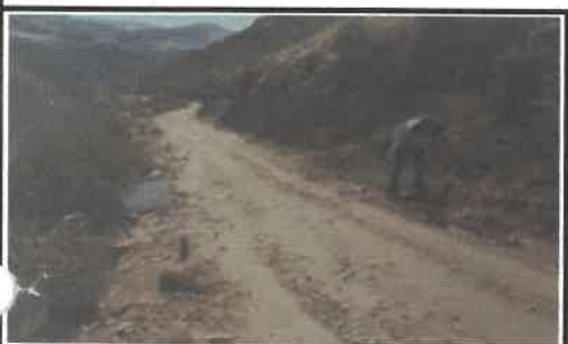
Foto 45: km 13+000 al 13+500, Presencia de erosion y bache (2-3)
