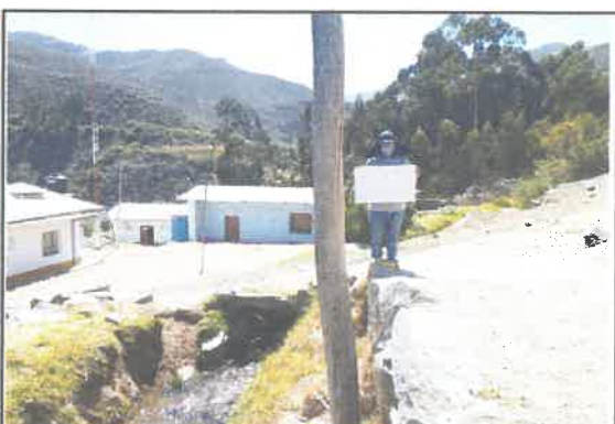
foto 06: Cuneta KM 5+000 al 6+000, Requiere intervencion, necesita descolmatación
