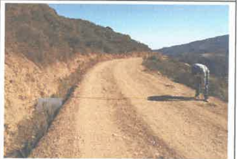
foto 22: KM 5+200 al 5+500, Presencia de encaliminado y bache (4-3).
