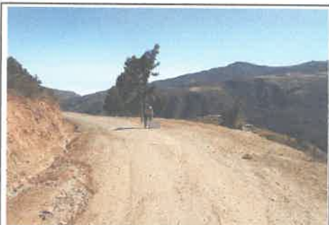
foto 29: KM 7+500 al 7+700, Presencia de erosión y bache (2-3).
