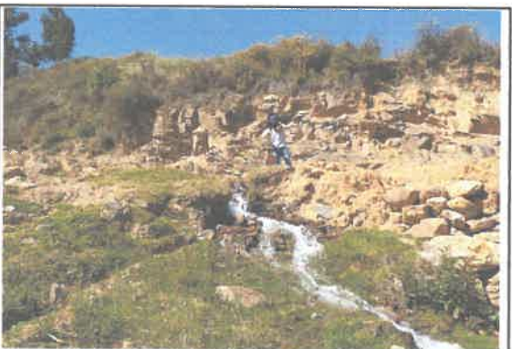
foto 11: KM 06 + 951.57 bajada de agua, necesita remplazar.
