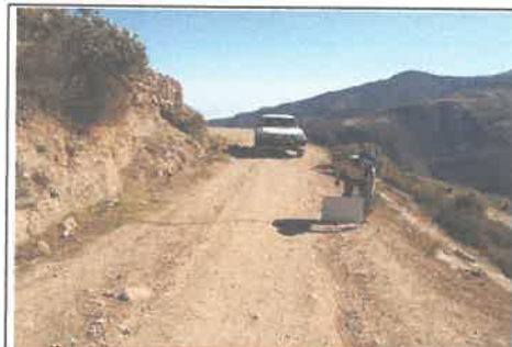
foto 23: KM 5+500 al 5+900, Presencia de encaliminado y bache (4-3).
