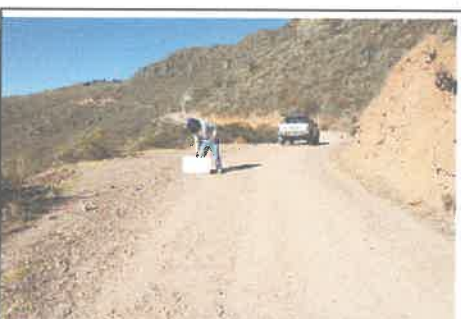
foto 14: KM 2+200 al 2+450, Presencia de encaliminado y bache (4-3).
