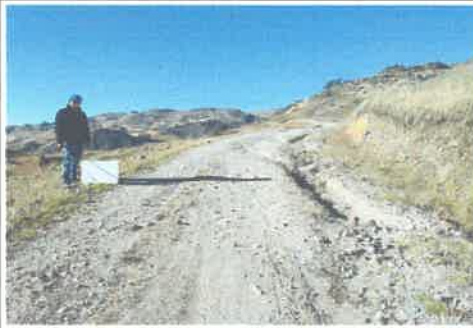
Foto 11: KM 4+000 al 4+500, erosion y baches.
