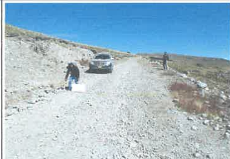
Foto 12: KM 4+500 al 5+500, erosion y baches.
