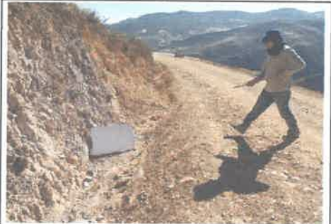
foto 20: KM 4+500 al 5+00, Presencia de encaliminado y bache (4-3).
