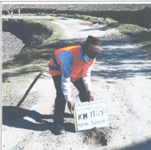
FOTO N° 23: Desgaste de capa de rodadura (afirmado).
