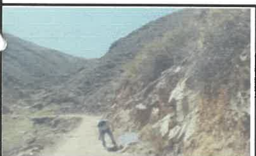
Foto 43: km 12+000 al 12+500, Presencia de erosion y bache (2-3)
