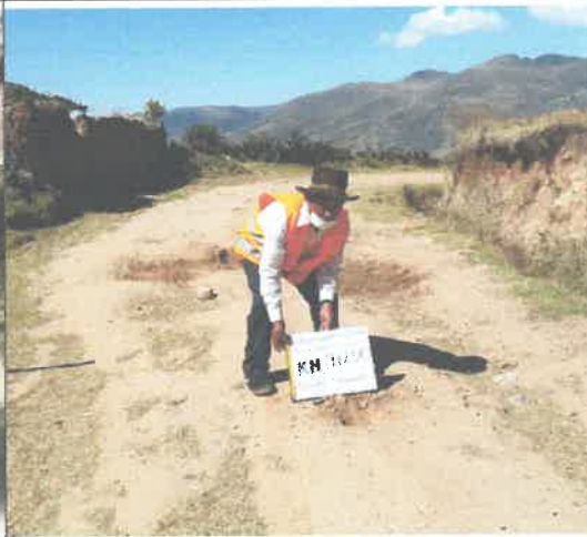
FOTO N° 15: Desgaste de capa de rodadura (afirmado).
