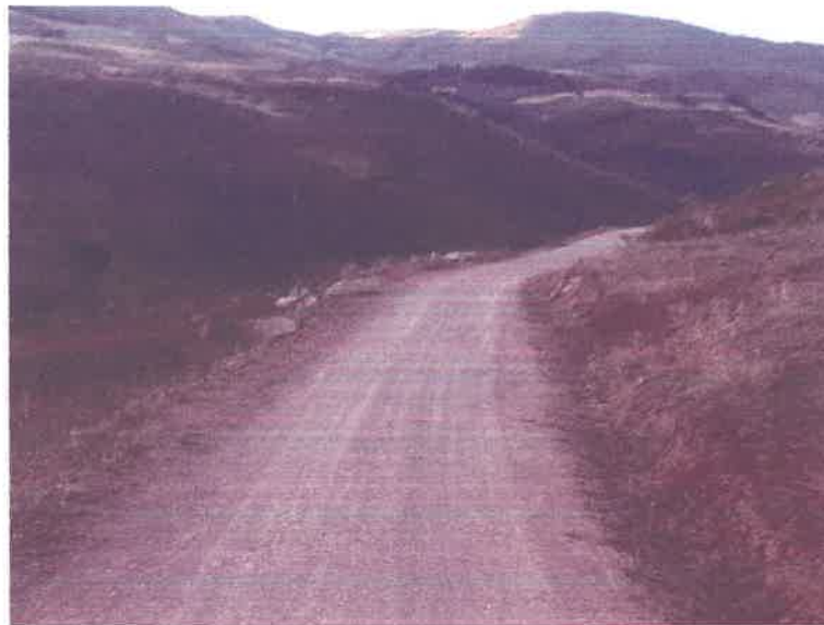
FOTO N° 06 Se puede apreciar el estado de la superficie de rodadura entre el Km 10 + 001- Km 13 + 000
