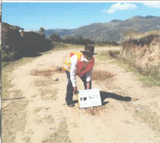
FOTO N° 15: Desgaste de capa de rodadura (afirmado).
