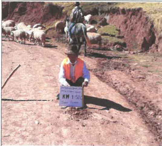
FOTO N° 05: Perdida o Ausencia de Material de afirmado.
