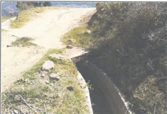
foto 03: Cuneta KM 2+000 al 3+000, necesita limpieza.
