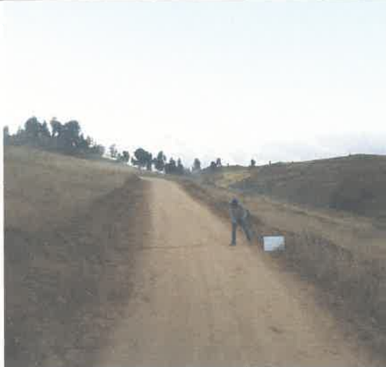
FOTO N° 12: Desgaste de capa de rodadura (afirmado).
