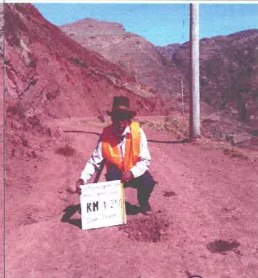
FOTO N° 04: Desgaste de capa de rodadura (afirmado).
