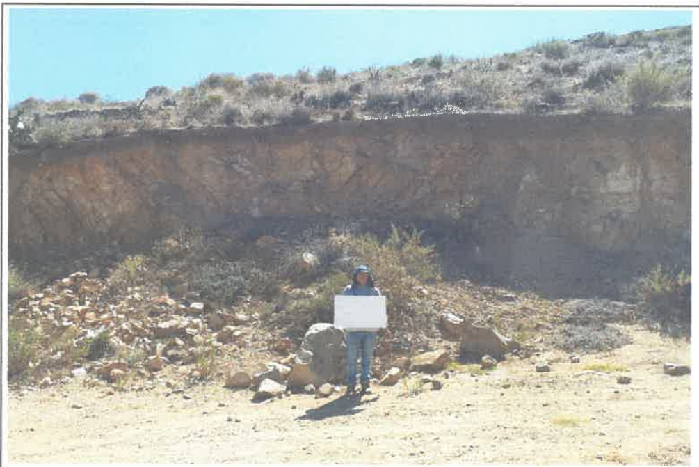
foto 02: KM 10+900 al 11+050, mejorar pendiente de talud
