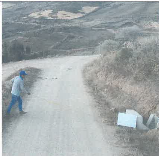
FOTO N° 22: Desgaste de capa de rodadura (afirmado).
