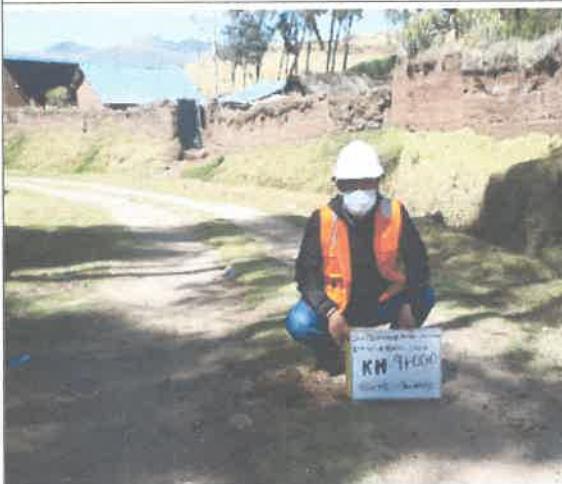
FOTO N° 14: Desgaste de capa de rodadura (afirmado).
