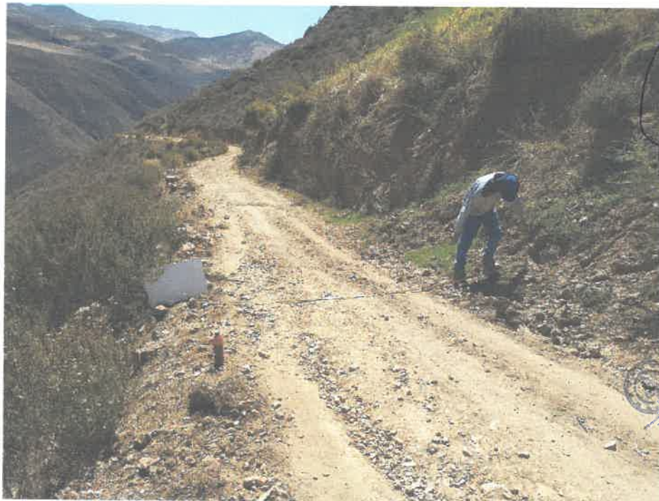
FOTO 04: Problema Mejorar Talud de Corte.
