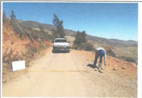
foto 36: KM 10+500 al 11+000, Presencia de erosión y bache (2-3).
