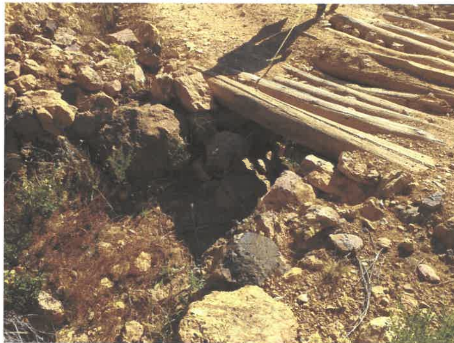
FOTO 02: se recomienda implementar alcantarillas
