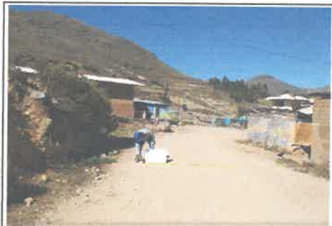
foto 24: KM 5+900 al 6+000, Presencia de erosión y bache (2-3).
