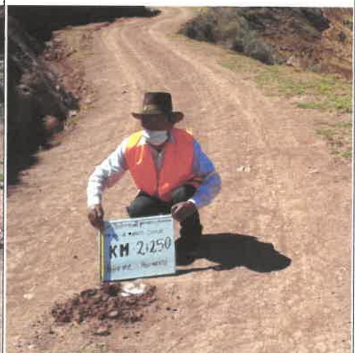
FOTO N° 8: : Perdida o Ausencia de Material de afirmado.
