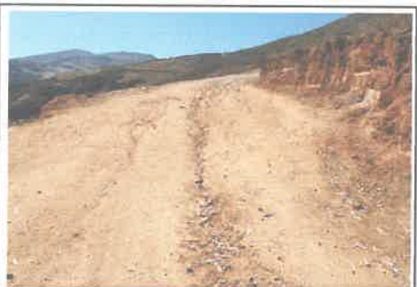
foto 31: KM 7+750 al 8+500, Presencia de erosión y bache (2-3).
