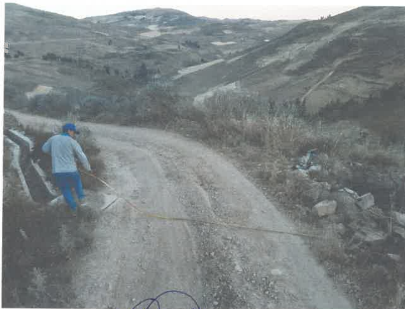
FOTO N° 02 Se puede apreciar el estado de la superficie de rodadura entre el Km 2 + 001- Km 4 + 000
