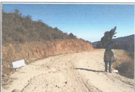
foto 28: KM7+000 al 7+500, Presencia de erosión y bache (2-3).
