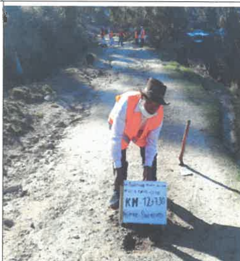
FOTO N° 22: Perdida o Ausencia de Material de afirmado.
