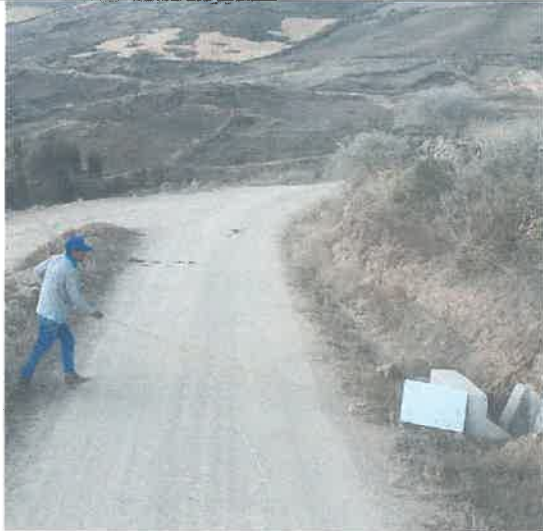
FOTO N° 22: Desgaste de capa de rodadura (afirmado).
