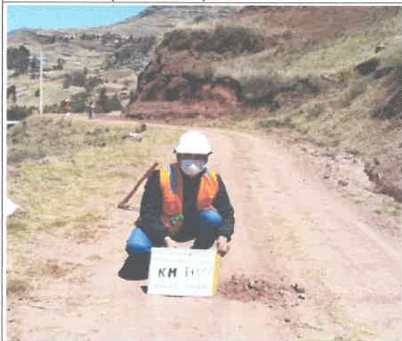
FOTO N° 7 Desgaste de capa de rodadura (afirmado).
