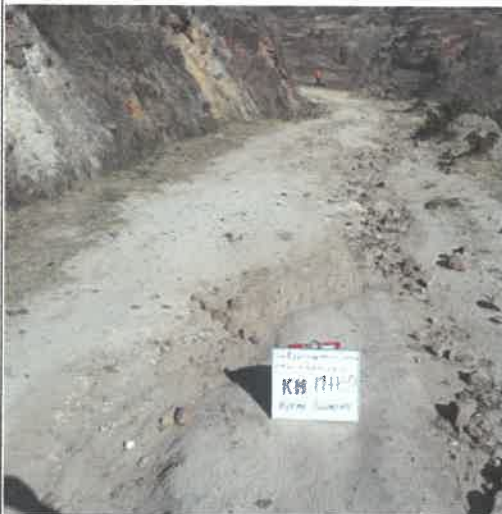
FOTO N° 16: Perdida o Ausencia de Material de afirmado.
