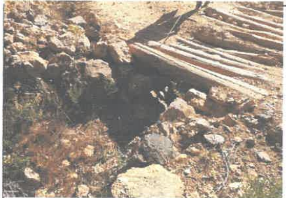
foto 02: Cuneta KM 1+000 AL 2+000, necesita limpieza
