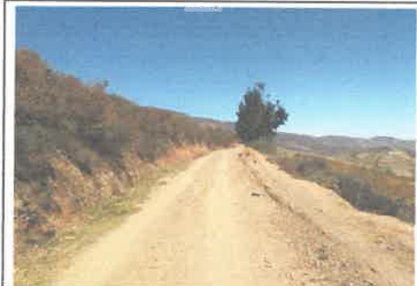
foto 34: KM 9+500 al 10+000, Presencia de erosión y bache (2-3).
