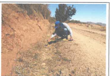
foto 32: KM 8+500 al 9+000, Presencia de erosión y bache (2-3).
