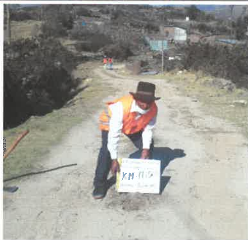
FOTO N° 17: Perdida o Ausencia de Material de afirmado.
