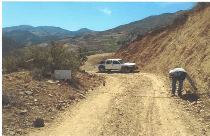
FOTO N° 03: la foto muestra que en la vía no existen hitos kilométricos.
