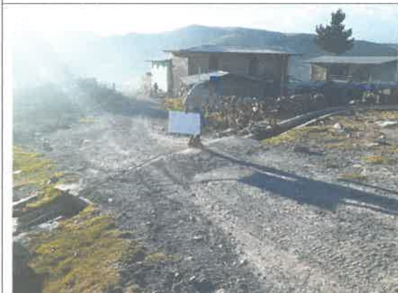
FOTO N° 26: Desgaste de capa de rodadura (afirmado).
