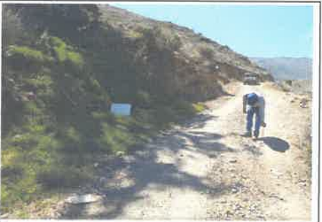
foto 40: KM 11+450 al 11+650, Presencia de erosión y bache (2-3).
