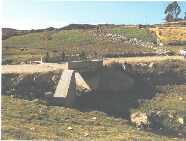
FOTO N° 02. Se requiere intervención o mantenimiento cunetas
