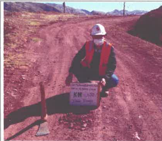
FOTO N° 01: Desgaste de capa de rodadura (afirmado).
