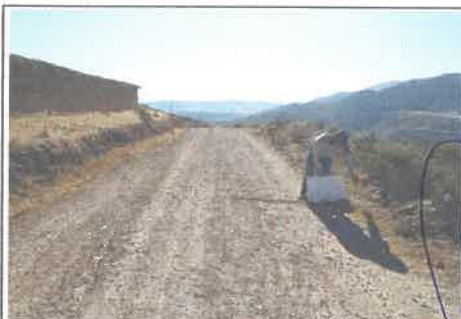
foto 12: KM 1+800 al 1+850, Presencia de encaliminado y bache (4-3).
