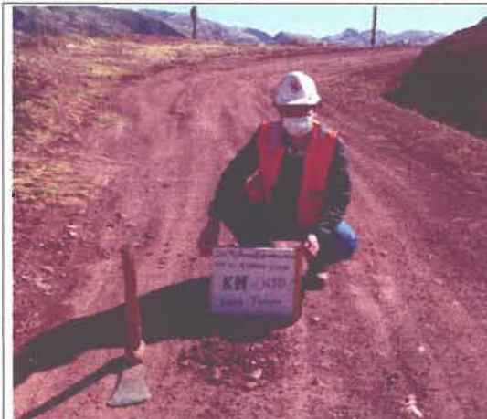
FOTO N° 01: Desgaste de capa de rodadura (afirmado).
