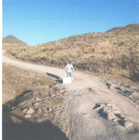
FOTO N° 25: Desgaste de capa de rodadura (afirmado).
