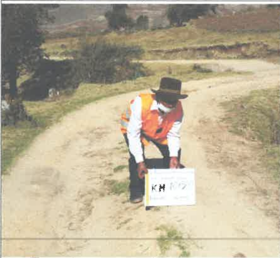
FOTO N° 20: Desgaste de capa de rodadura (afirmado).
