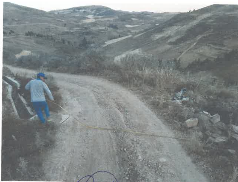
FOTO N° 02 Se puede apreciar el estado de la superficie de rodadura entre el Km 2 + 001- Km 4 + 000
