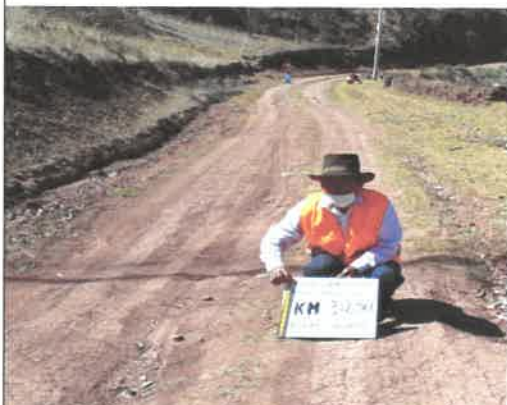
FOTO N° 12 : Perdida o Ausencia de Material de afirmado.
