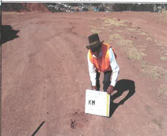
FOTO N° 04: Material de afirmado existente capa de rodadura degradado por erosión.
