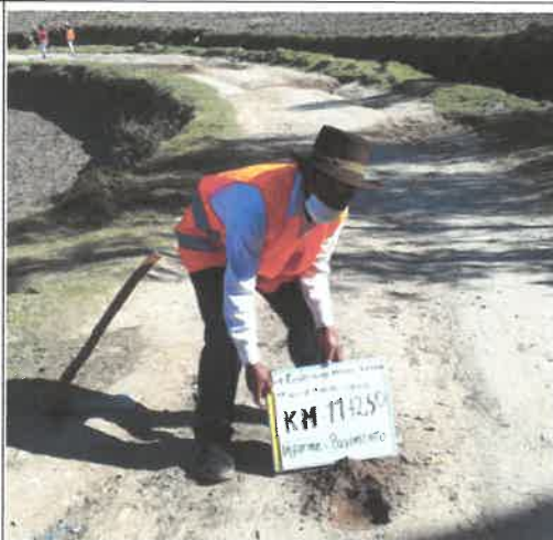
FOTO N° 14: Perdida o Ausencia de Material de afirmado.
