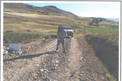
foto 05: KM 0+900 al 1+100, Presencia de encaliminado y bache (4-3).
