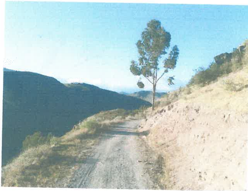
FOTO N° 04 Se puede apreciar el estado de la superficie de rodadura entre el Km 6 + 001- Km 8 + 000
