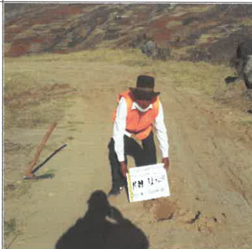
FOTO N° 20: Perdida o Ausencia de Material de afirmado.
