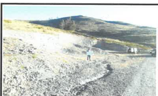
Foto 46: km 13+500 al 14+000, Presencia de erosion y bache (2-3)
