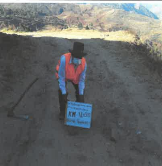
FOTO N° 21: Perdida o Ausencia de Material de afirmado.
