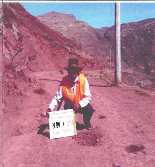
FOTO N° 04: Desgaste de capa de rodadura (afirmado).
