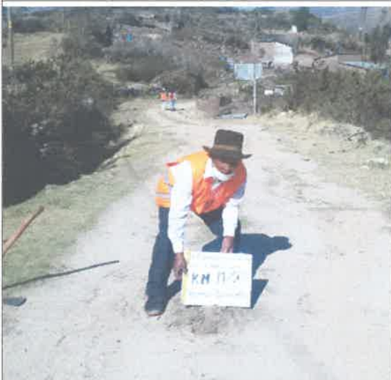
FOTO N° 24: Desgaste de capa de rodadura (afirmado).
