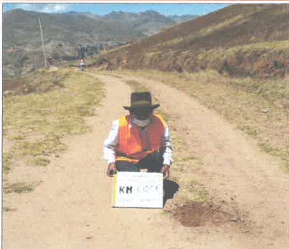
FOTO N° 5: Desgaste de capa de rodadura (afirmado).
