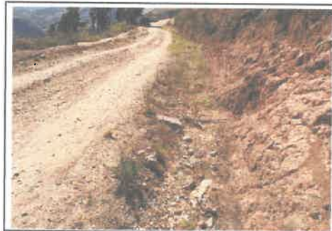
foto 33: KM 9+000 al 9+500, Presencia de erosión y bache (2-3).
