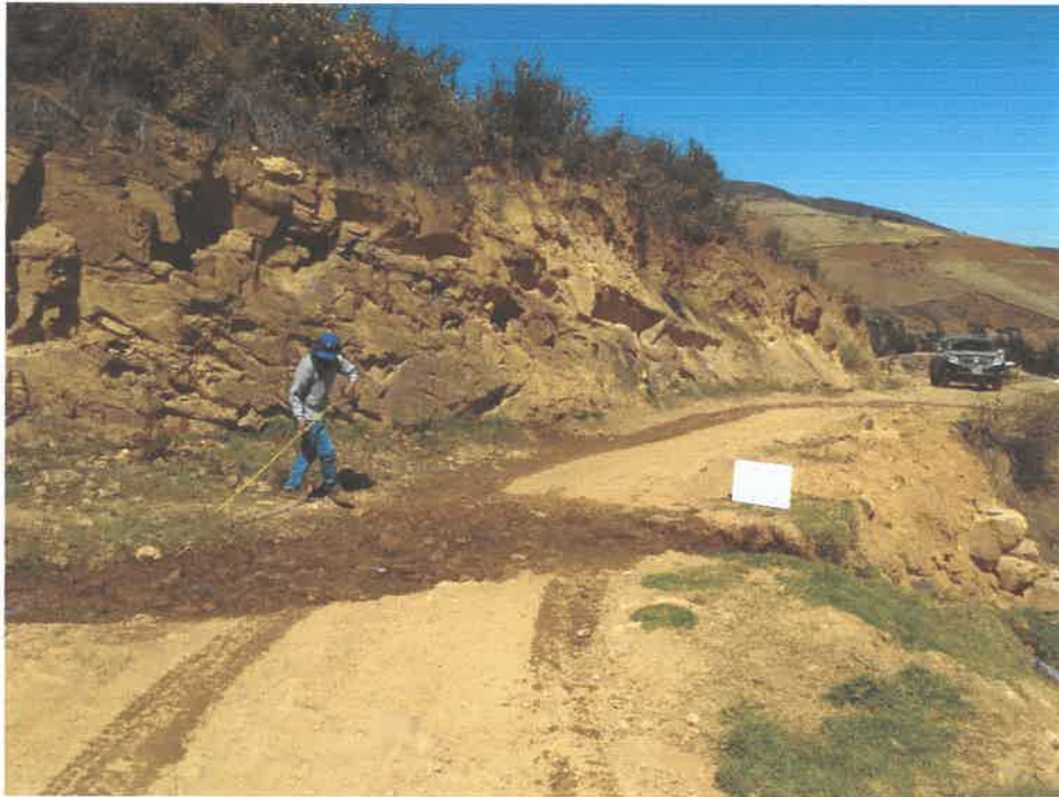
FOTO 03: se recomienda implementar alcantarillas
