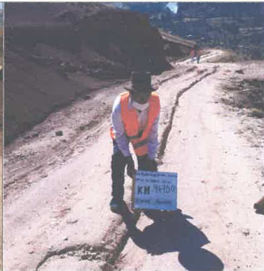
FOTO N° 17: Desgaste de capa de rodadura (afirmado).
