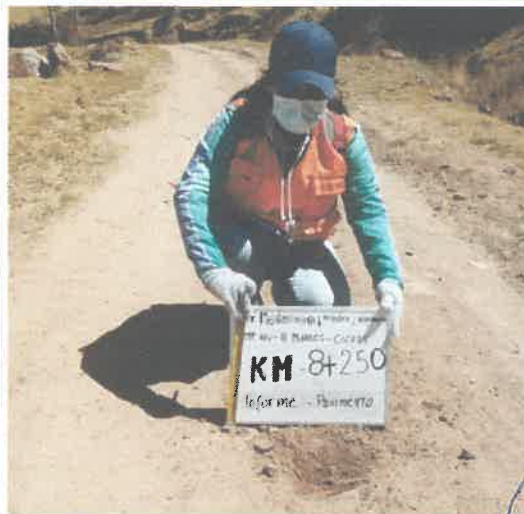
FOTO N° 11: Desgaste de capa de rodadura (afirmado).
