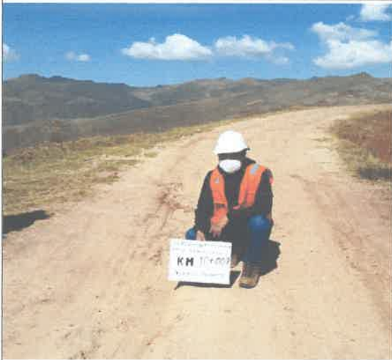
FOTO N° 18: Desgaste de capa de rodadura (afirmado).
