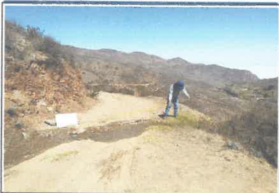
foto 07: KM 6+000 AL 6+951 , Requiere intervencion, necesita descolmatación
