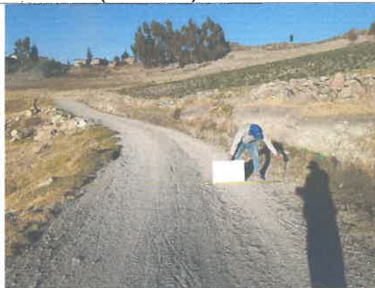
FOTO N° 27: Desgaste de capa de rodadura (afirmado).
