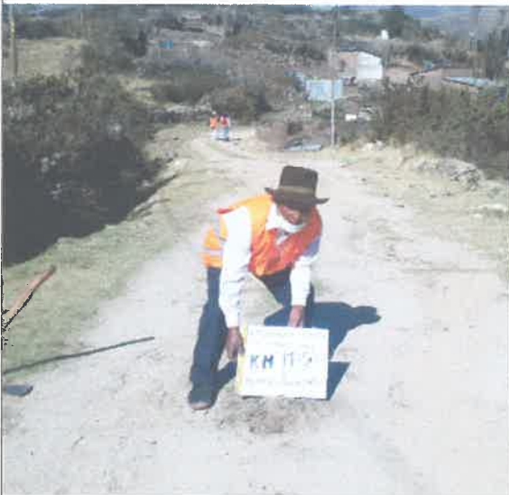
FOTO N° 24: Desgaste de capa de rodadura (afirmado).
