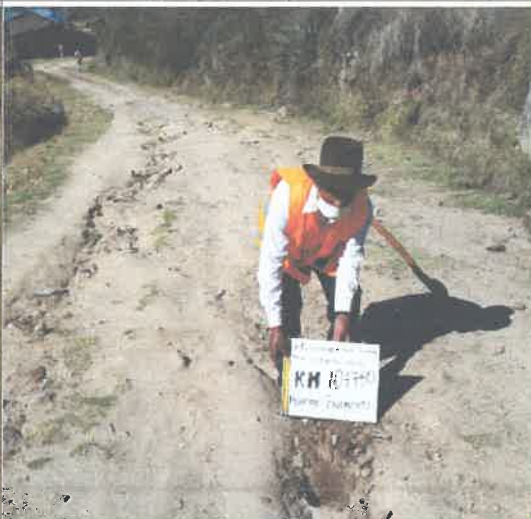
FOTO N° 21: Desgaste de capa de rodadura (afirmado)..
