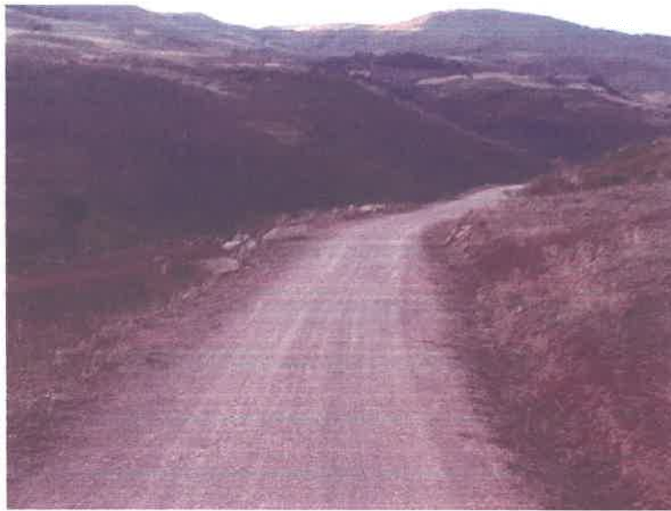
FOTO N° 06 Se puede apreciar el estado de la superficie de rodadura entre el Km 10 + 001- Km 13 + 000
