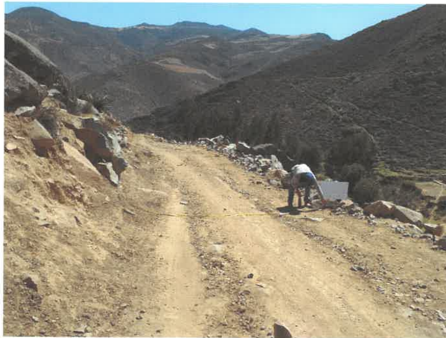
FOTO N° 06 Se puede apreciar el estado de la superficie de rodadura entre el Km 10 + 001- Km 12 + 000
