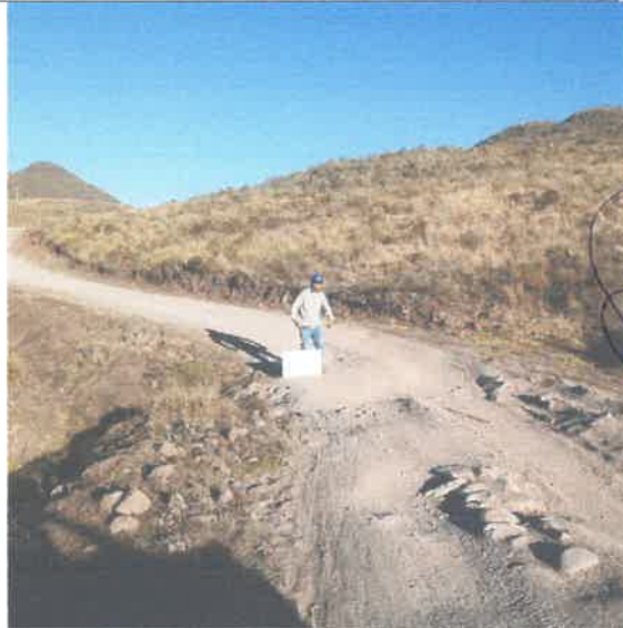
FOTO N° 25: Desgaste de capa de rodadura (afirmado).
