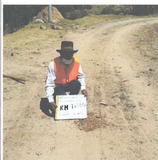
FOTO N° 10: Desgaste de capa de rodadura (afirmado).
