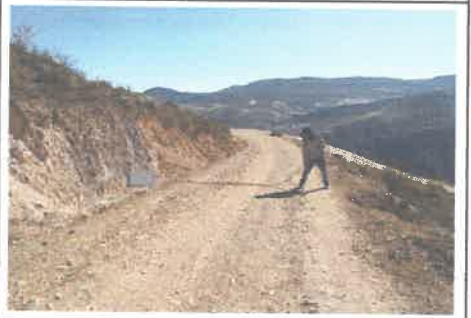
foto 21: KM 5+000 al 5+200, Presencia de encaliminado y bache (4-3).
