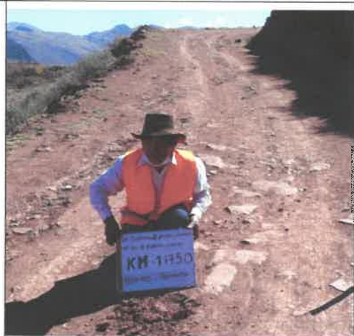
FOTO N° 06 : Perdida o Ausencia de Material de afirmado.
