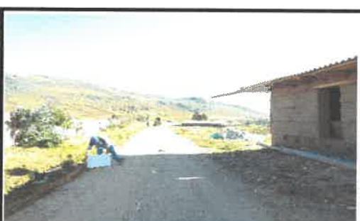
Foto 48: km 14+500 al 15+000, Presencia de erosion y bache (2-3)
