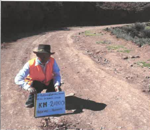
FOTO N° 07: Perdida o Ausencia de Material de afirmado.
