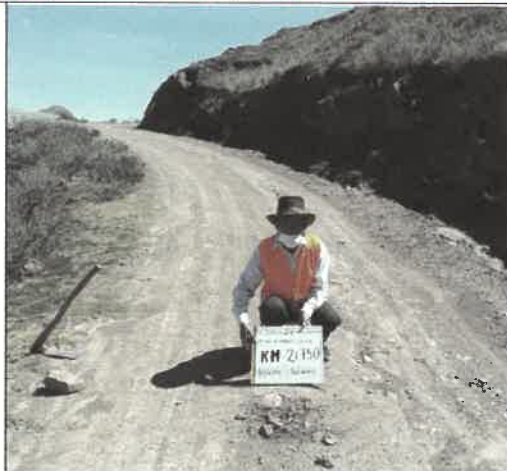
FOTO N° 10 : Perdida o Ausencia de Material de afirmado.
