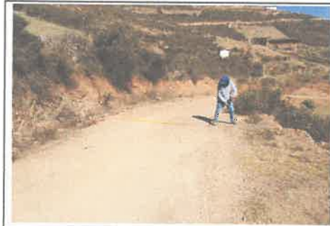
foto 25: KM 6+000 al 6+400, Presencia de lodasal (5).
