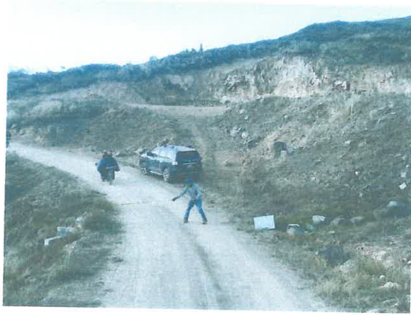
FOTO N° 03 Se puede apreciar el estado de la superficie de rodadura entre el Km 4 + 000- Km 6 + 000
