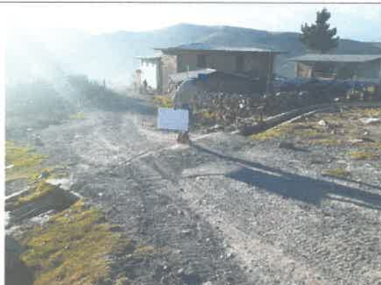
FOTO N° 26: Desgaste de capa de rodadura (afirmado).
