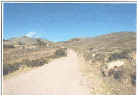
foto 10: KM 01 + 600 al 1+650 Presencia de encaliminado y bache (4-3).
