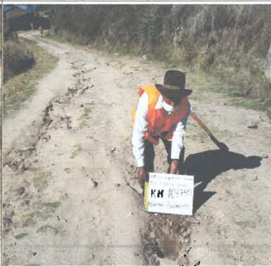
FOTO N° 21: Desgaste de capa de rodadura (afirmado)..
