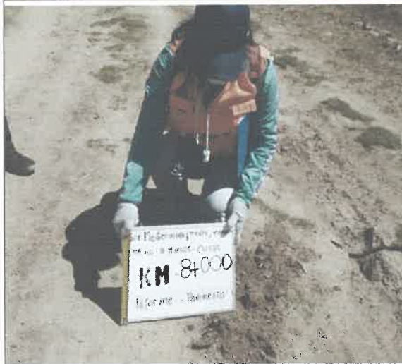
FOTO N° 10: Desgaste de capa de rodadura (afirmado).
