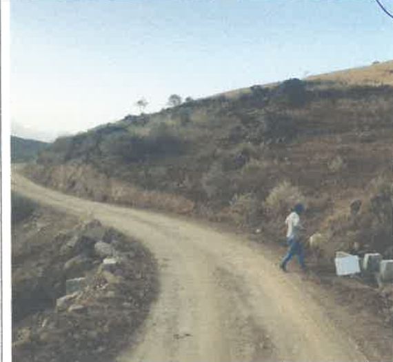
FOTO N° 13: Desgaste de capa de rodadura (afirmado).
