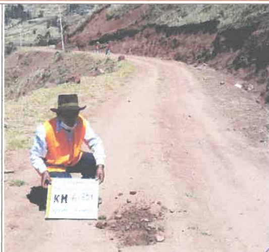
FOTO N° 6 Desgaste de capa de rodadura (afirmado).
