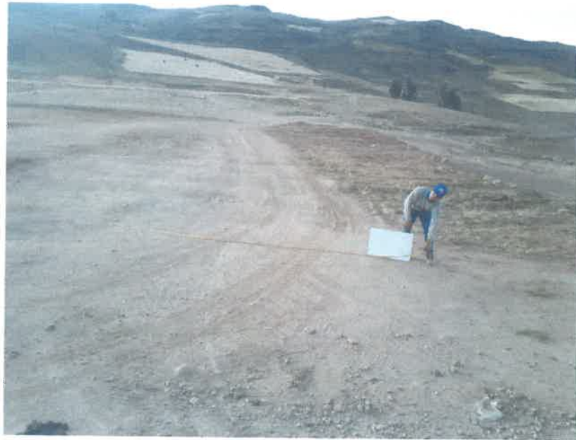
FOTO N° 01 Se puede apreciar el estado de la superficie de rodadura entre el Km 00+000 - Km 02 +000
