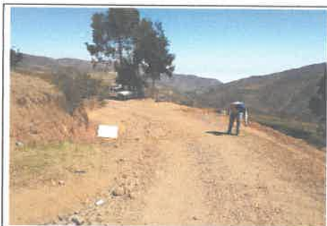
foto 35: KM 10+000 al 10+500, Presencia de erosión y bache (2-3).
