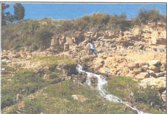
foto 05: Cuneta KM 4+000 al 5+000, Requiere intervencion, necesita descolmatación
