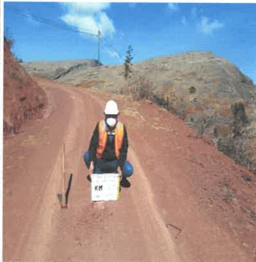
FOTO N° 02 : Perdida de Material de afirmado por erosión.
