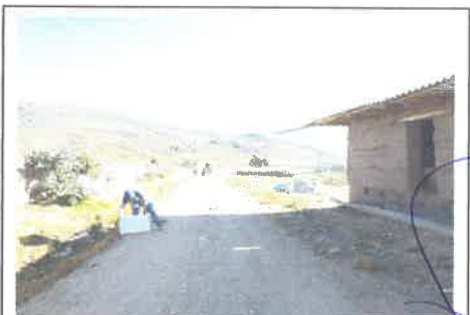
Foto 04: KM 850 al 0+900, Presencia de encaliminado y bache (4-3).
