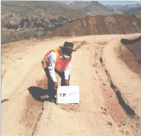
FOTO N° 16: Desgaste de capa de rodadura (afirmado).
