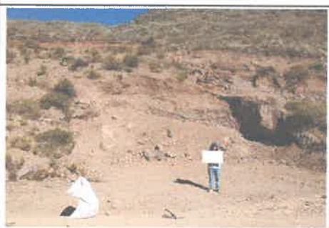
foto 16: KM 2+700 al 3+200, Presencia de encaliminado y bache (4-3).
