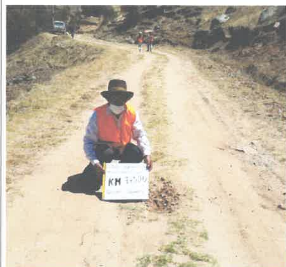
FOTO N° 9: Desgaste de capa de rodadura (afirmado).
