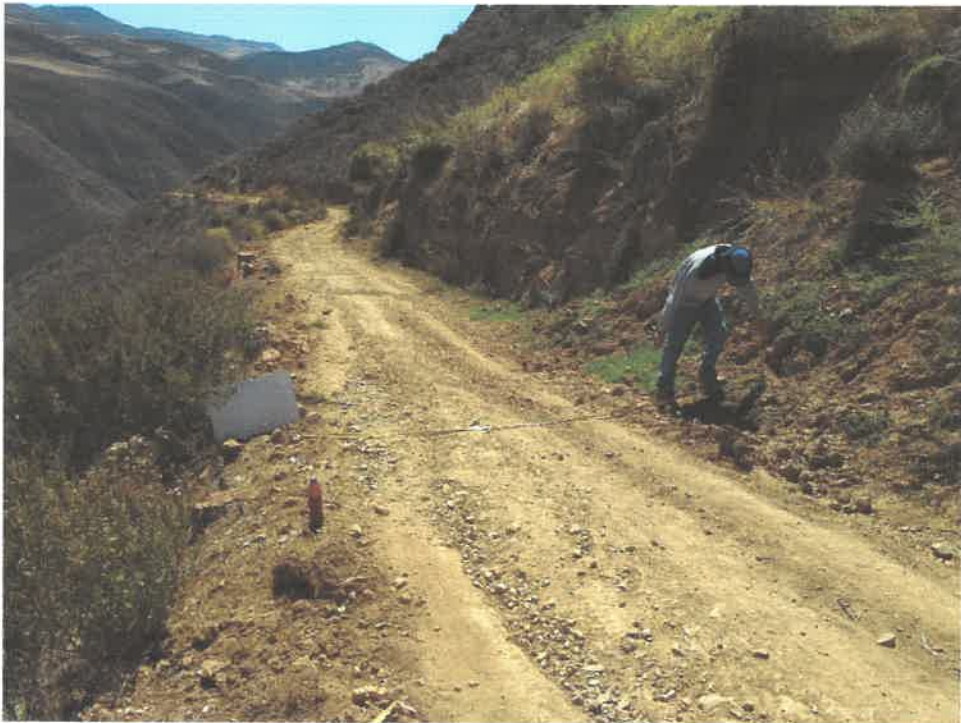
FOTO 04: se recomienda implementar alcantarillas
