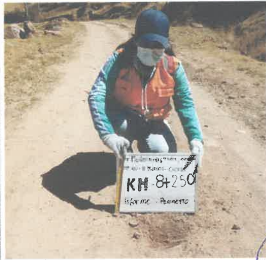
FOTO N° 11: Desgaste de capa de rodadura (afirmado).
