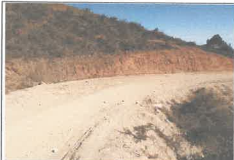
foto 27: KM 6+950 al 7+000, Presencia de erosión y bache (2-3).
