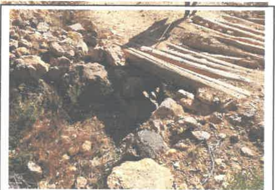
foto 08: Alcantarilla KM 02 + 763 se requiere remplazar.
