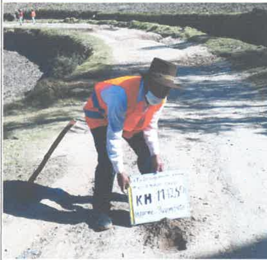
FOTO N° 23: Desgaste de capa de rodadura (afirmado).
