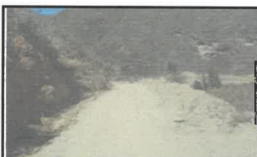
Foto 44: km 12+500 al 13+000, Presencia de erosion y bache (2-3)
