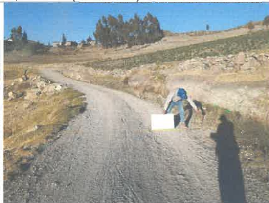
FOTO N° 27: Desgaste de capa de rodadura (afirmado).
