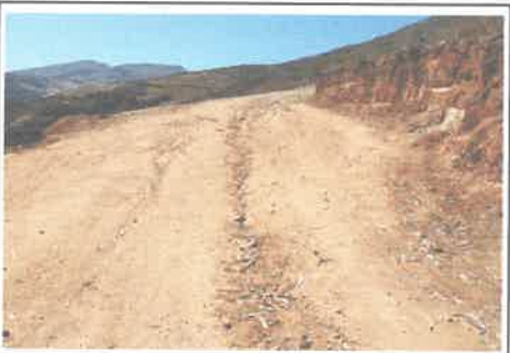
foto 38: KM 11+050 al 11+400, Presencia de erosión y bache (2-3).
