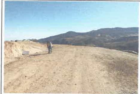
foto 18: KM 3+600 al 4+000, Presencia de encaliminado y bache (4-3).
