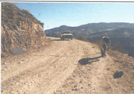
foto 15: KM 2+450 al 2+700, Presencia de encaliminado y bache (4-3).
