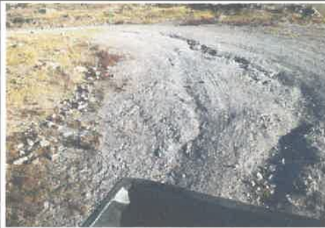
Foto 09: KM 3+000 al 3+500, erosion y baches.
