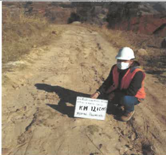
FOTO N° 19: Perdida o Ausencia de Material de afirmado.
