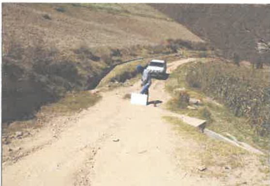
Foto 04: Cuneta KM 3+000 al 4+000, necesita limpieza.
