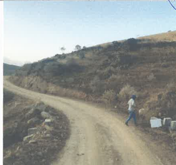
FOTO N° 13: Desgaste de capa de rodadura (afirmado).
