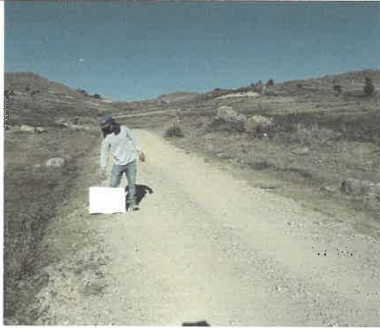
FOTO N° 9 : Perdida o Ausencia de Material de afirmado.
